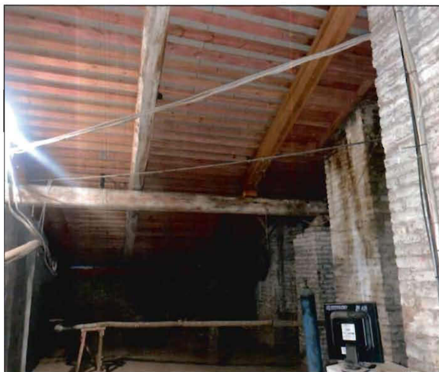
22. Стропильная система лицевого корпуса (со стороны пл. Ломоносова и ул. Зодчего Росси). Фото от 16.11.2021 г.
