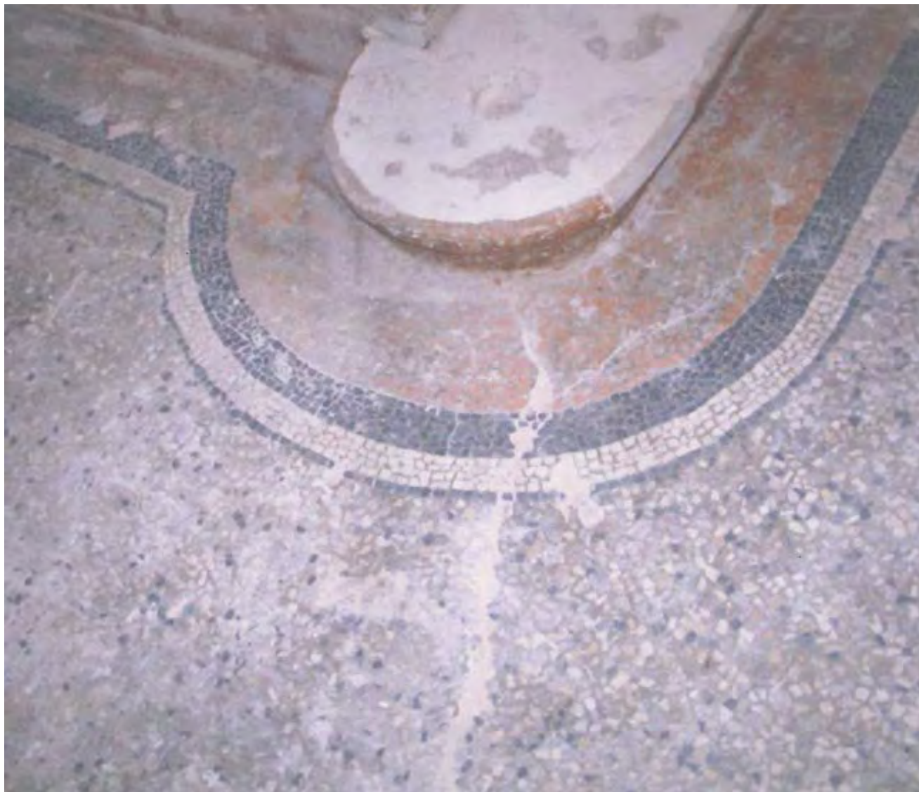
90. Рисунок мозаичного пола вестибюля 1 этажа. Фрагмент пола вдоль нижней ступени. 2005 г. // ООО «ЛСО РЕСТАВРАТОР». Рисунки мозаичных полов парадной лестницы по адресу: СПб., ул. Бакунина, д. 8 (по факту). СПб., 2005. С. 9. / КГИОП. 15006/Пр. 82.
