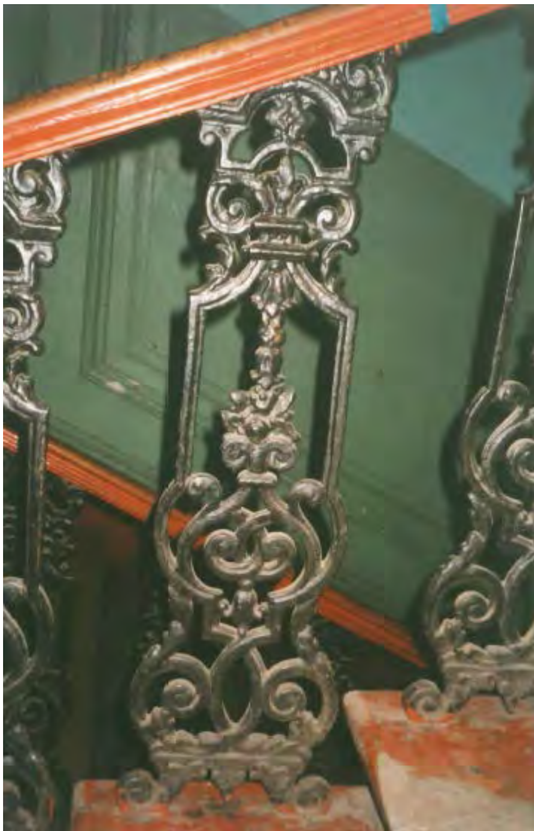
79. Общий вид литого модуля заполнения ограждения парадной лестницы. 2002 г. // ООО «Капитал-Строй». Проект реконструкции учебного корпуса детского дома-школы № 51. Том 1. Книга 1. Часть 1. Альбом фотоиллюстраций № 1. Дефекты и общие виды фасадов здания. СПб., 2002. С. 21. / КГИОП. П. 1500Б/Пр. 79.
