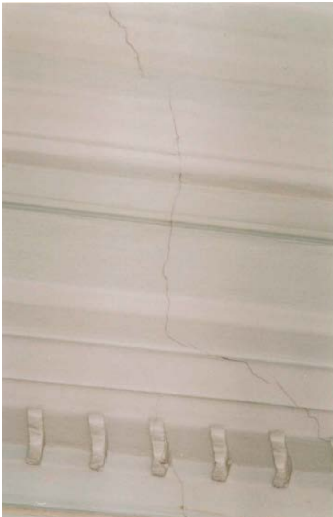
76. Фрагмент штукатурно-лепного декора фойе. 2002 г. // ООО «Капитал-Строй». Проект реконструкции учебного корпуса детского дома-школы № 51. Том 1. Книга 1. Часть 1. Альбом фотоиллюстраций № 1. Дефекты и общие виды фасадов здания. СПб., 2002. С. 13. / КГИОП. П. 1500Б/Пр. 79.
