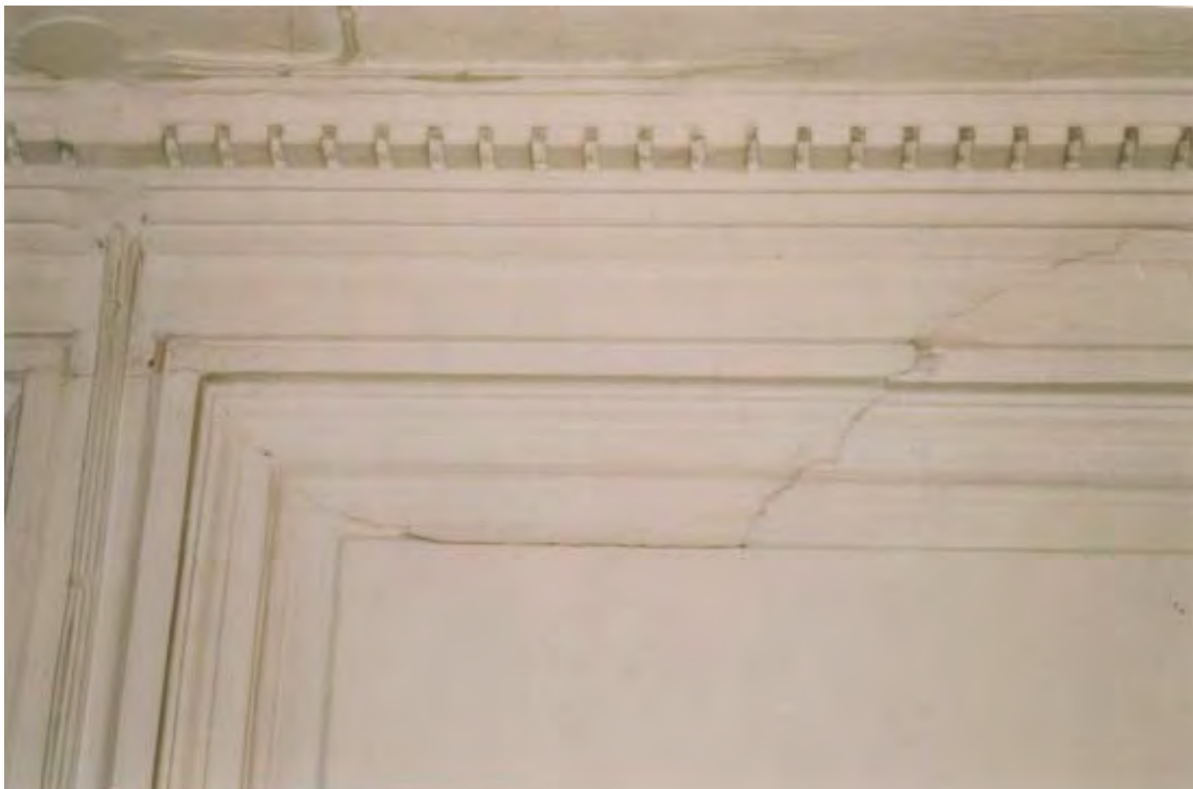
81. Фрагмент штукатурно-лепного декора парадной лестницы. 2002 г. // ООО «Капитал-Строй». Проект реконструкции учебного корпуса детского дома-школы № 51. Том 1. Книга 1. Часть 1. Альбом фотоиллюстраций № 1. Дефекты и общие виды фасадов здания. СПб., 2002. С. 26. / КГИОП. П. 1500Б/Пр. 79.
