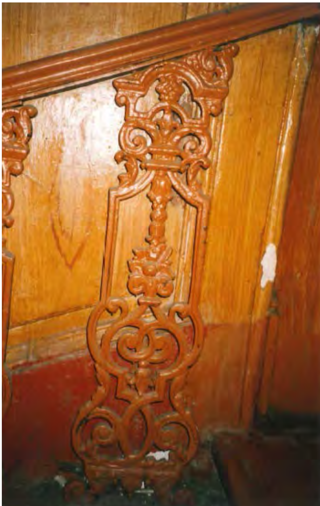
74. Общий вид модуля декоративного заполнения перильного ограждения лестничного марша в фойе. 2002 г. // ООО «Капитал-Строй». Проект реконструкции учебного корпуса детского дома-школы № 51. Том 1. Книга 1. Часть 1. Альбом фотоиллюстраций № 1. Дефекты и общие виды фасадов здания. СПб., 2002. С. 10. / КГИОП. П. 1500Б/Пр. 79.
