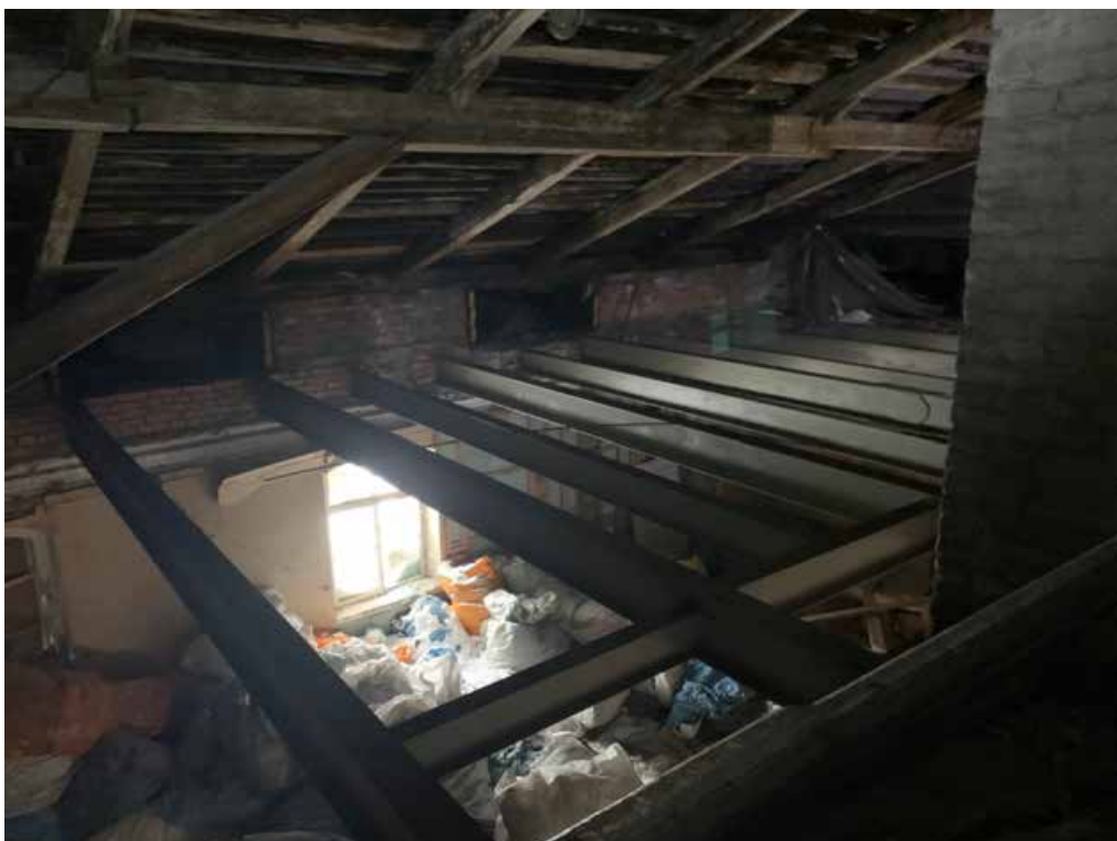
Фото 17. Общий вид на конструкцию междуэтажного перекрытия. Наблюдается отсутствие междуэтажного заполнения.
