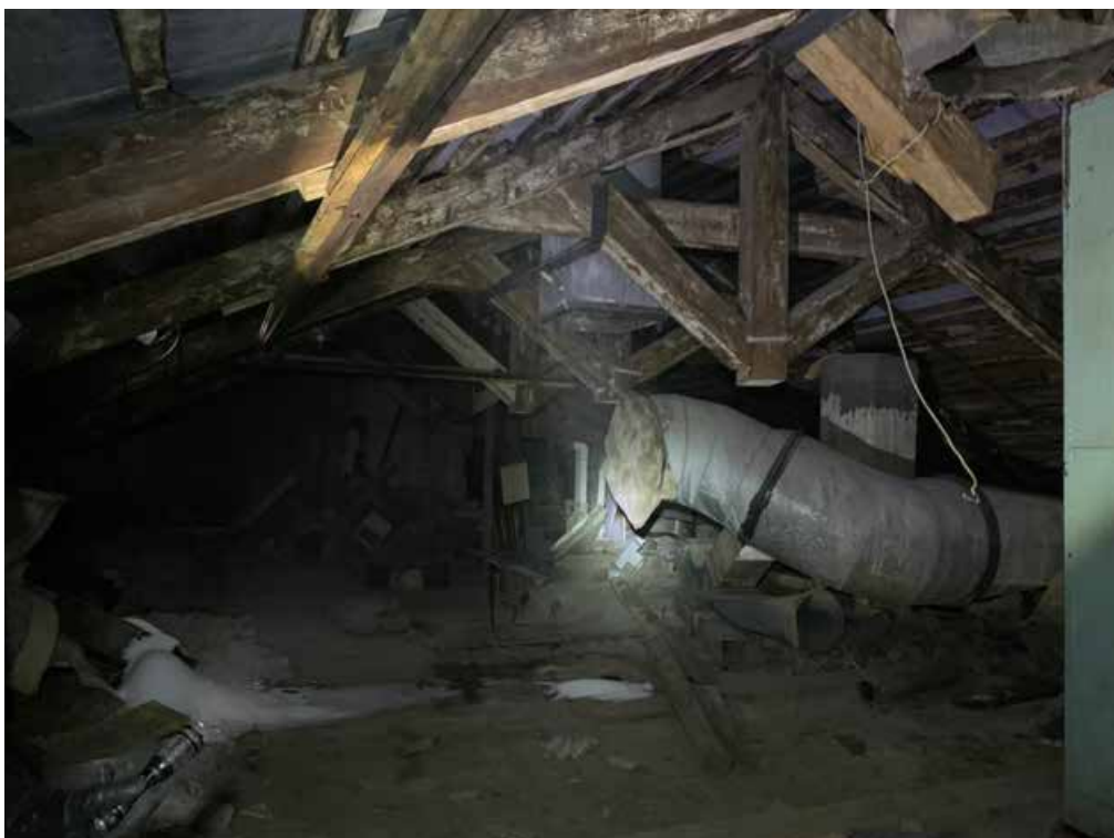
Фото 6. Общий вид на деревянную конструкцию, висячую стойку и подкосы. Наблюдаются следы замачивания.
