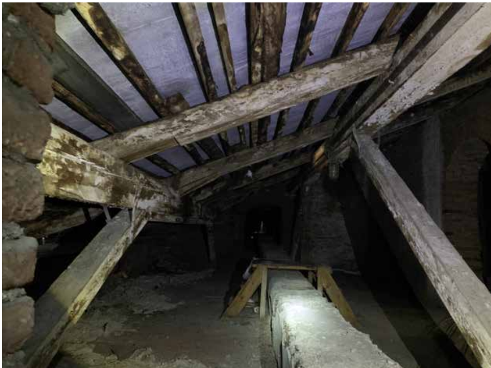
Фото 33. Поздние вентиляционные каналы, подкосы, захламление чердака
