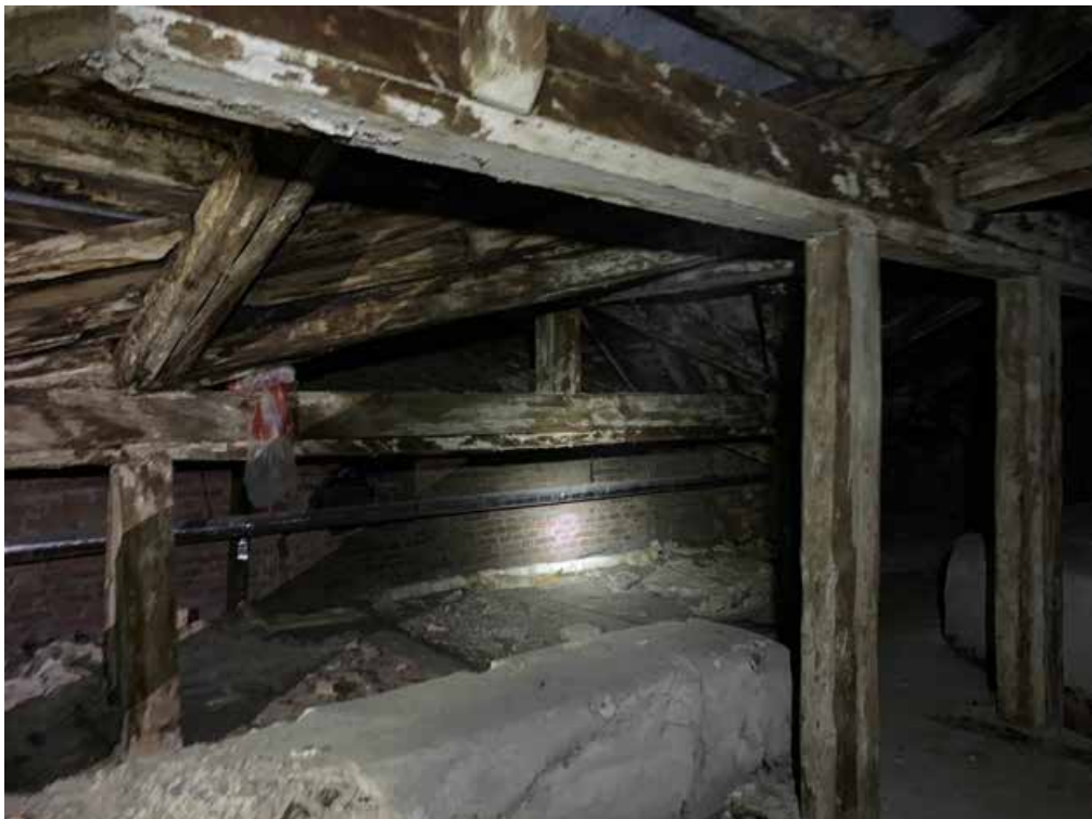
Фото 25. Замачивание конструкций кровли. Поздние вентиляционные каналы над чердачным перекрытием.
