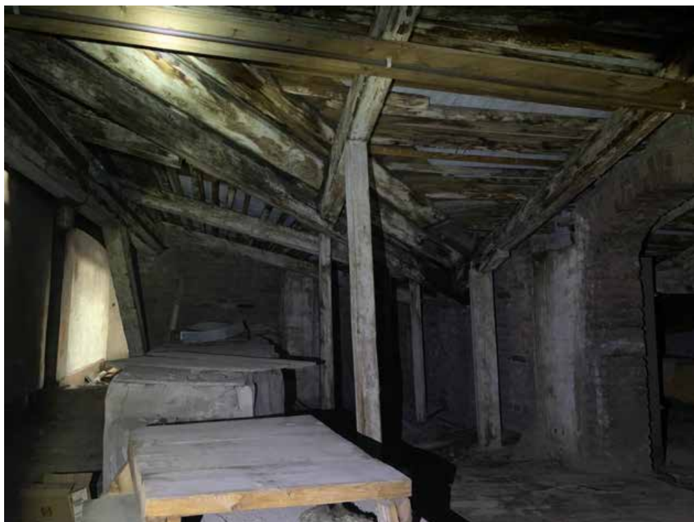
Фото 21. Конструкции кровли, высокий износ замачивание обрешетки
