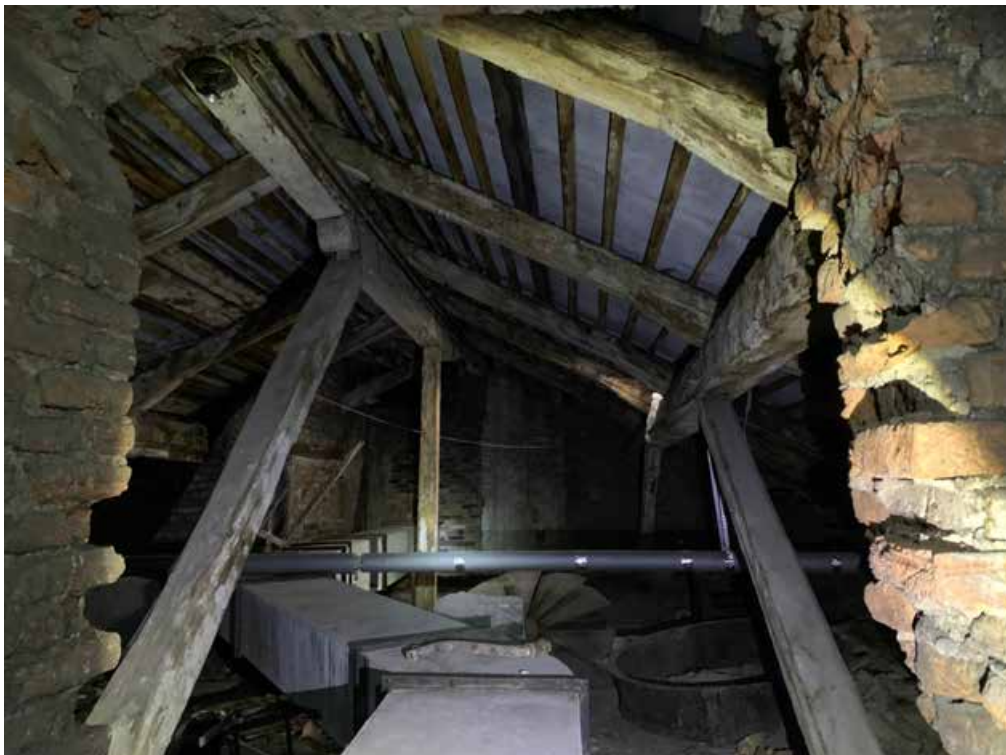
Фото 29. Поздние вентиляционные каналы, подкосы, захламление чердака
