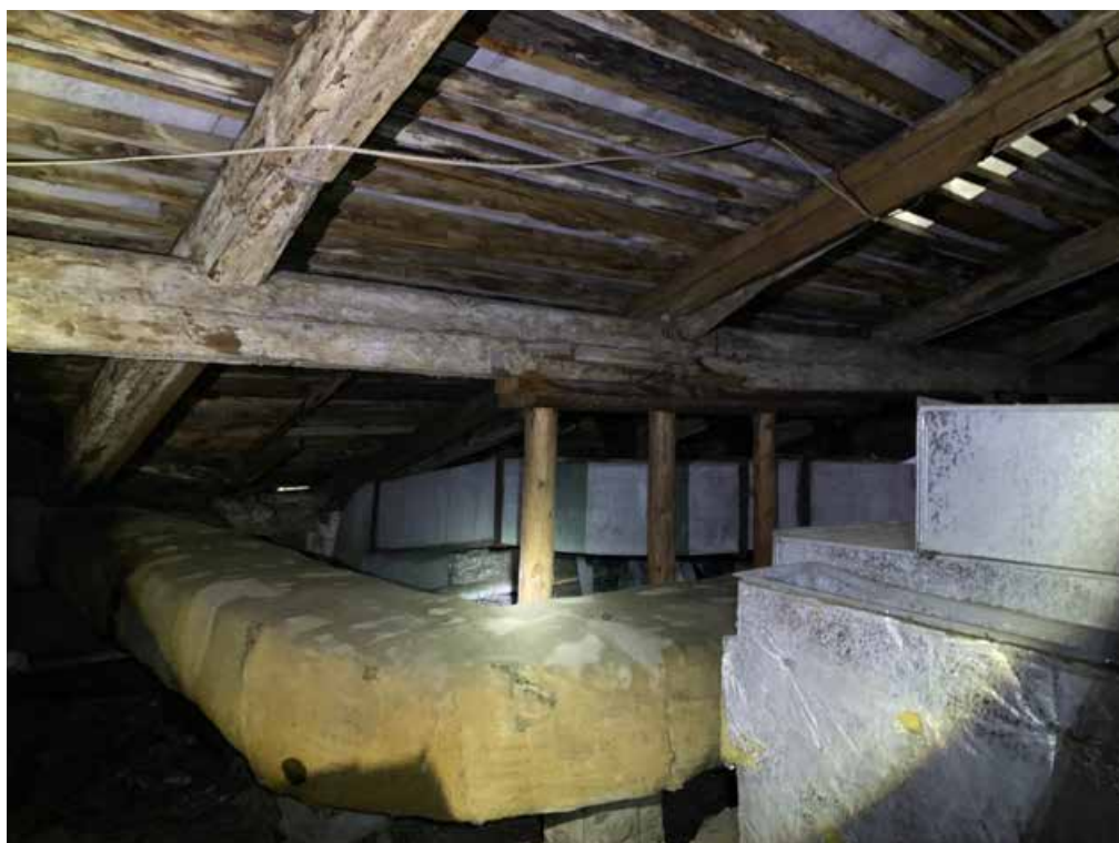
Фото 21. Поздние стойки усиления, высокий износ замачивание обрешетки
