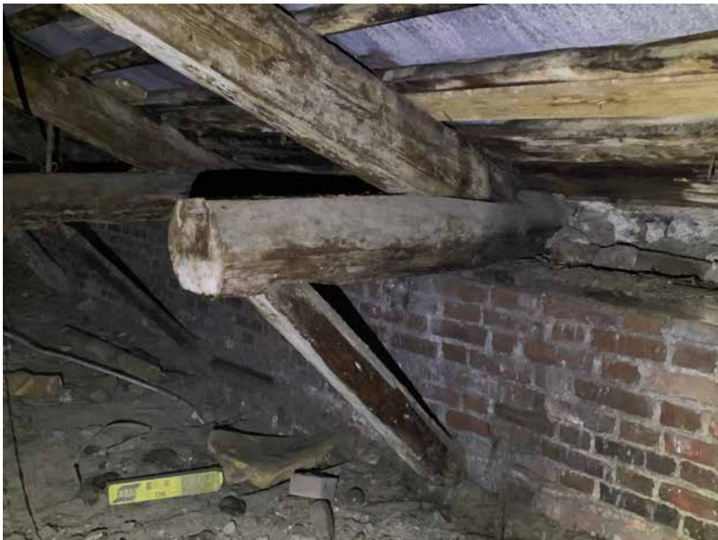
Фото 5. Фрагмент узла опирания стропильной ноги на наружную стену. Наблюдается деградация древесины, следы замачивания.
