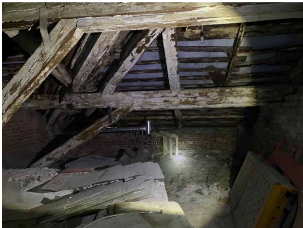
Фото 22. Замачивание конструкции кровли
