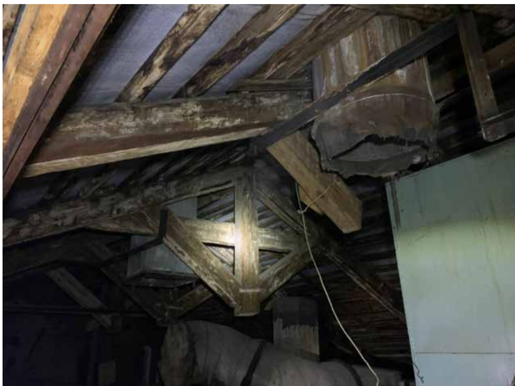
Фото 7. Фрагмент висячей стойки. Наблюдается деструкция древесины, следы замачивания.
