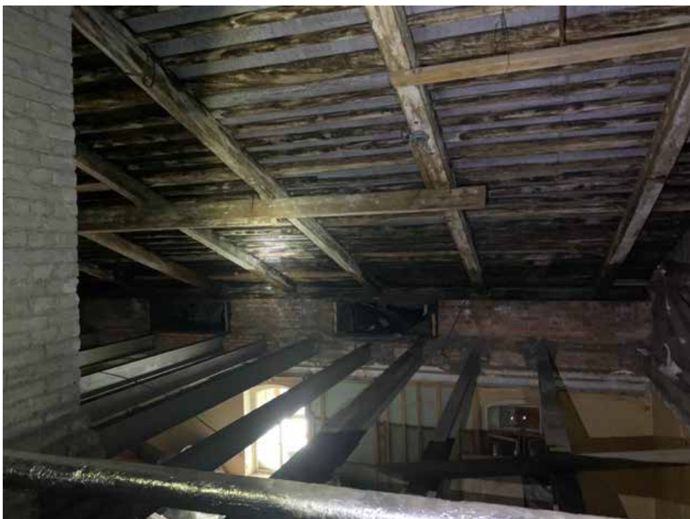
Фото 18. Фрагмент конструкции междуэтажного перекрытия. Наблюдается отсутствие междуэтажного заполнения, деструкция древесины, следы замачивания.
