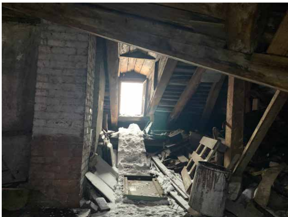
Фото 20. Выход на кровлю, захламление чердака.
