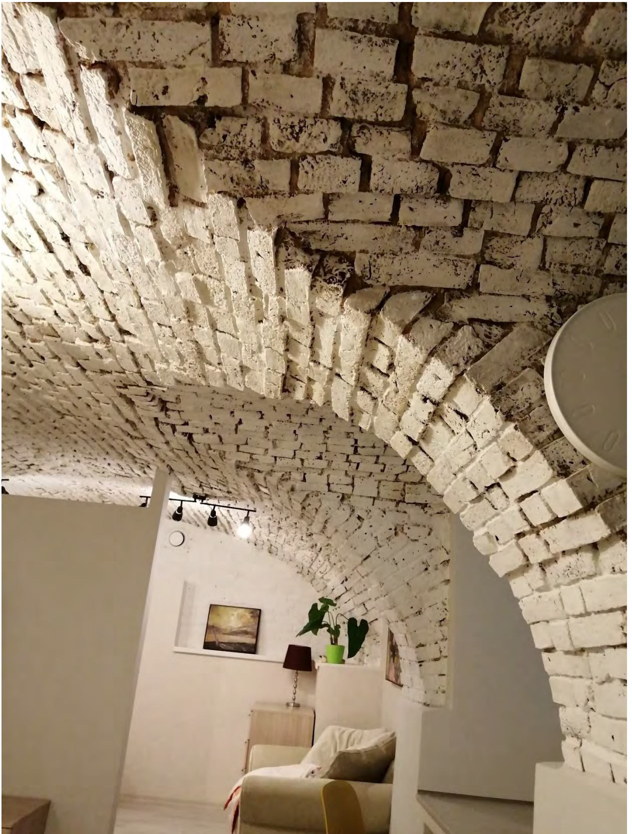
Фото 3. Объект культурного наследия регионального значения "Дом А. Сверчкова (Кушелевой)", расположенный в Санкт-Петербурге, 1-я линия В.О., дом 14, литера А. Помещение 1-Н (3). Коренные коробовые своды с распалубками в цокольном этаже.
