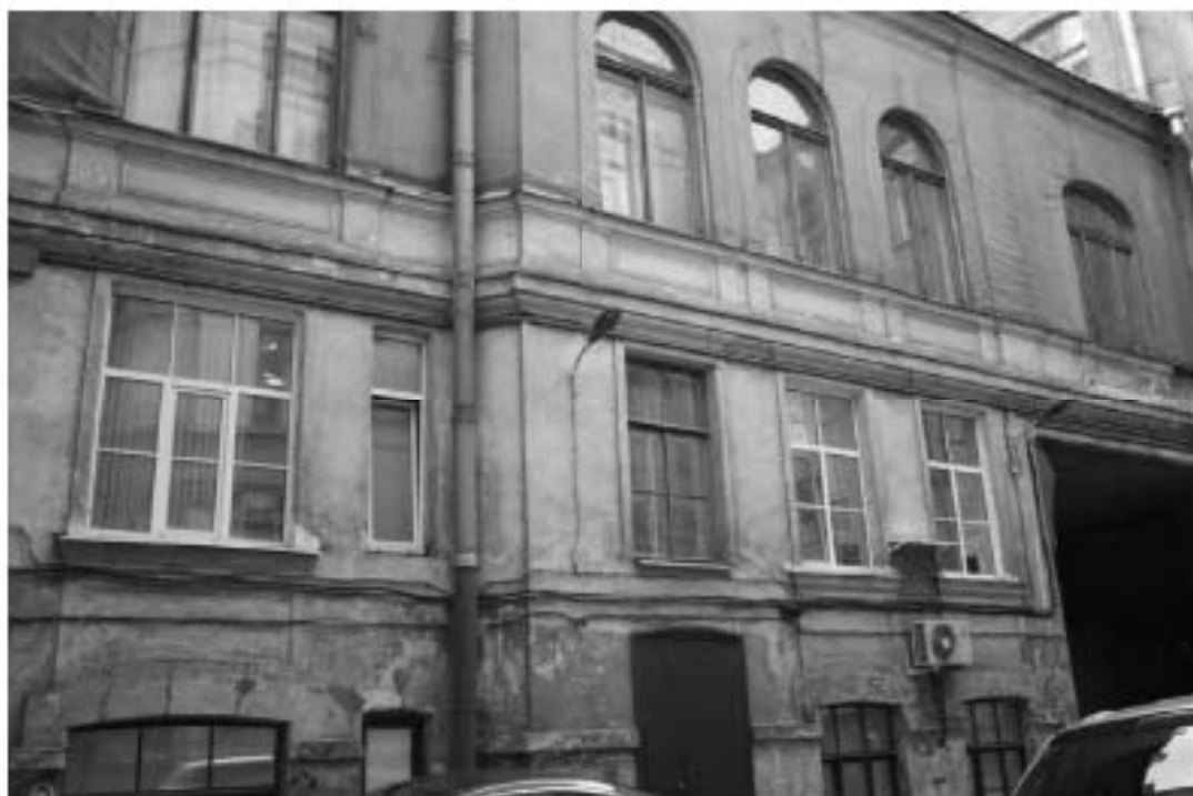
18. «Особняк Безобразовой». Санкт-Петербург, Моховая ул., 34, литера А (Моховая ул., 34). Центральный внутренний двор. Вид с севера на юг. Фото: 21.09.2022.
