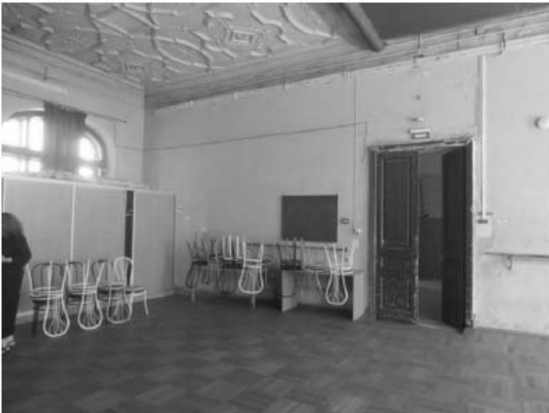
34. «Особняк Безобразовой». Санкт-Петербург, Моховая ул., 34, литера А (Моховая ул., 34). Лицевой корпус. 1-й этаж. Фрагмент помещения 10-Н(20). Фото: 21.09.2022.
