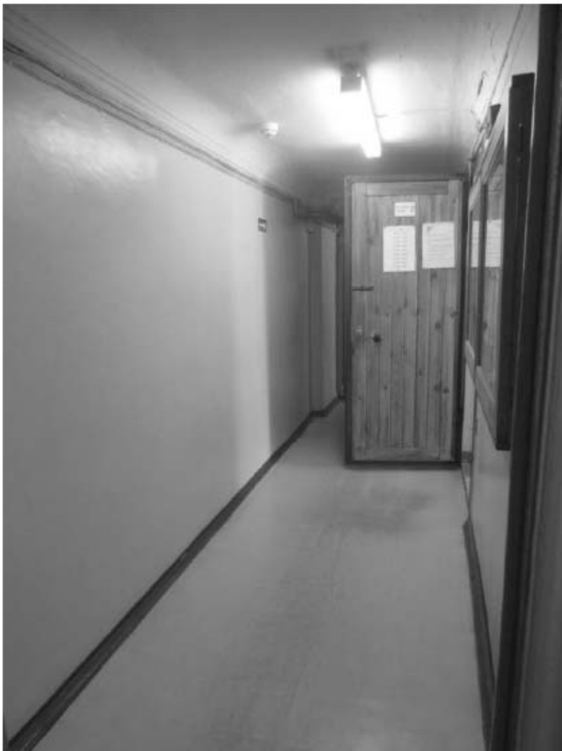
114. «Особняк Безобразовой». Санкт-Петербург, Моховая ул., 34, литера А (Моховая ул., 34). Лицевой корпус. 2-й этаж. Фрагмент помещения 15-Н(11). Фото: 21.09.2022.
