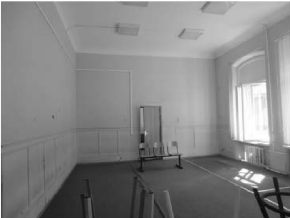
145. «Особняк Безобразовой». Санкт-Петербург, Моховая ул., 34, литера А (Моховая ул., 34). Дворовый корпус. 3-й этаж. Фрагмент помещения 21-Н(22). Фото: 21.09.2022.
