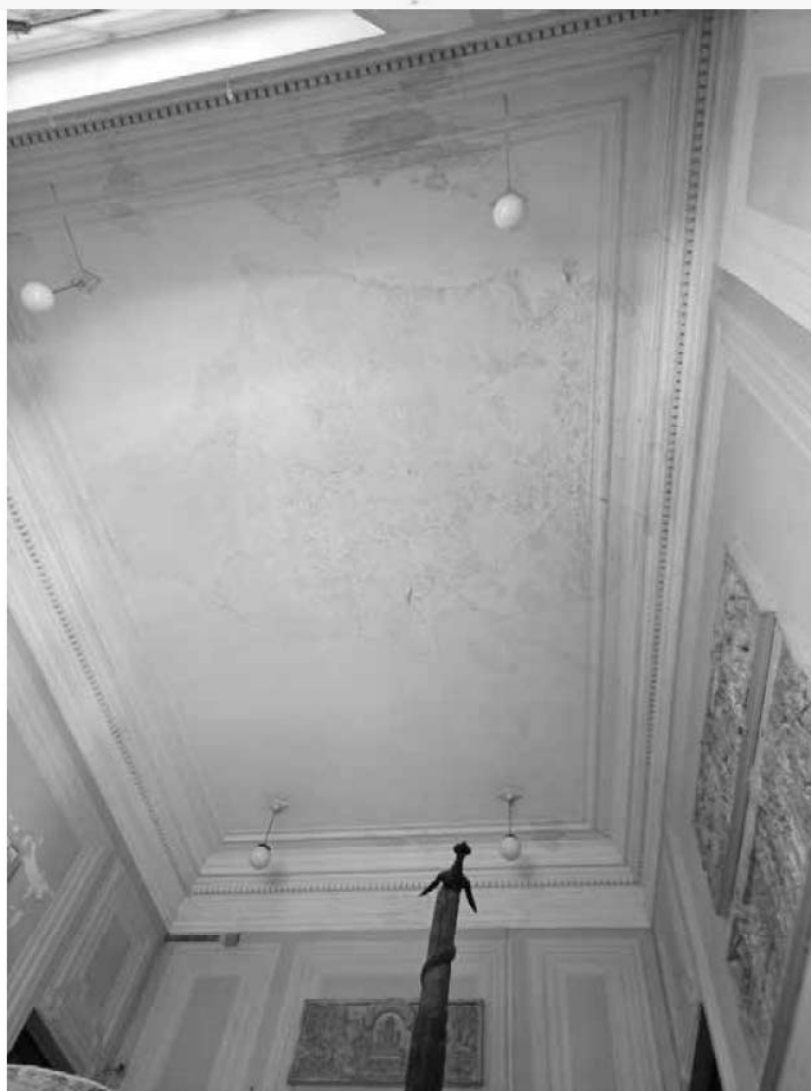
18. Объект культурного наследия федерального значения «Кунсткамера», по адресу: Санкт-Петербург, Университетская набережная, дом № 3, литера Б (Университетская наб., 3). Потолок лестничной клетки. Дата съемки: 12.08.2022г.
