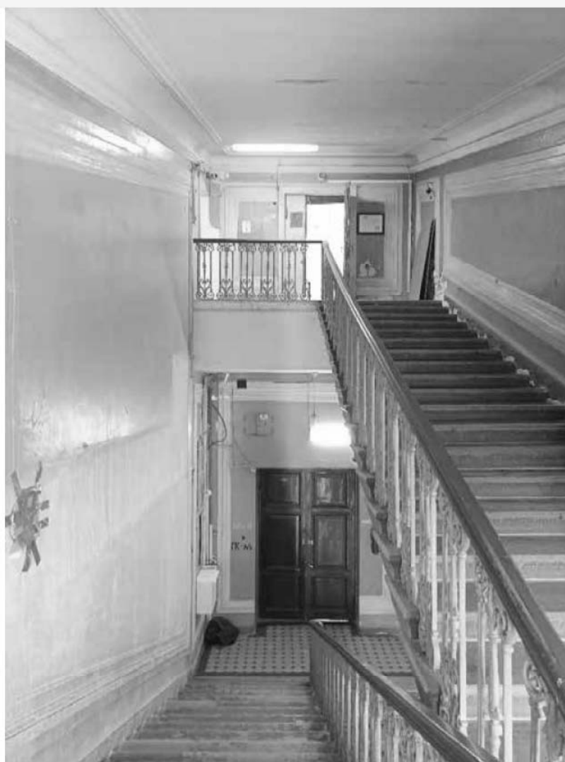
23. Объект культурного наследия федерального значения «Кунсткамера», по адресу: Санкт-Петербург, Университетская набережная, дом № 3, литера Б (Университетская наб., 3). Лестница в уровне 4 этажа. Дата съемки: 12.08.2022г.
