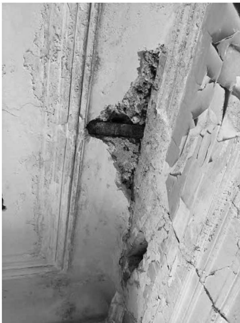
22. Объект культурного наследия федерального значения «Кунсткамера», по адресу: Санкт-Петербург, Университетская набережная, дом № 3, литера Б (Университетская наб., 3). Фрагмент перекрытия лестничной клетки. Дата съемки: 12.08.2022г.
