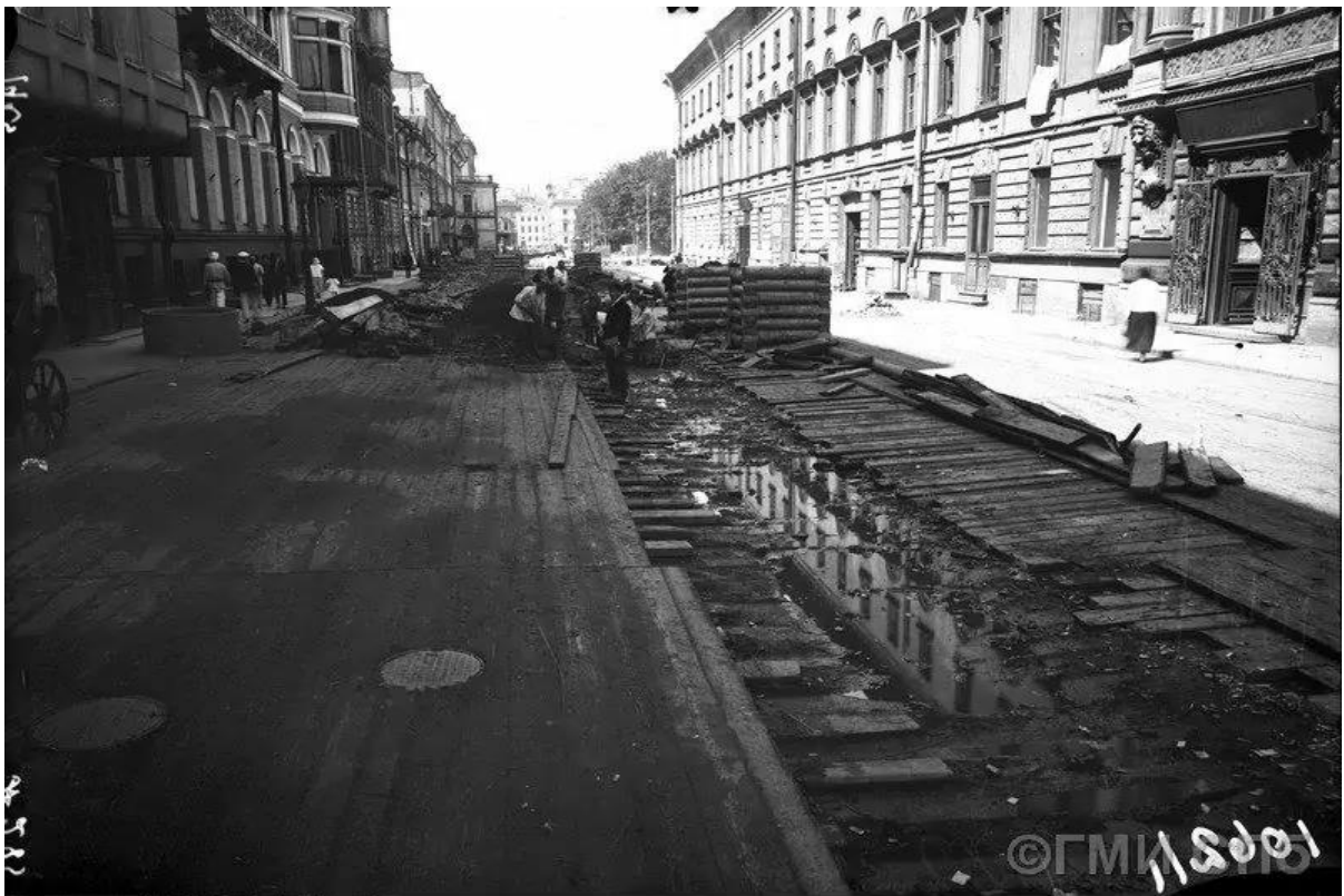
21. Дорожные работы. Снятие деревянной мостовой на улице Ракова (Итальянской улице). 1925 г. (ГМИ СПб - https://goscatalog.ru/portal/#/collections?id=13300360 ).
