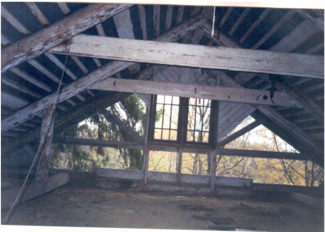
42. Натурные исследования дачи Н.В. Граве по ул. Софийской, 11 в Санкт-Петербурге. СПб., 1999. (архив КГИОП).
