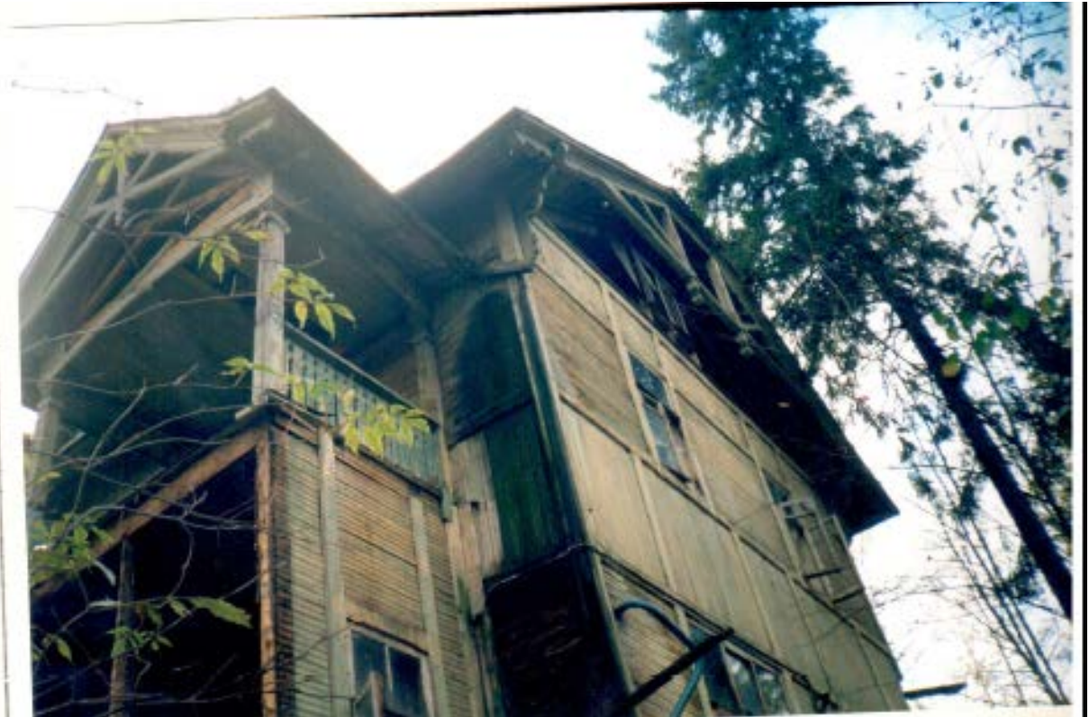
26. Натурные исследования дачи Н.В. Граве по ул. Софийской, 11 в Санкт-Петербурге. СПб., 1999. (архив КГИОП).
