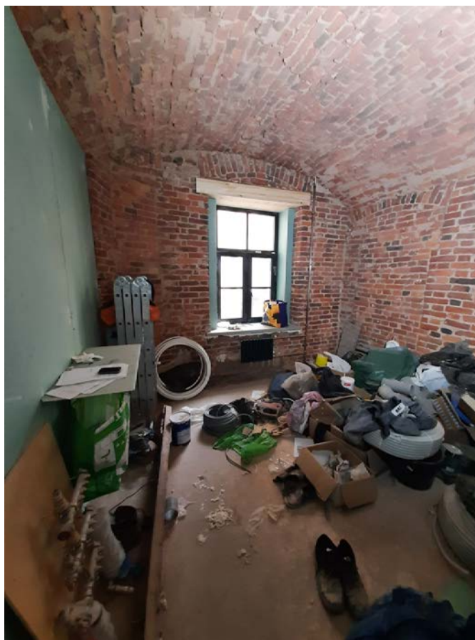
Фото 17 Интерьер квартиры № 32 объекта культурного наследия федерального значения «Дом, где в 1866-1870 гг. находилась «Артель художников» и жил художник Крамской И. Н.»
