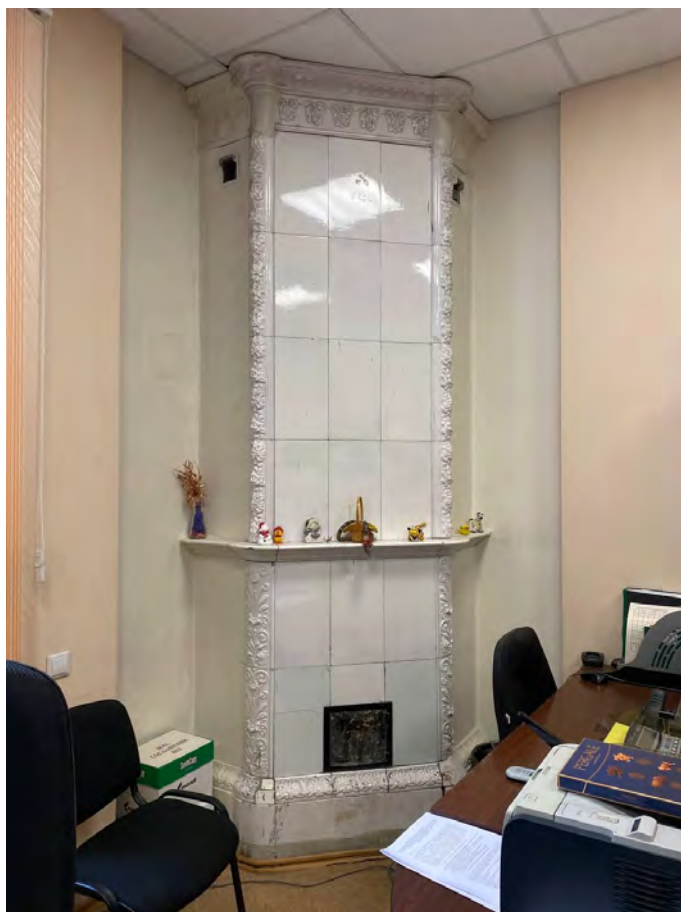
Фото №29. Угловая двухъярусная печь-камин на третьем этаже.
