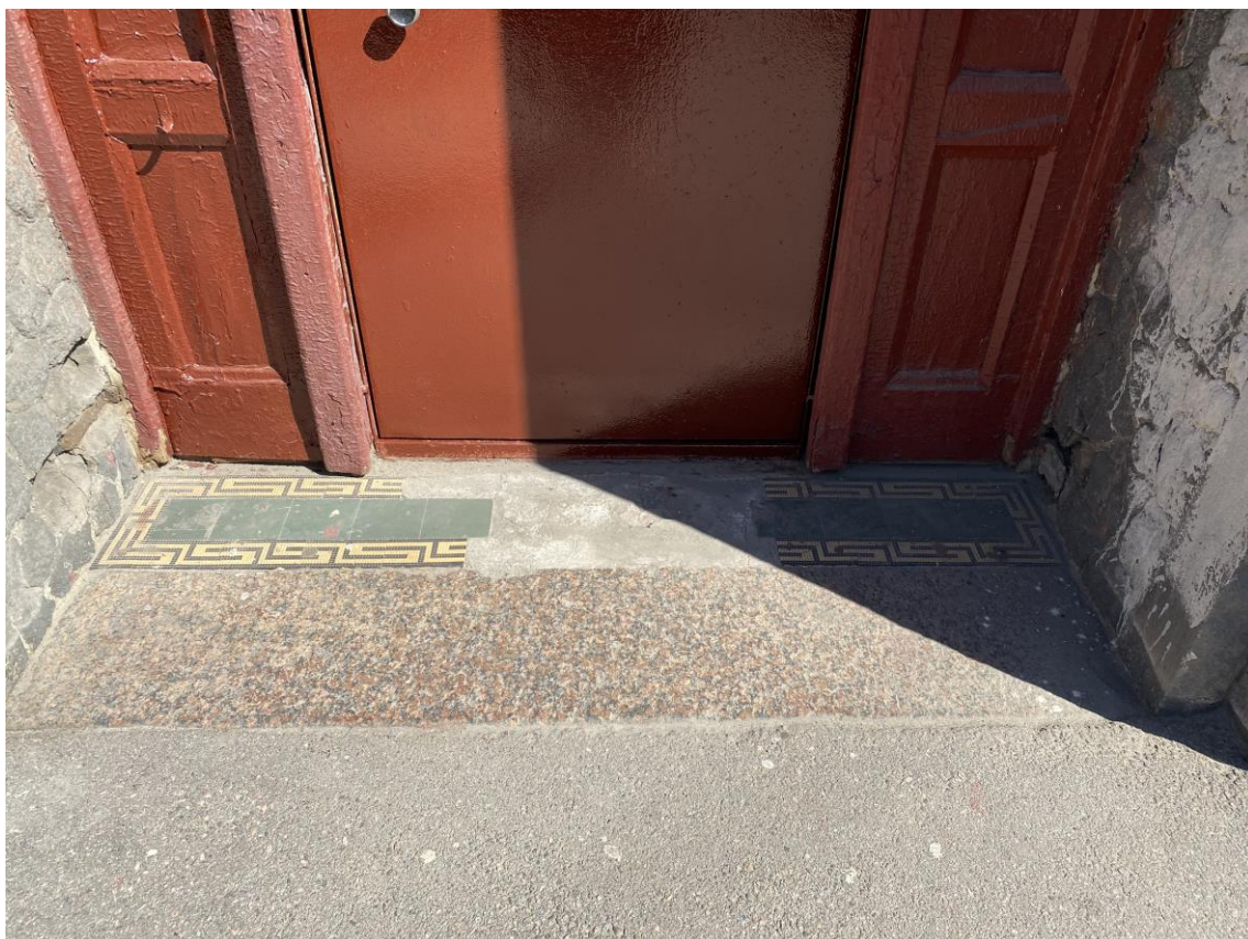
14. Фрагмент лицевого фасада со стороны 8-ой линии В.О. Оформление площадки перед входом на лестницу 1ЛК
