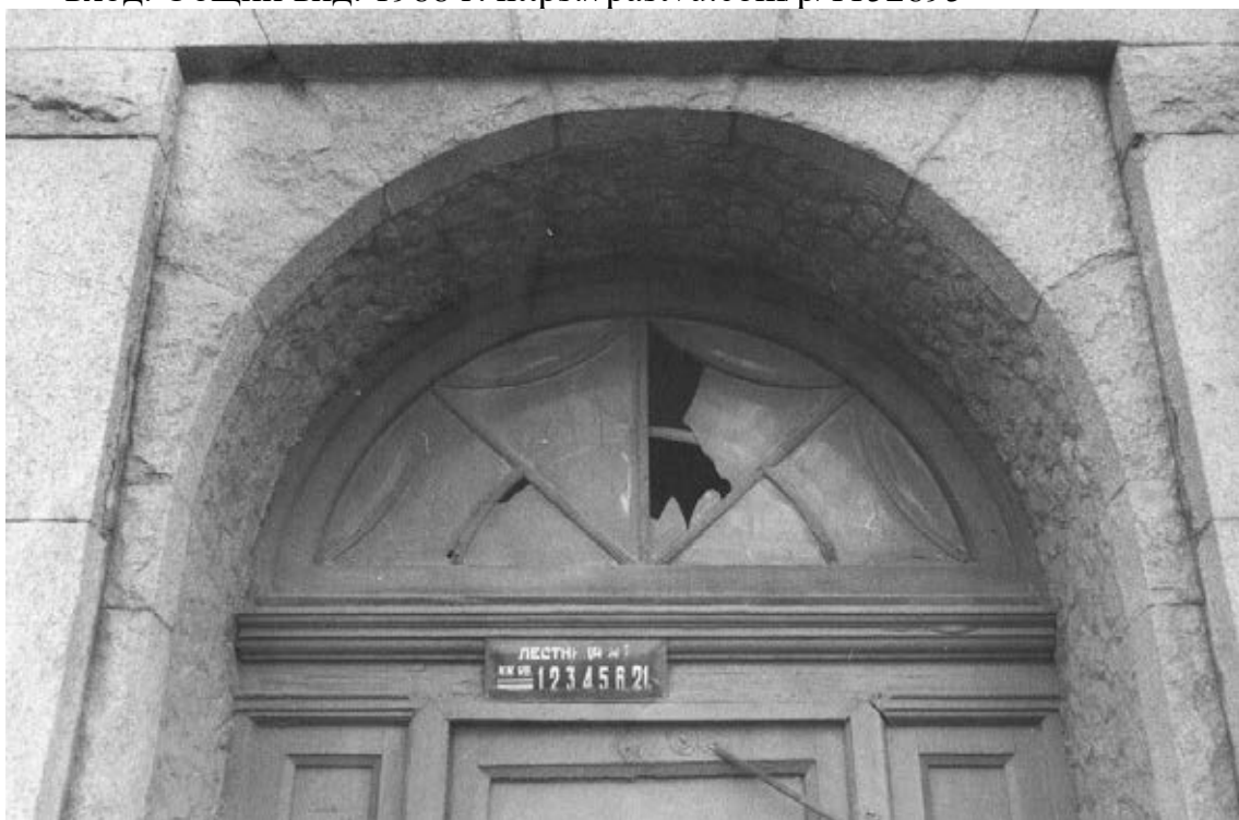
39. Доходный дом М.А. Долгополова. Лицевой фасад. Правый парадный вход. Фрамуга. 1988 г. https://pastvu.com/p/1152897
