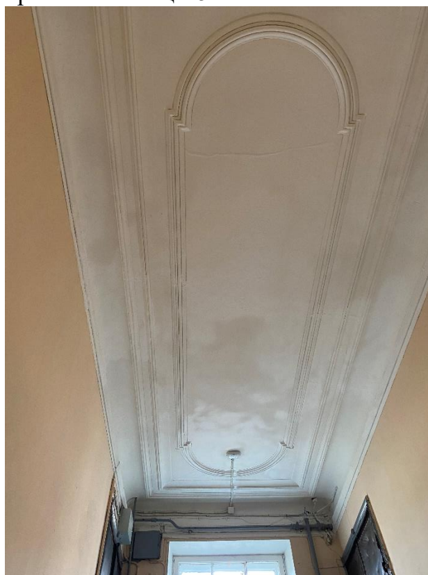
73. Потолок на лестнице 5ЛК
