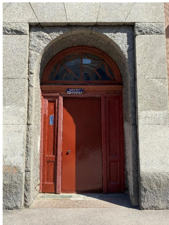
11. Фрагмент лицевого фасада со стороны 8-ой линии В.О. Исторический дверной проем на лестницу 1ЛК.
