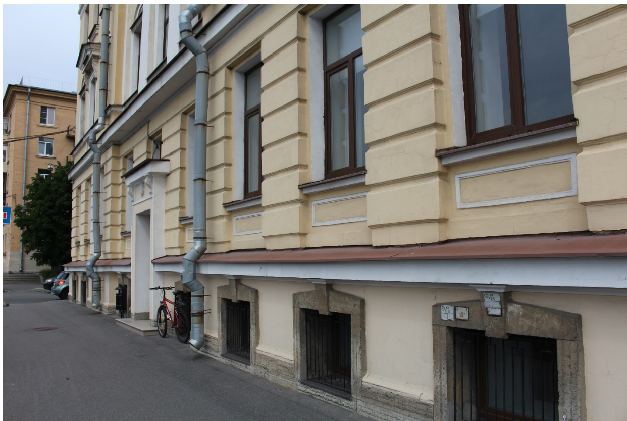
Фото 3. Вид на западный (лицевой) фасад лицевого корпуса выявленного объекта культурного наследия «Дом-приют Кокоревых» в уровне цокольного и 1-го этажей.
