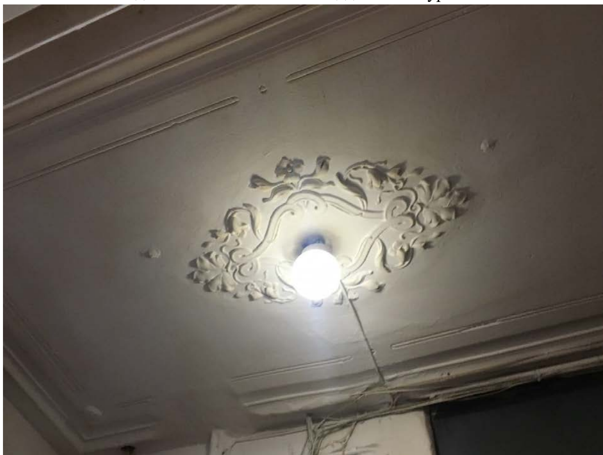
Фото 65. Вид на потолок лестничной площадки 1ЛК в уровне 5-го этажа.
