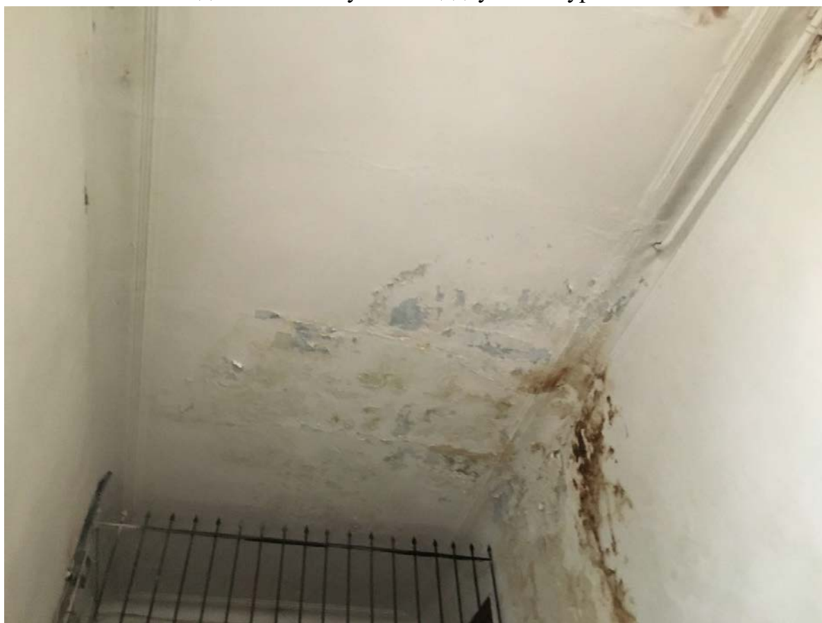
Фото 82. Вид на потолок лестничной площадки 2ЛК в уровне 5-го этажа.
