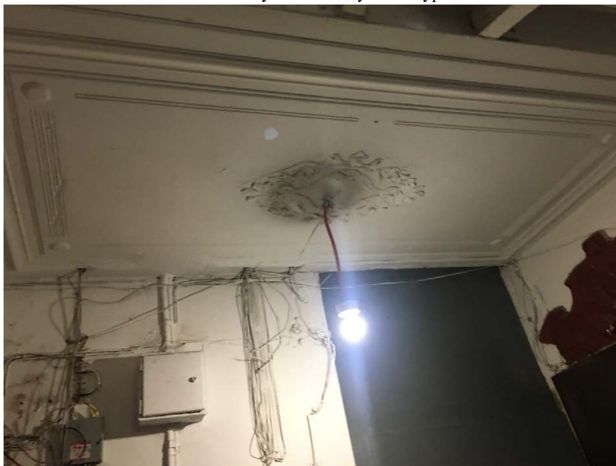
Фото 52. Вид на потолок лестничной площадки 1ЛК в уровне 3-го этажа.
