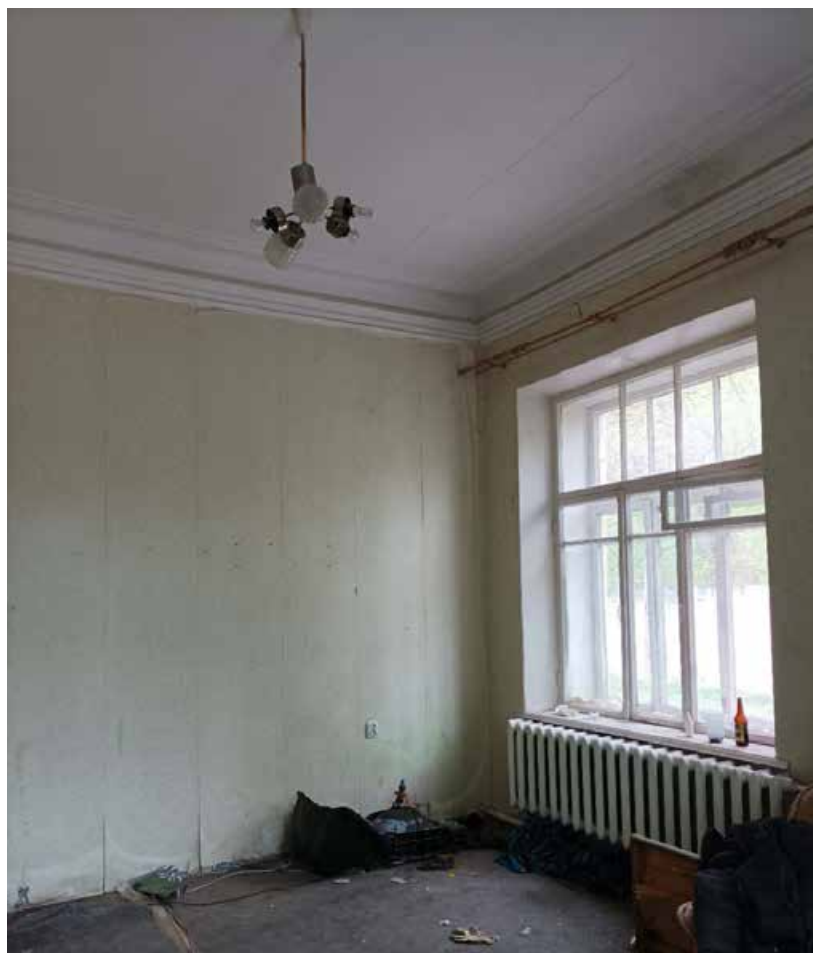
13. Выявленный объект культурного наследия «Здание Константиновской обсерватории», по адресу: Санкт-Петербург, г. Павловск, ул. Садовая, д. 49, лит. Б. Помещение первого этажа. Дата съемки: 15.08.2022г.
