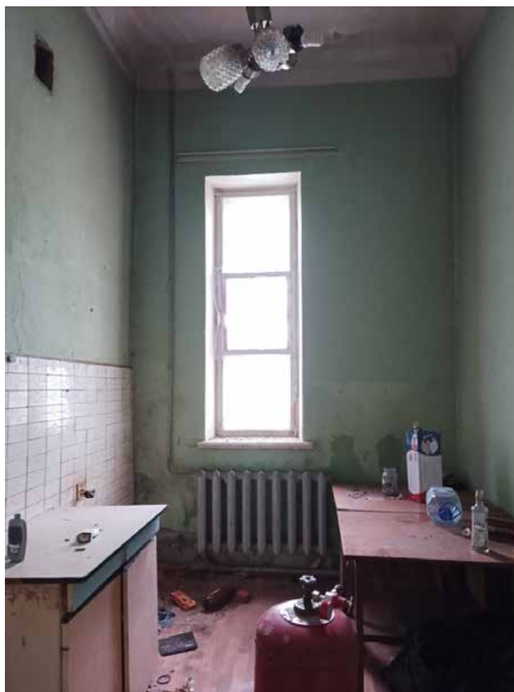
15. Выявленный объект культурного наследия «Здание Константиновской обсерватории», по адресу: Санкт-Петербург, г. Павловск, ул. Садовая, д. 49, лит. Б. Помещение первого этажа. Дата съемки: 15.08.2022г.
