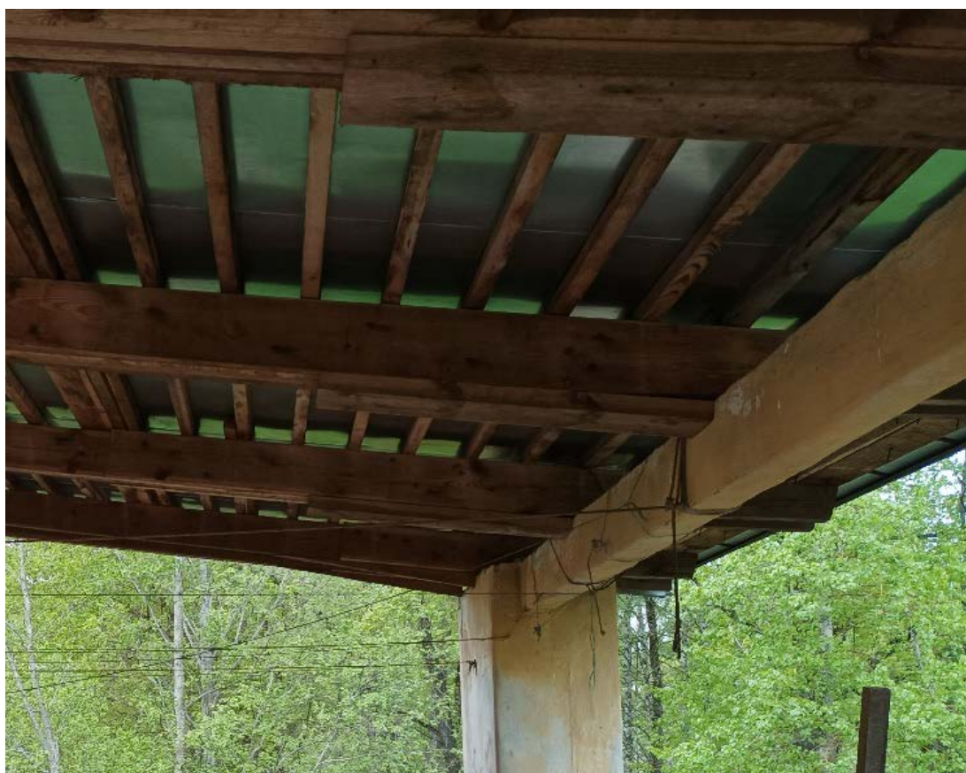
32. Выявленный объект культурного наследия «Здание Константиновской обсерватории», по адресу: Санкт-Петербург, г. Павловск, ул. Садовая, д. 49, лит. Б. Терраса. Дата съемки: 27.05.2022г.
