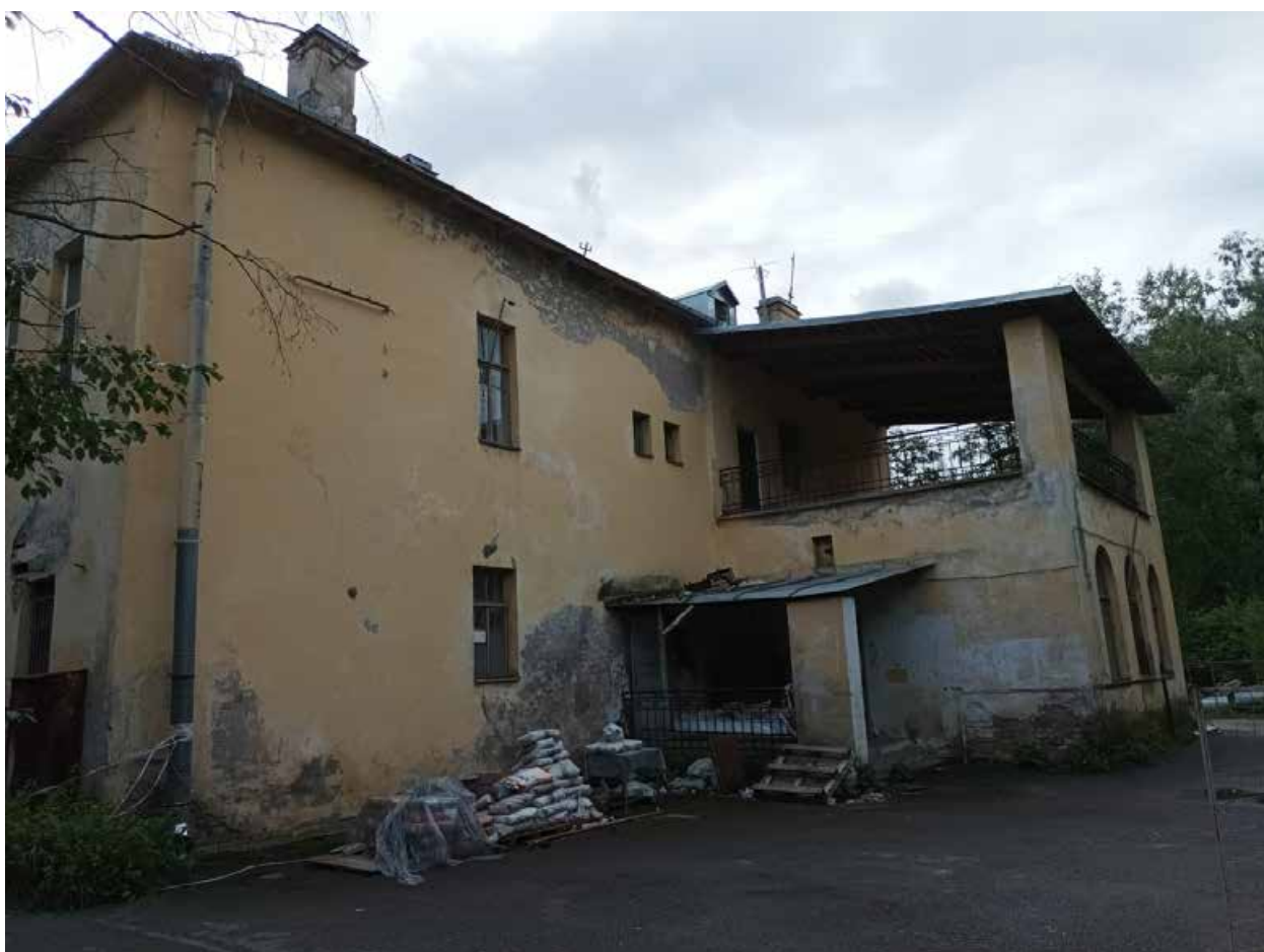
8. Выявленный объект культурного наследия «Здание Константиновской обсерватории», по адресу: Санкт-Петербург, г. Павловск, ул. Садовая, д. 49, лит. Б. Фасад. Дата съемки: 15.08.2022г.
