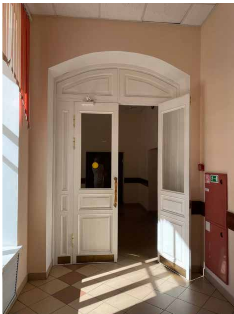
Фото №34. Заполнение дверного проема вестибюля второго этажа.
