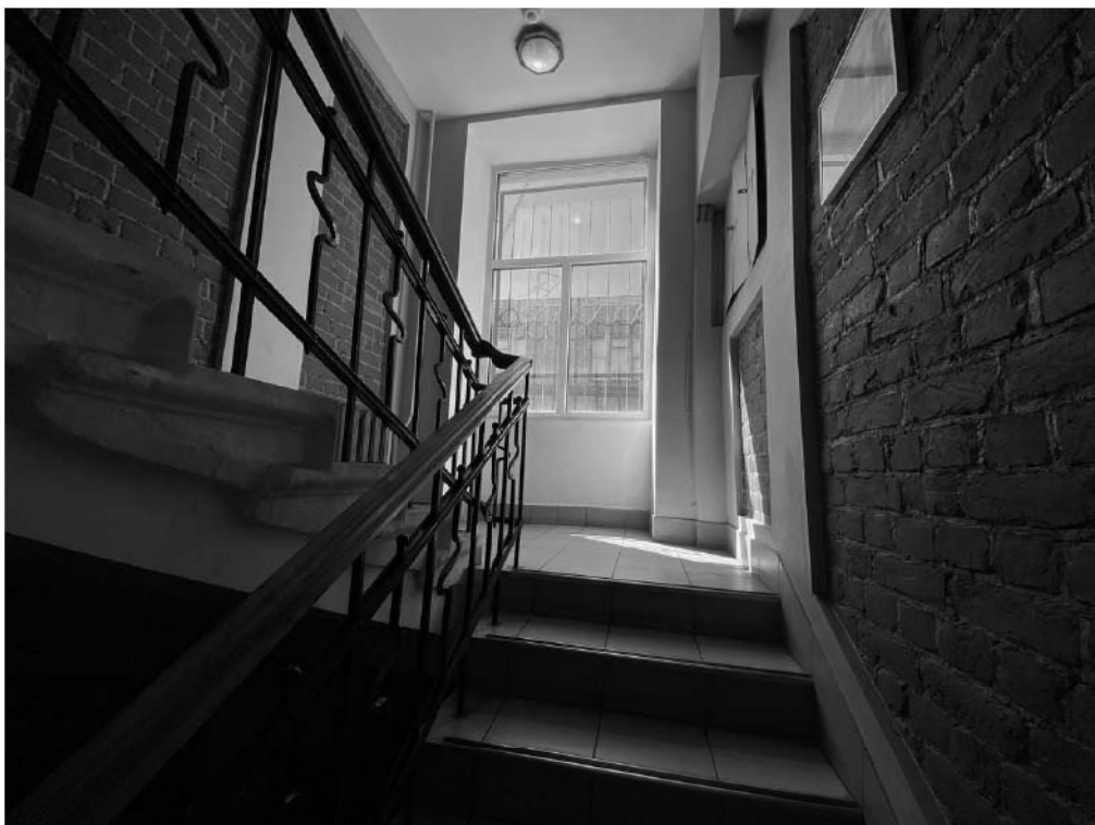
Фото №24. Лестница в южной части здания, вид с лестничного марша на междуэтажную площадку.
