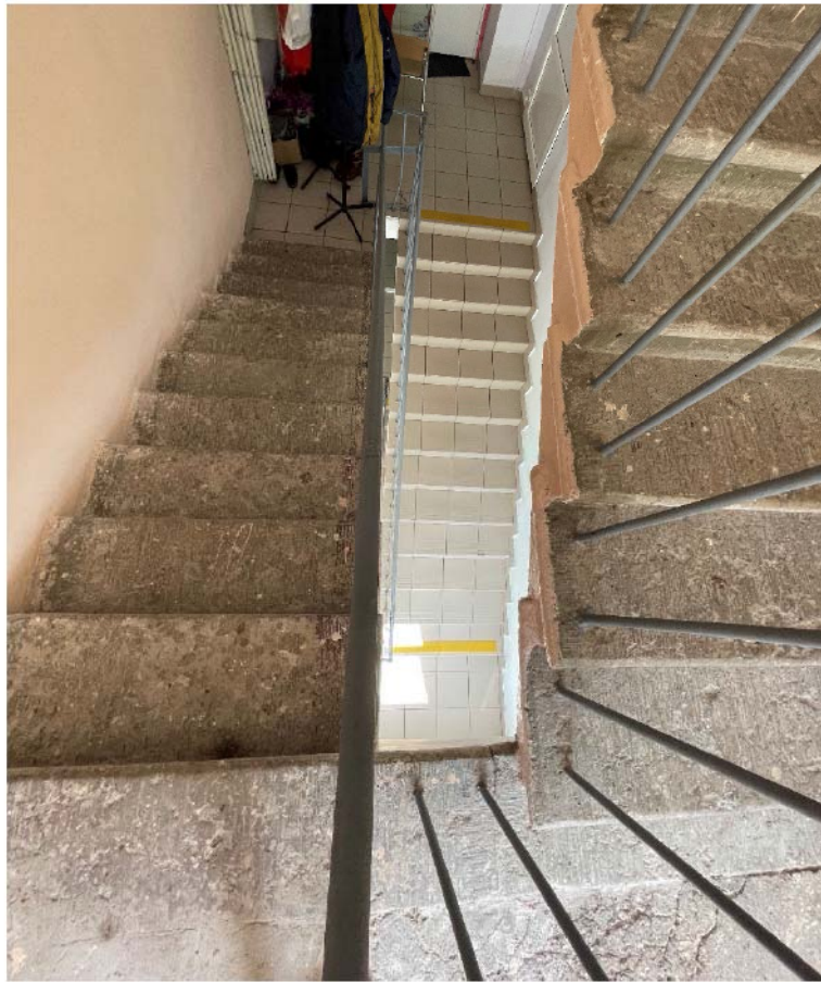
Фото №27. Служебная известняковая лестница, вид с междуэтажной площадки 2 и 3 этажа на нижние марши.
