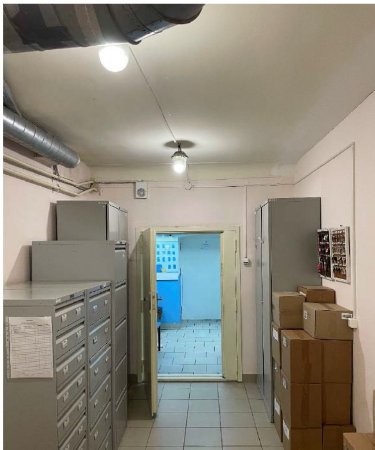
Фото №37. Помещение венткамеры в подвале.
