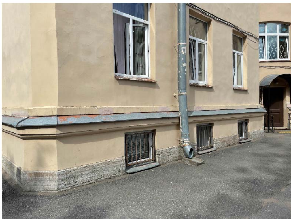
Фото №8. Цоколь здания с профилированным завершением и известняковой скобой.
