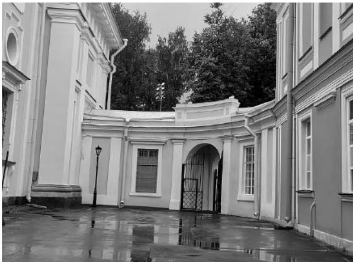
Фото 06. ОКН федерального значения «Собор Троицкий с двумя соединительными корпусами». Северный соединительный корпус. Общий вид. Съёмка 05.07.2022 г.
