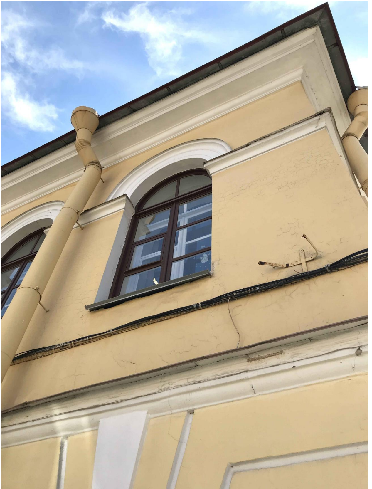
Фото 12. ОКН федерального значения «Дом плац-майорский» (Петропавловская крепость, дом 6 лит В). Северо-западный фасад. Оконный проём в уровне второго этажа. Фрагмент. Съёмка 17 мая 2021 г.
