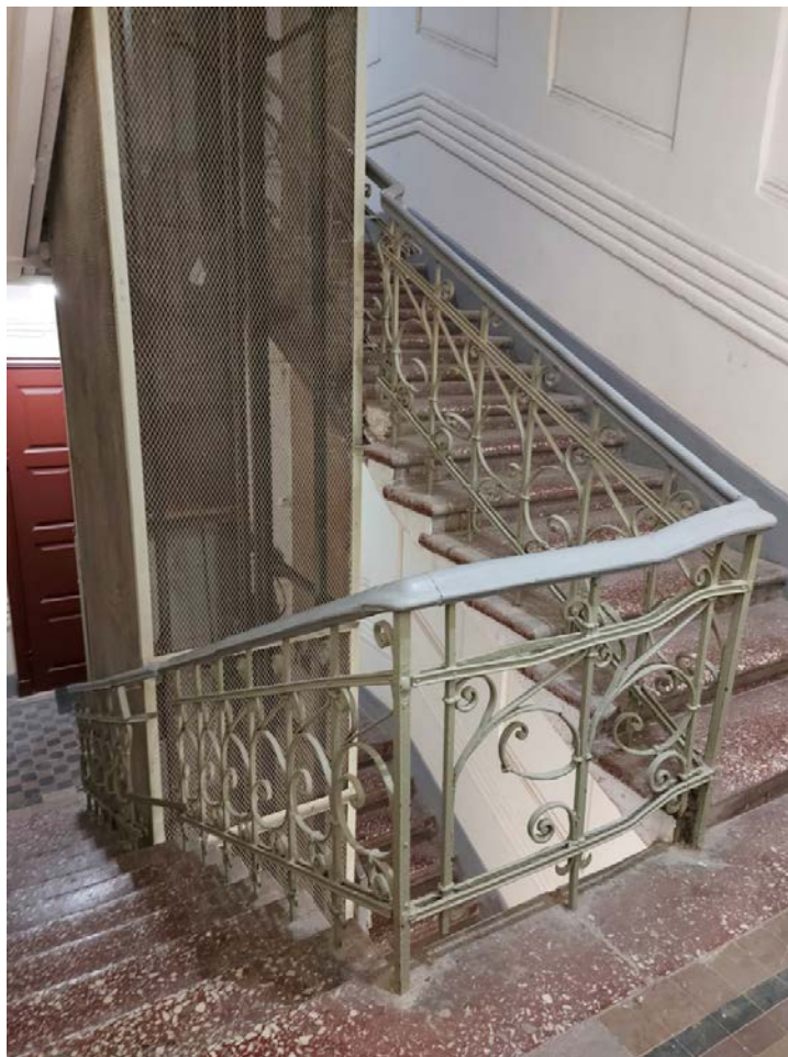
Фото 74. Ограждение парадной 2ЛК между 3 и 4 этажами.
