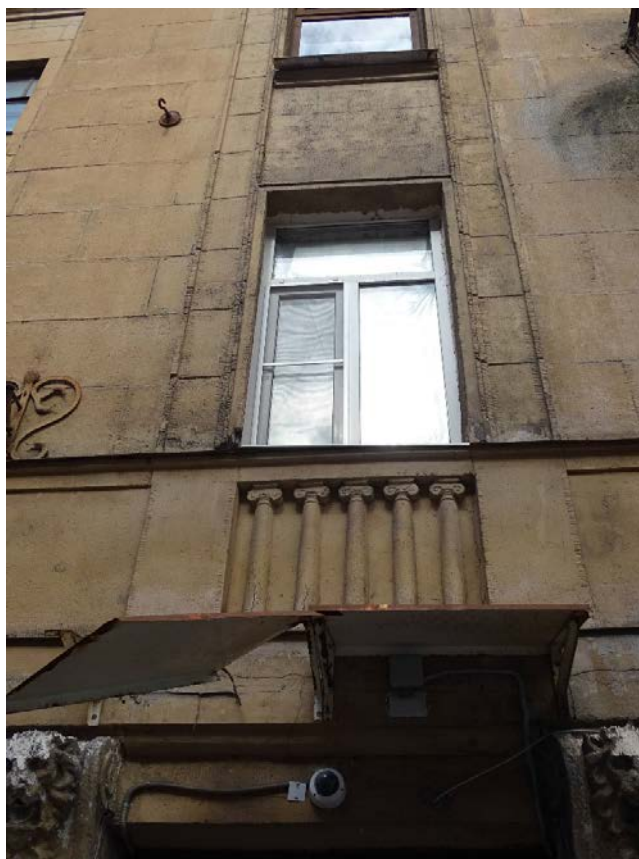
Фото 17. Здание по адресу: г. Санкт-Петербург, Большая Зеленина ул., дом 29, литера А. Фрагмент лицевого фасада по ул. Большая Зеленина. Съемка 19.04.2021 г. Штиглиц М. С.
