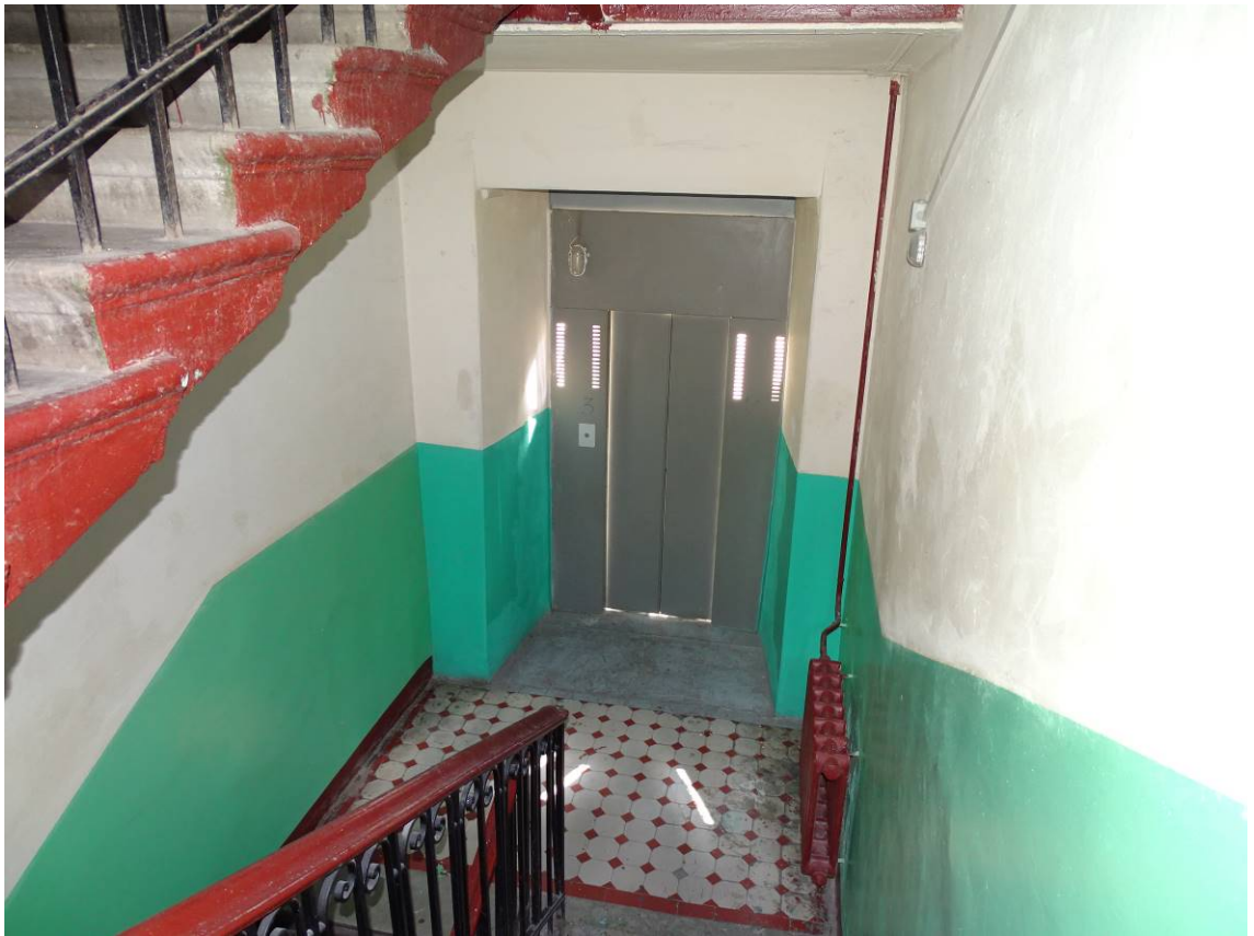
Фото 90. Лестница № 3. Вид на площадку м/у 3-м и 4-м этажом. Съемка 19.04.2021 г. Штиглиц М. С.
