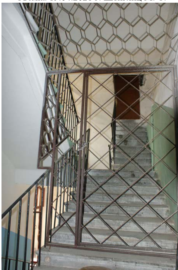
Фото 134. Лестница № 4. Закрытая металлическая решетка на 6-й этаж. Съемка 19.04.2021 г. Штиглиц М. С.
