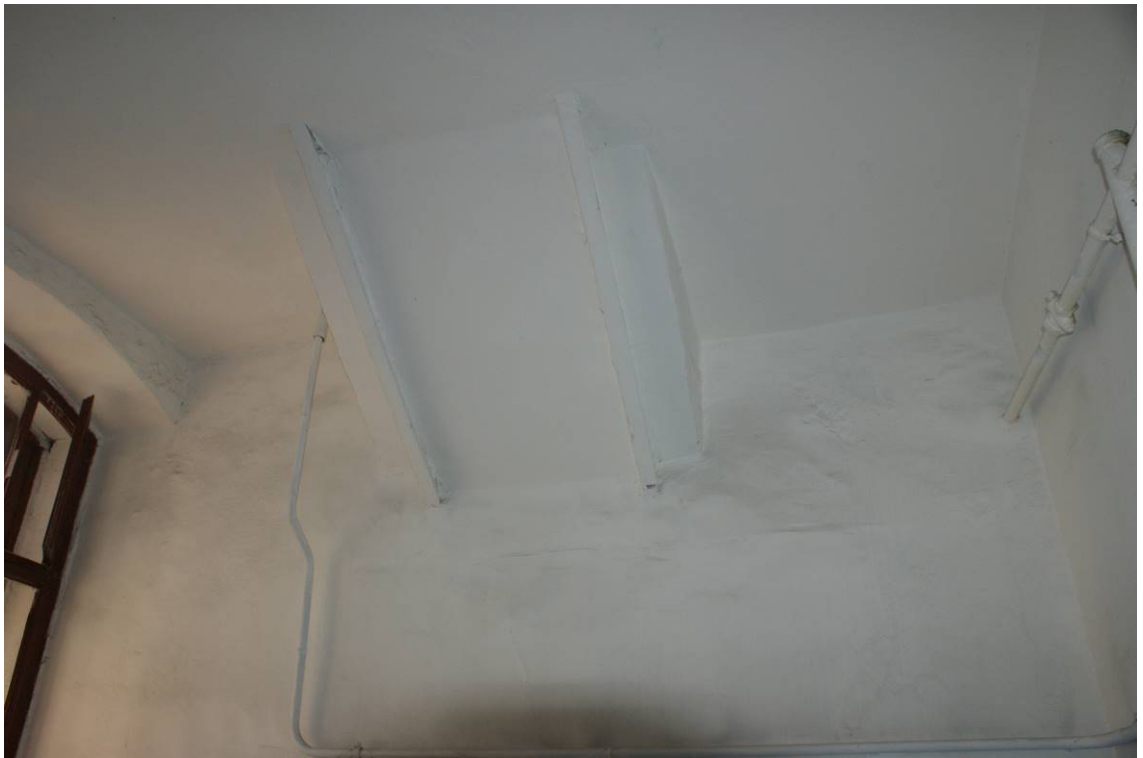
Фото 129. Лестница № 4. Площадка м/у 4-м и 5-м этажом. Своды. Съемка 19.04.2021 г. Штиглиц М. С.
