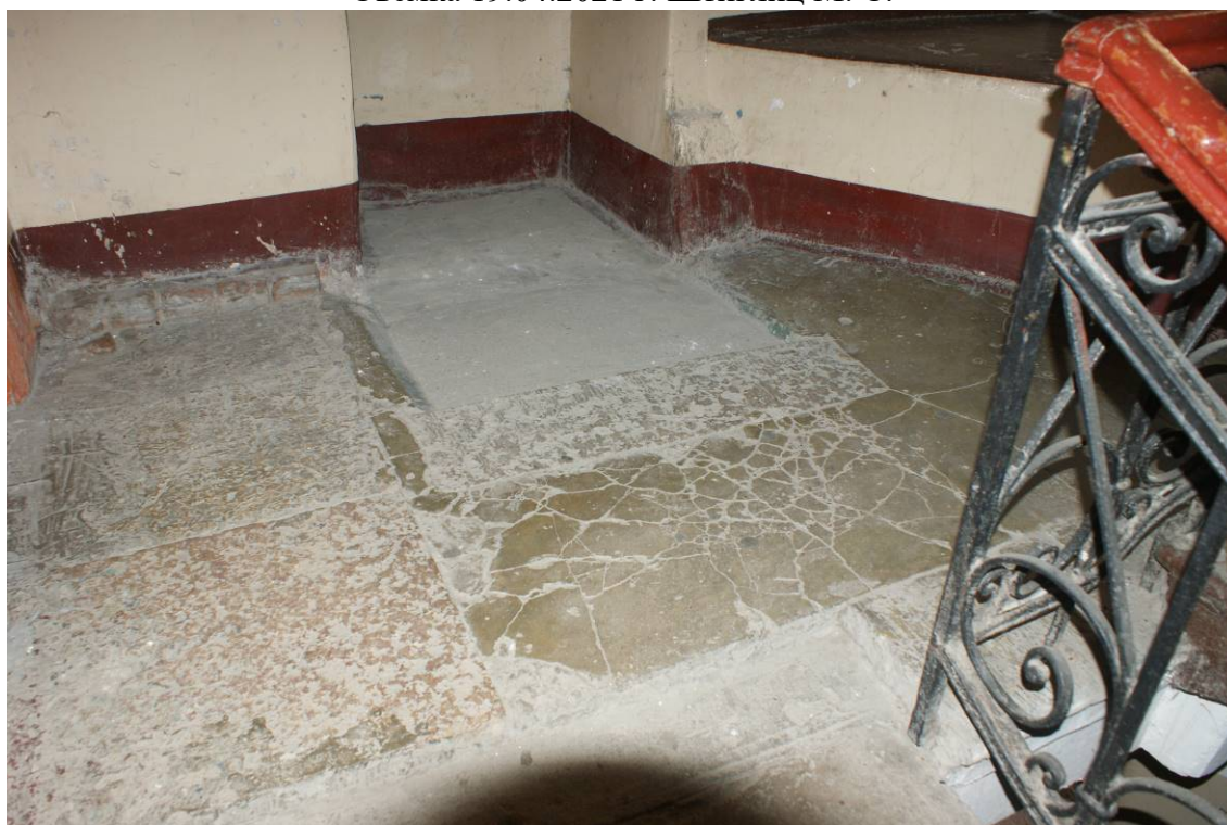
Фото 146. Лестница № 5. Площадка м/у 1-м и 2-м этажом. Покрытие пола. Съемка 19.04.2021 г. Штиглиц М. С.
