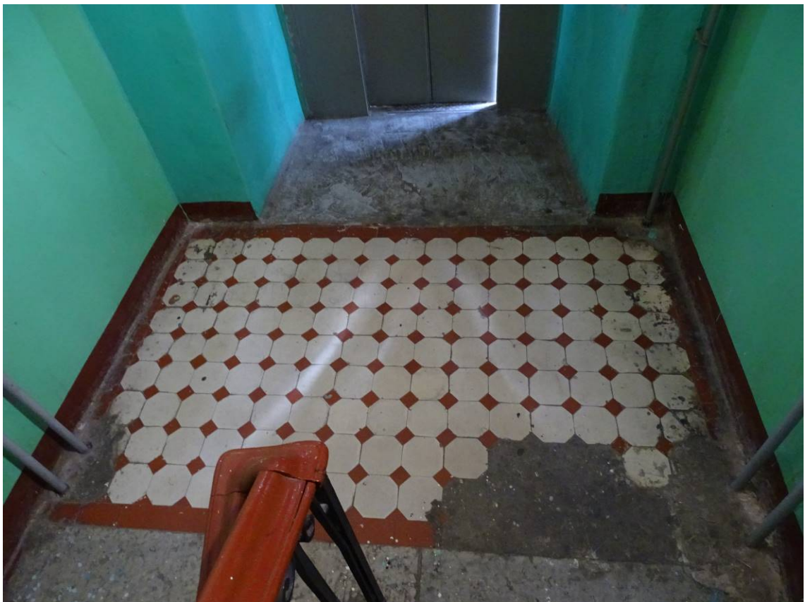
Фото 99. Лестница № 3. Площадка м/у 5-м и 6-м этажом. Покрытие пола. Съемка 19.04.2021 г. Штиглиц М. С.
