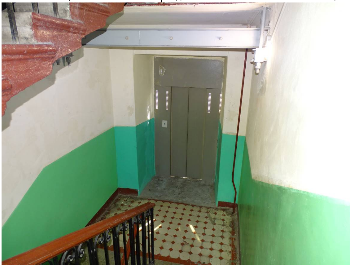
Фото 93. Лестница № 3. Вид на площадку м/у 4-м и 5-м этажом. Съемка 19.04.2021 г. Штиглиц М. С.
