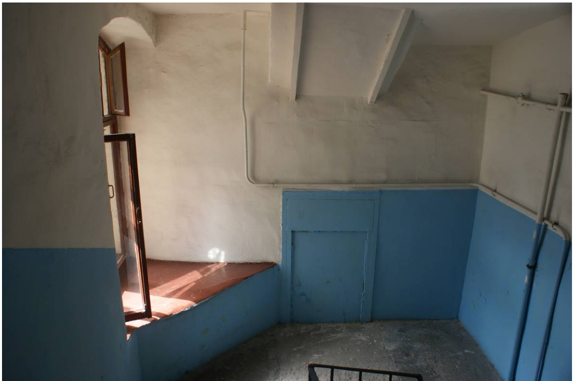
Фото 128. Лестница № 4. Вид на площадку м/у 4-м и 5-м этажом. Съемка 19.04.2021 г. Штиглиц М. С.
