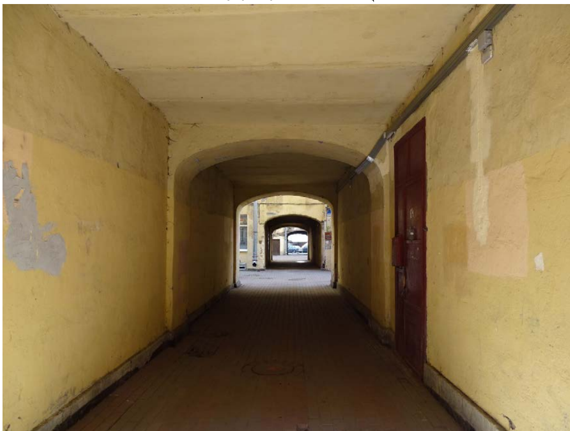
Фото 34. Здание по адресу: г. Санкт-Петербург, Большая Зеленина ул., дом 29, литера А. Воротный проезд дворового флигеля. Съемка 19.04.2021 г. Штиглиц М. С.
