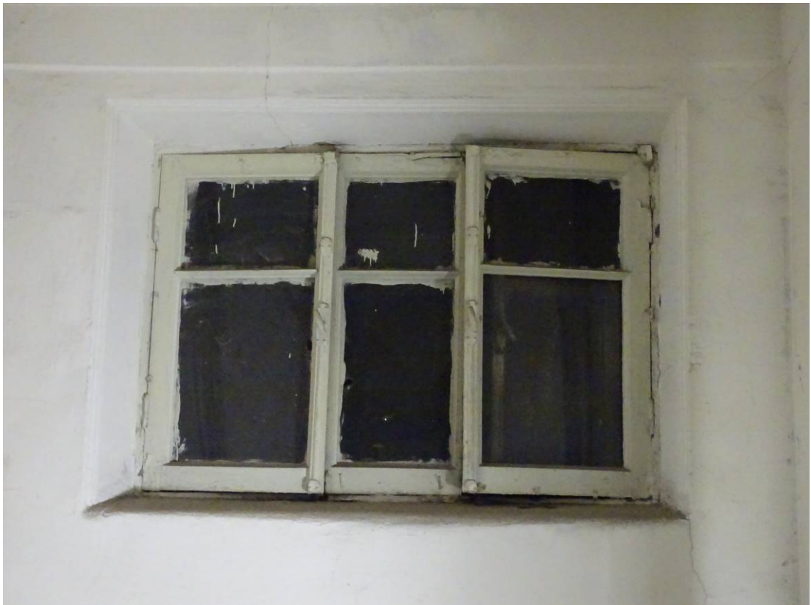
Фото 98. Лестница № 3. Площадка м/у 5-м и 6-м этажом. Оконные проем. Съемка 19.04.2021 г. Штиглиц М. С.
