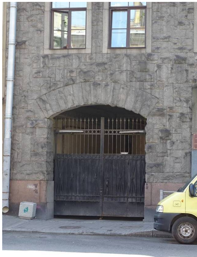
Фото 8. Воротный проезд с лучковой перемычкой. Лицевой фасад. Съемка 26.04.2021 г. Михайловская Г. В.
