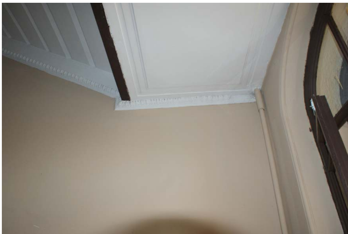
Фото 64. Лестница № 3: Площадка между 3-м и 4-м этажом. Съемка 26.04.2021 г. Михайловская Г. В.
