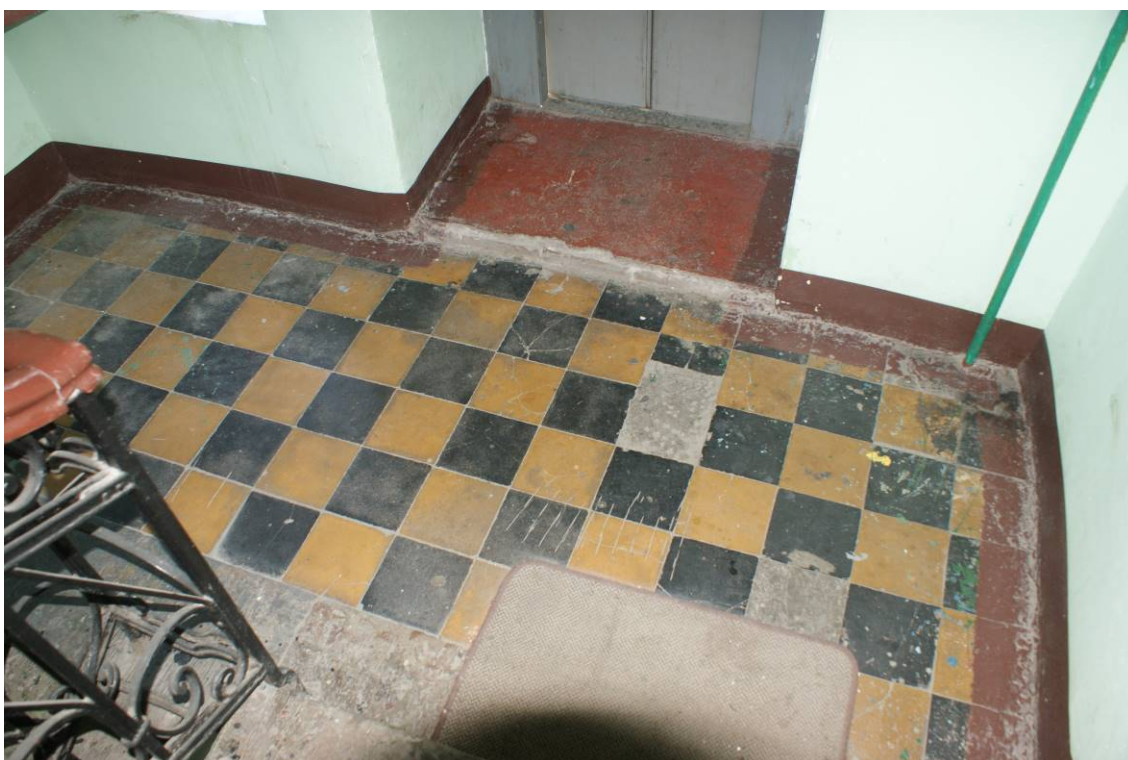
Фото 107. Лестница № 8. Площадка между 4-м и 5-м этажом. Покрытие пола. Съемка 19.04.2021 г. Штиглиц М. С.
