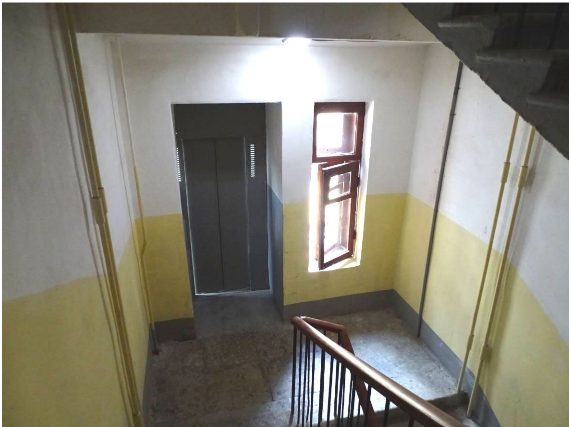
Фото 22. Лестница № 6. Площадка между 4-м и 5-м этажом. Съемка 19.04.2021 г. Штиглиц М. С.
