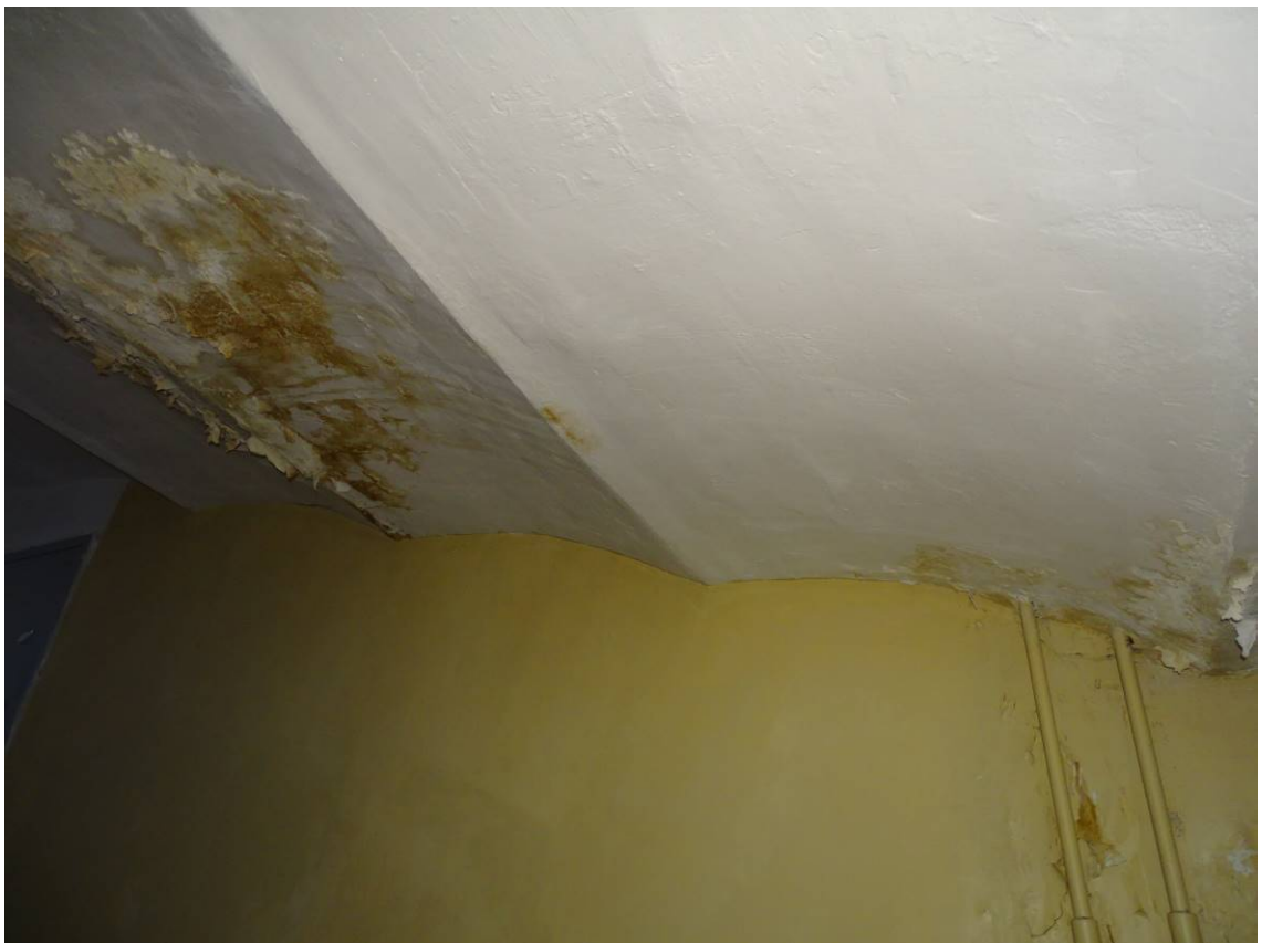
Фото 32. Лестница № 6. Площадка между 5-м и чердачным этажом. Своды. Съемка 19.04.2021 г. Штиглиц М. С.
