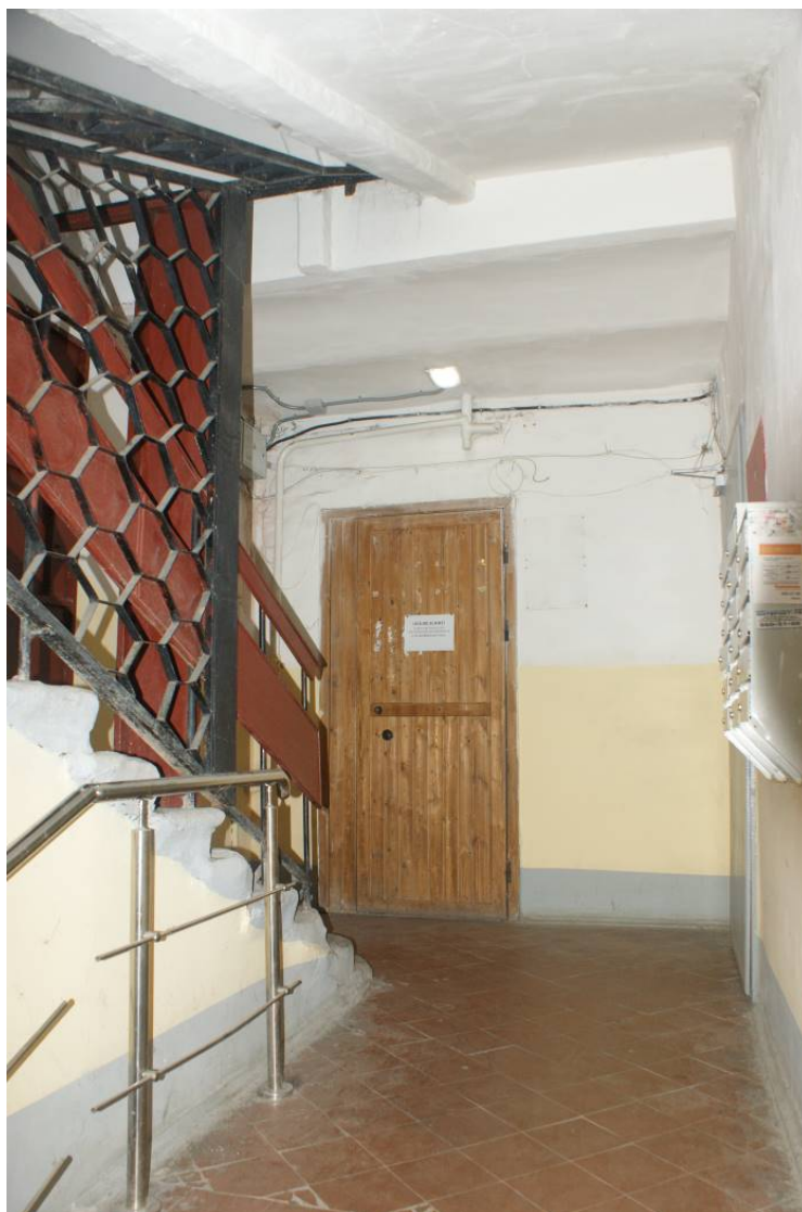
Фото 5. Лестница № 6. 1-й этаж. Съёмка 19.04.2021 г. Штиглиц М. С.
