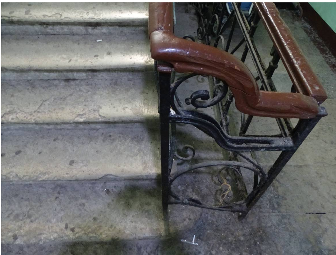
Фото 90. Лестница № 8. 1-й этаж. Вестибюль. Ступени лестничного марша. Съемка 19.04.2021 г. Штиглиц М. С.
