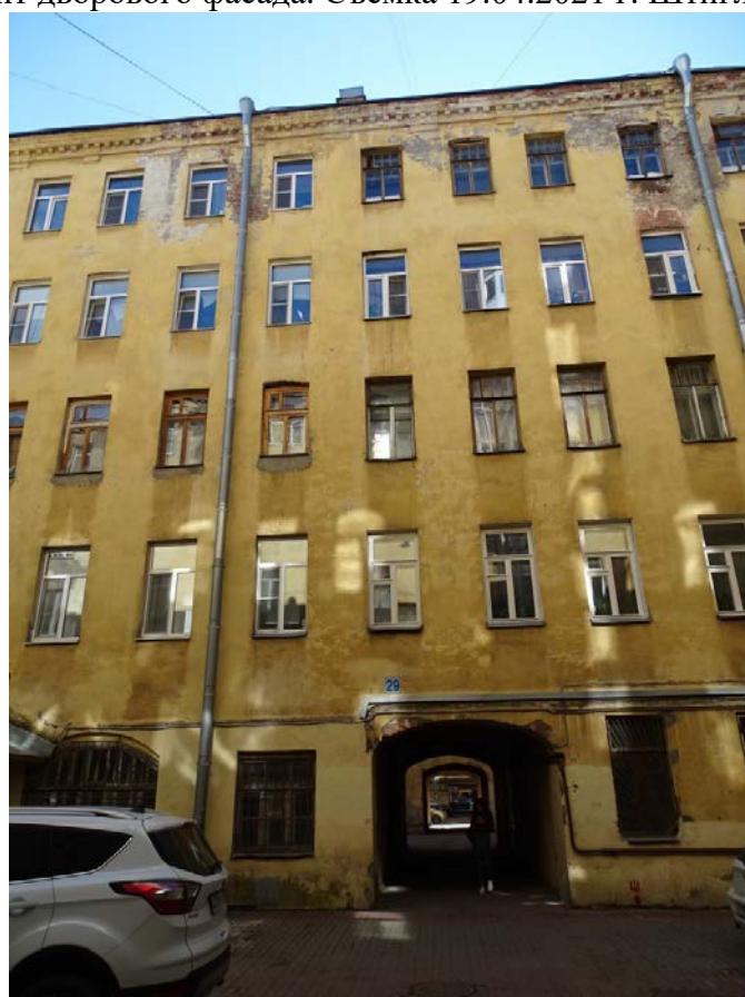
Фото 20. Здание по адресу: г. Санкт-Петербург, Большая Зеленина ул., дом 29, литера Б. Фрагмент дворового фасада. Съемка 19.04.2021 г. Штиглиц М. С.
