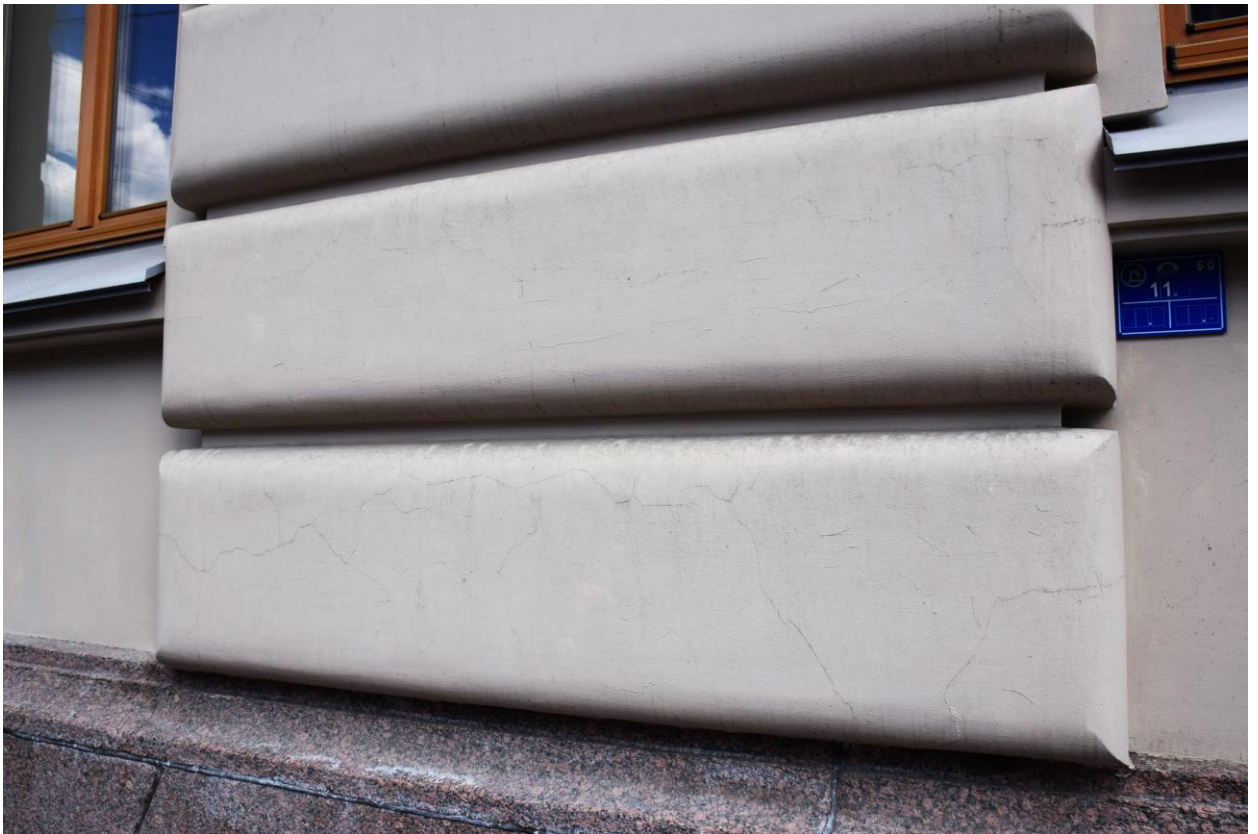
3. Доходный дом Н.В.Спиридонова. Дефекты (волосяные трещины) штукатурной отделки главного фасада.
