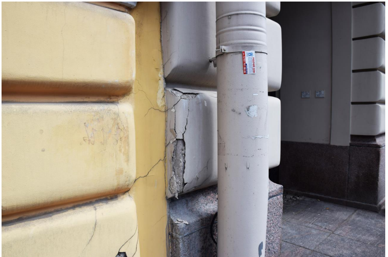
4. Доходный дом Н.В.Спиридонова. Дефекты штукатурной отделки главного фасада.
