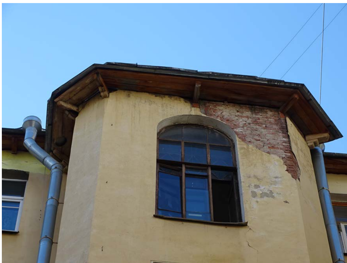
Фото 66. Фрагмент западного фасада восточного внутреннего двора. Ризалит. 6-й этаж. Съемка 26.04.2021 г. Трушковский В.Э.
