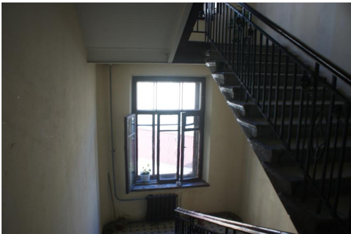
Фото 108. Лестница № 4. Площадка между 4 и 5 этажом. Съемка 26.04.2021 г. Трушковский В. Э.
