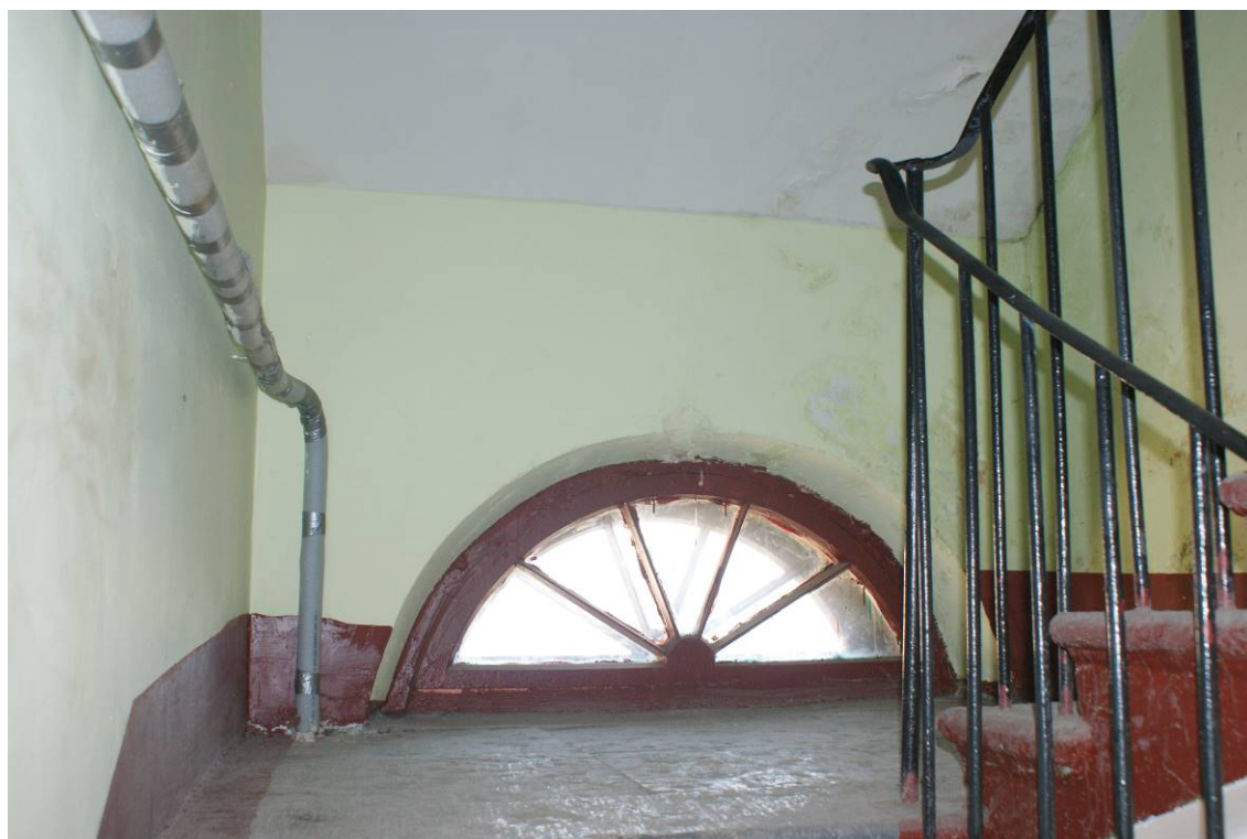
Фото 87. Лестница № 3. Площадка между 5 и 6 этажом. Съемка 26.04.2021 г. Трушковский В. Э.
