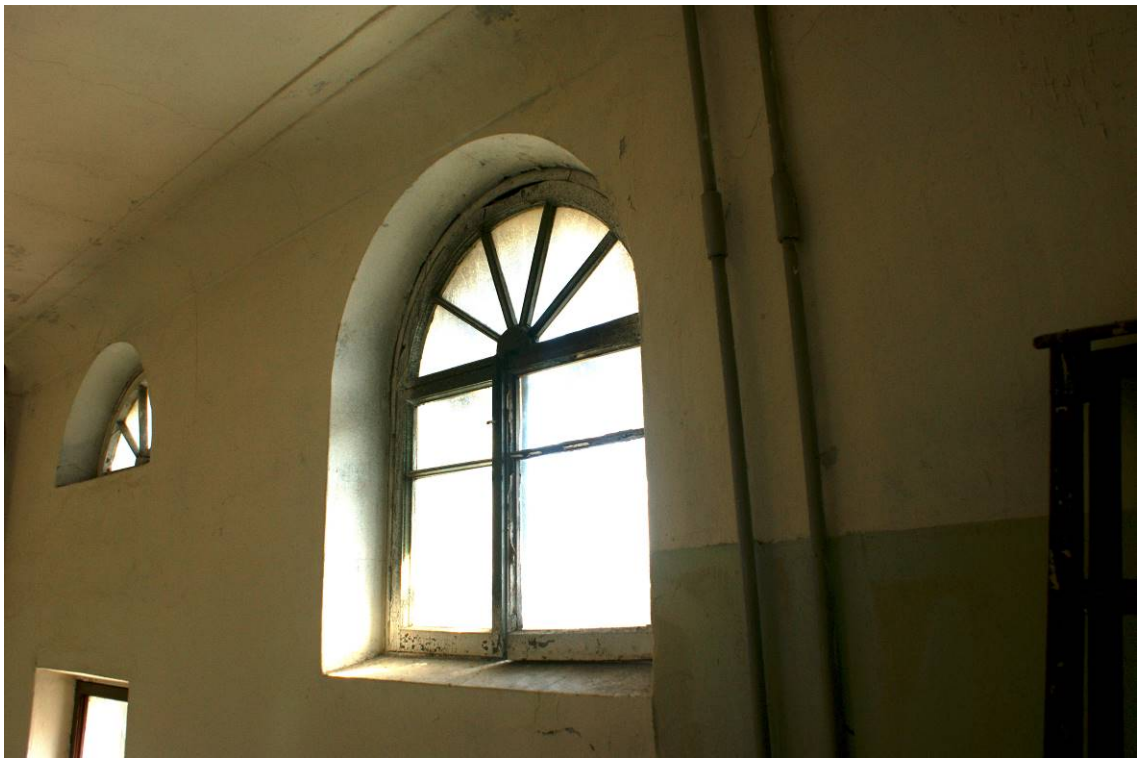
Фото 68. Лестница № 2. 6 этаж. Оконный проем. Съемка 26.04.2021 г. Трушковский В. Э.
