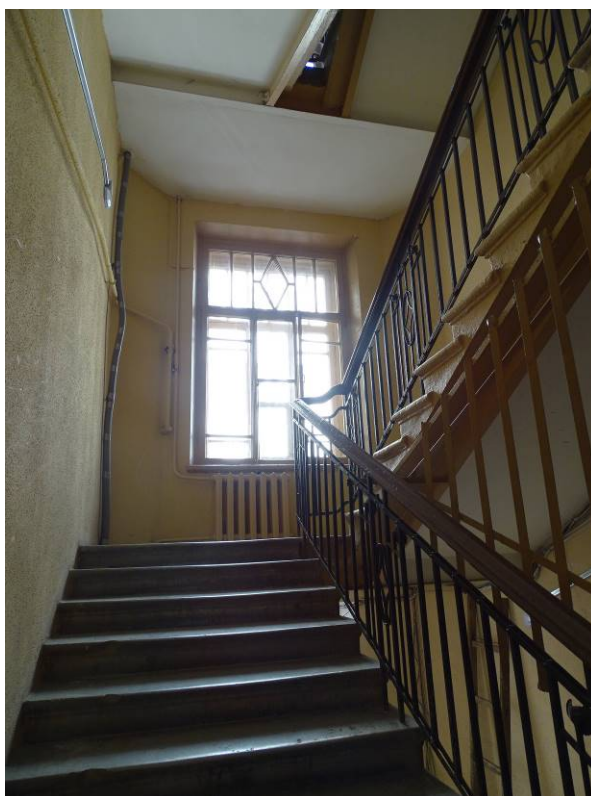
Фото 10. Лестница № 1. Площадка между 1 и 2 этажом. Съемка 26.04.2021 г. Трушковский В. Э.
