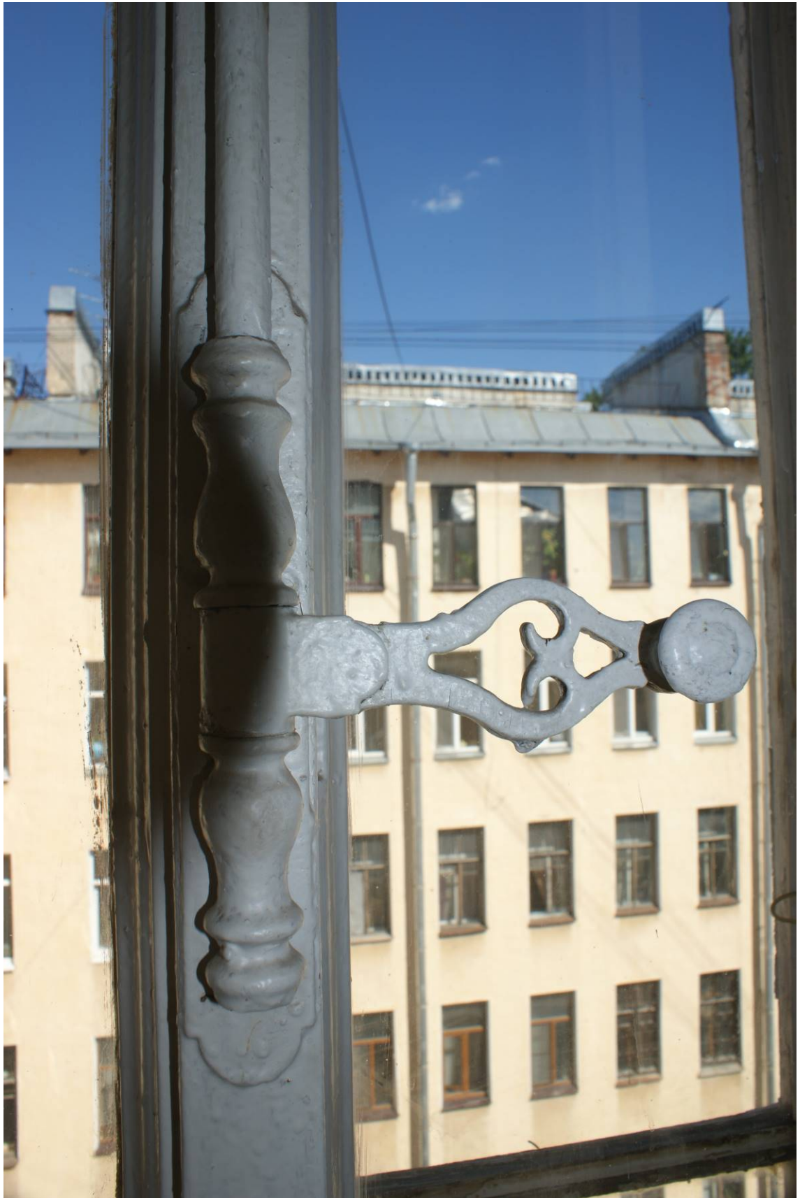
Фото 29. Лестница № 1. Оконная фурнитура. Съемка 26.04.2021 г. Трушковский В. Э.
