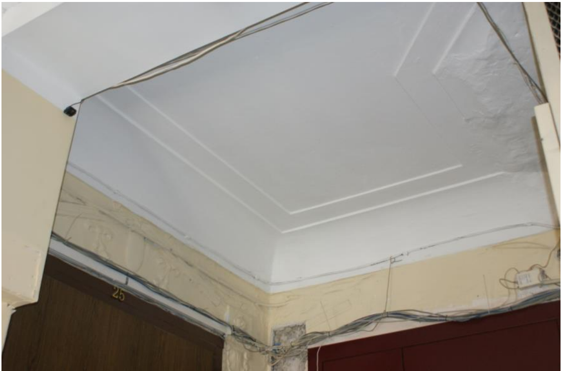
Фото 115. Лестница № 4. 6 этаж. Оформление стен лестничной клетки. Лепные композиции растительного характера. Оформление потолка. Съемка 26.04.2021 г. Трушковский В. Э.
