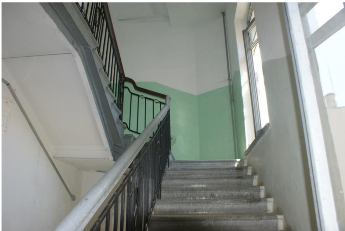
Фото 54. Лестница № 2. Площадка между 4 и5 этажом. Съемка 26.04.2021 г. Трушковский В. Э.
