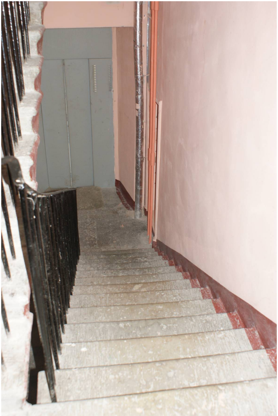
Фото 133. Лестница №6. Площадка между 3 и 4 этажом. Съемка 26.04.2021 г. Трушковский В.Э
