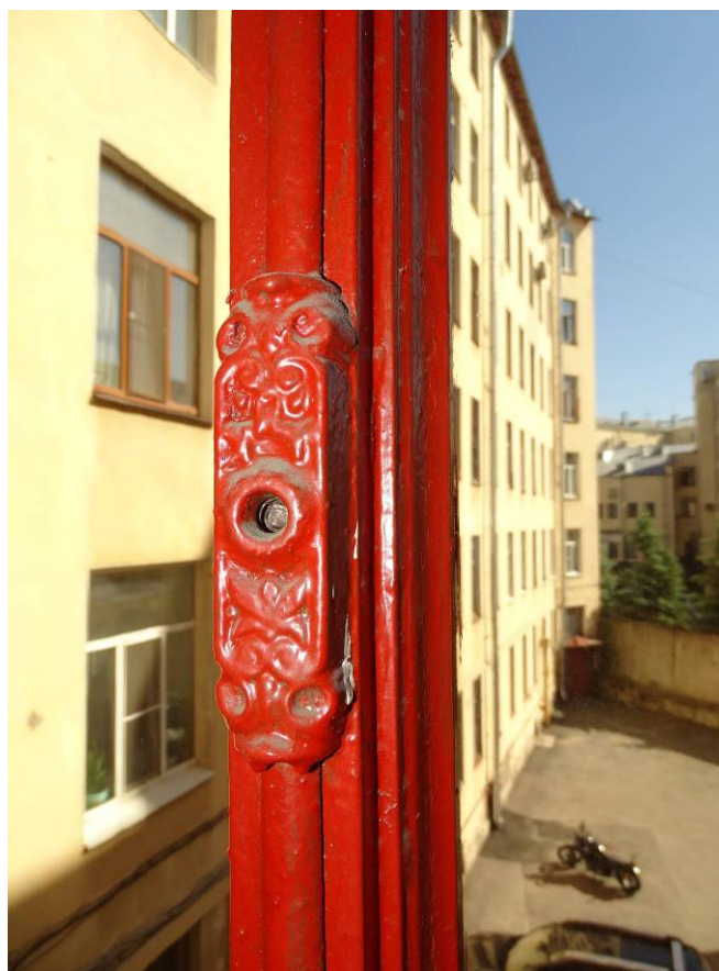
Фото 89. Лестница № 3. Оконная фурнитура. Съемка 26.04.2021 г. Трушковский В. Э.
