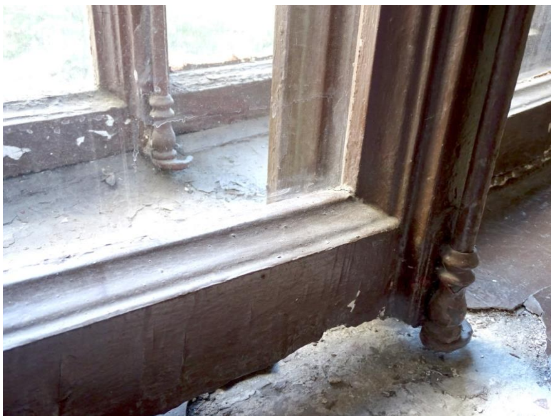
Фото 103. Лестница № 4. Оконная фурнитура. Съемка 26.04.2021 г. Трушковский В. Э.
