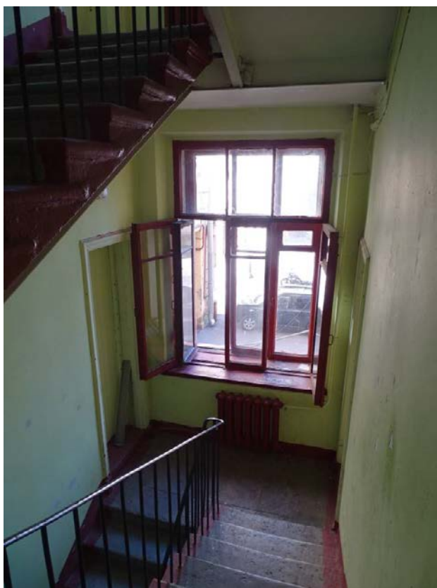
Фото 74. Лестница № 3.Площадка между 1 и 2 этажом. Съемка 26.04.2021 г. Трушковский В. Э.
