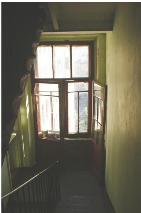
Фото 84. Лестница № 3. Площадка между 4 и 5 этажом. Съемка 26.04.2021 г. Трушковский В. Э.
