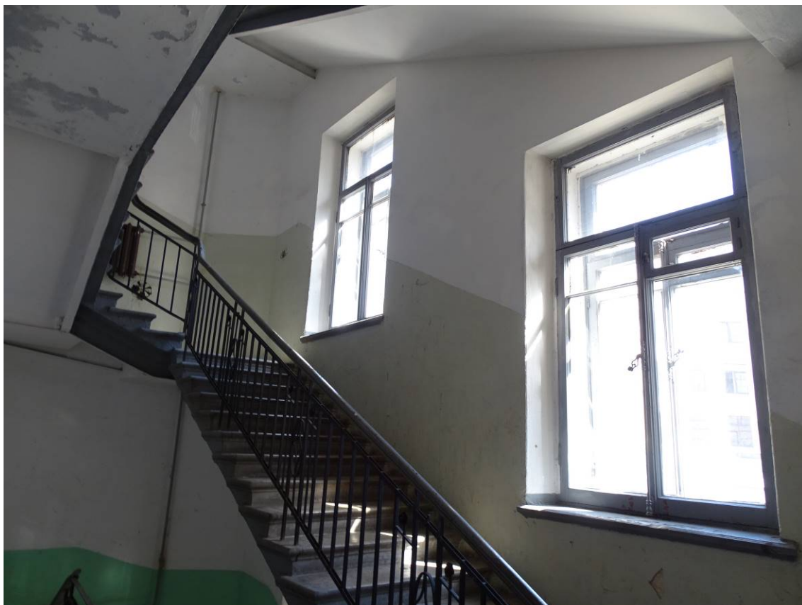
Фото 42. Лестница № 2. Площадка между 2 и 3 этажом. Съемка 26.04.2021 г. Трушковский В. Э.
