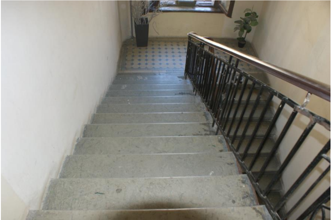
Фото 114. Лестница № 4. Площадка между 5 и 6 этажом. Съемка 26.04.2021 г. Трушковский В. Э.
