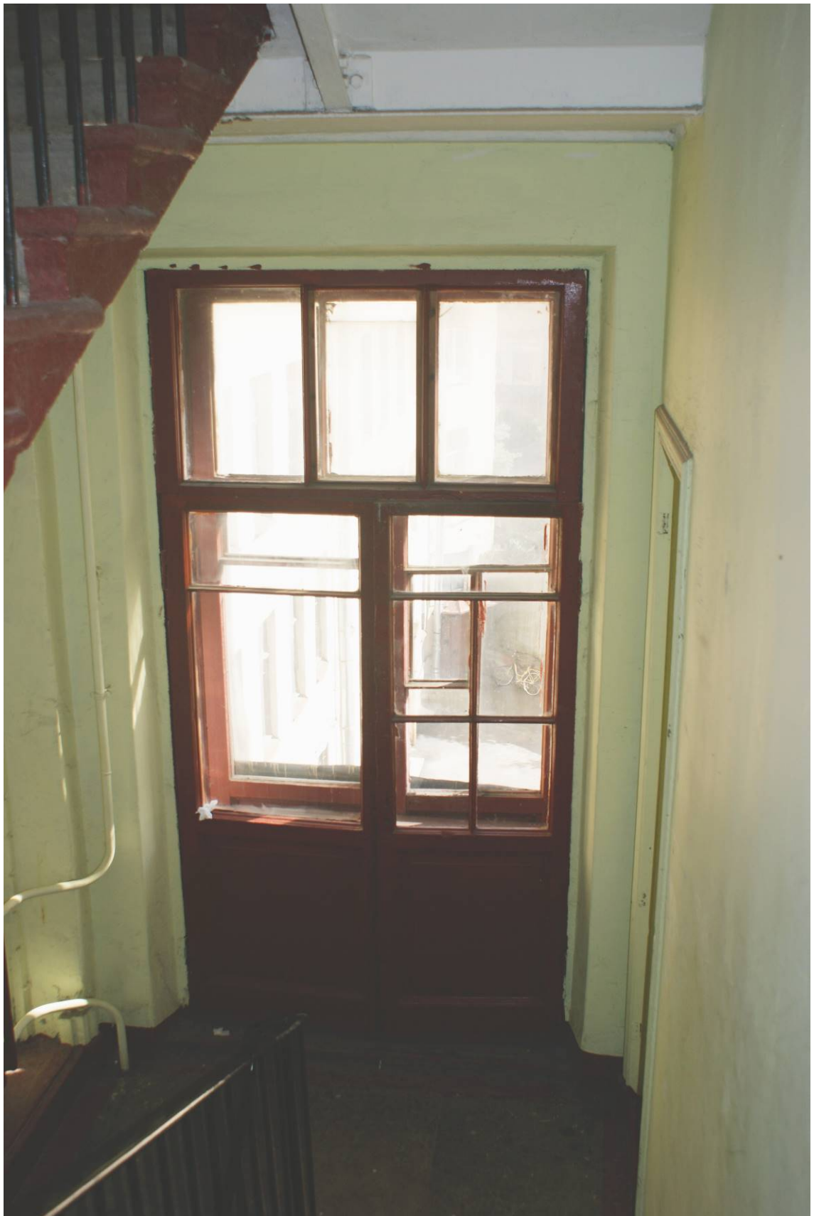
Фото 80. Лестница № 3. Площадка между 3 и 4 этажом. Съемка 26.04.2021 г. Трушковский В. Э.
