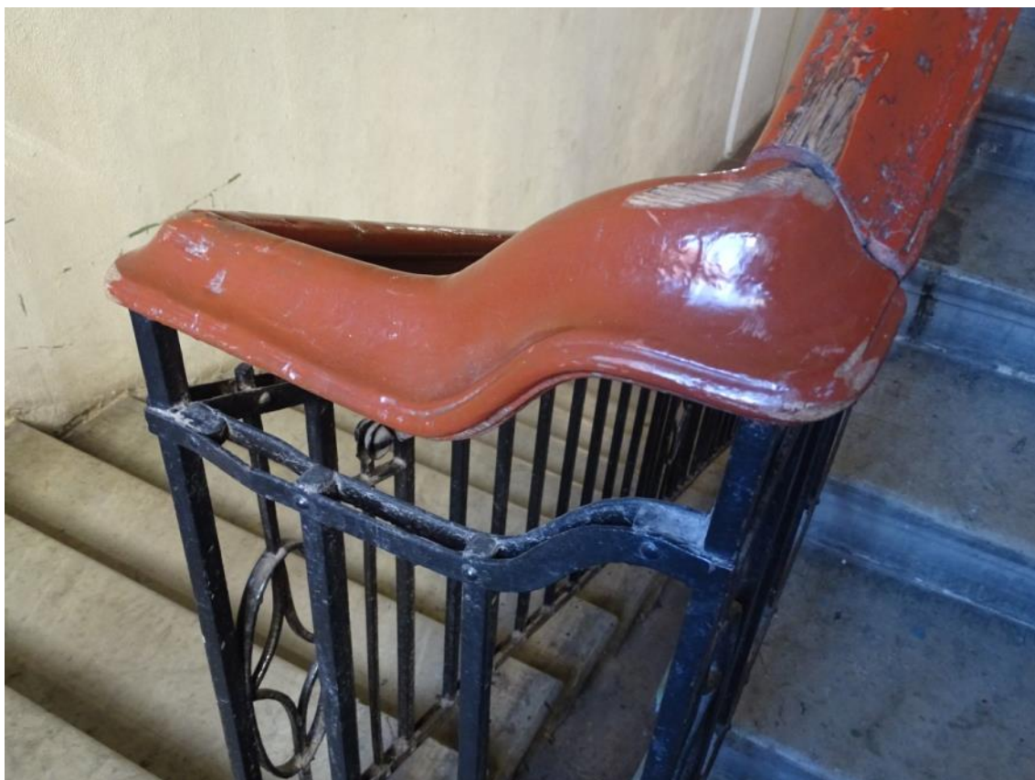
Фото 96. Лестница № 4. Площадка между 1 и 2 этажом. Фрагмент поручня ограждения лестничной клетки. Съемка 26.04.2021 г. Трушковский В. Э.
