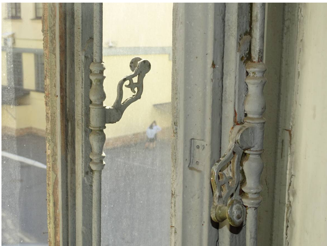
Фото 52. Лестница № 2. Оконная фурнитура. Съемка 26.04.2021 г. Трушковский В. Э.
