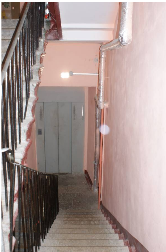
Фото 137. Лестница №6. Площадка между 5 и 6 этажом. Съемка 26.04.2021 г. Трушковский В. Э.
