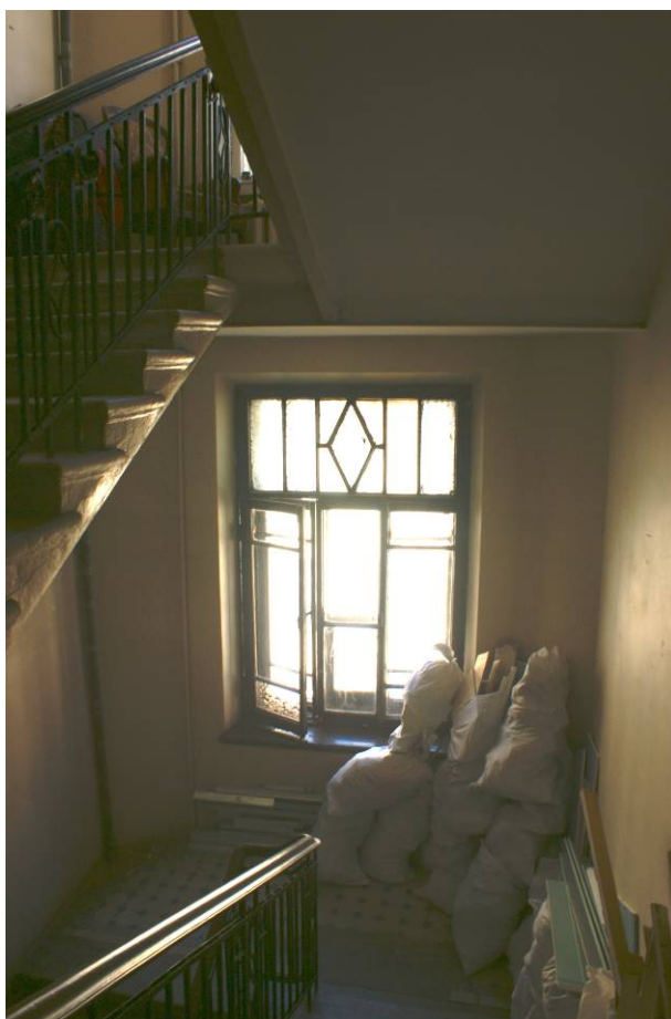
Фото 23. Лестница № 1. Площадка между 4 и 5 этажом. Съемка 26.04.2021 г. Трушковский В. Э.
