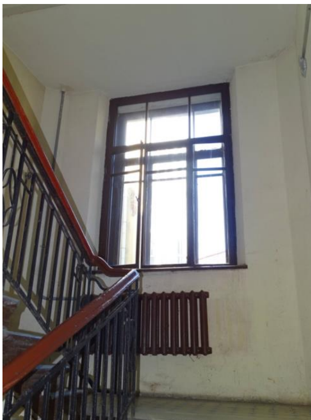
Фото 94. Лестница № 4. Площадка между 1 и 2 этажом. Съемка 26.04.2021 г. Трушковский В. Э.
