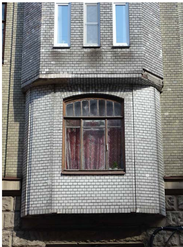
Фото 40. Фрагмент лицевого фасада. Эркер. 2-й этаж. Съемка 26.04.2021 г. Трушковский В.Э.
