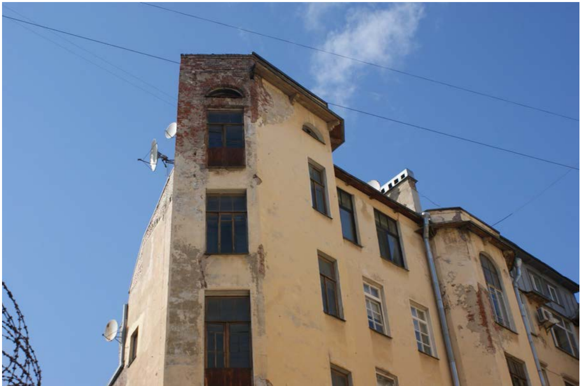
Фото 54. Фрагмент западного фасада западного внутреннего двора. 4-й, 5-й, 6-й этаж. Съемка 26.04.2021 г. Трушковский В.Э.
