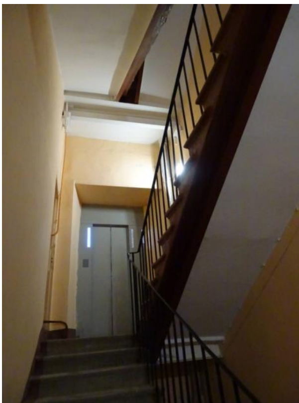
Фото 130. Лестница №6. Площадка между 2 и 3 этажом. Съемка 26.04.2021 г. Трушковский В.Э
