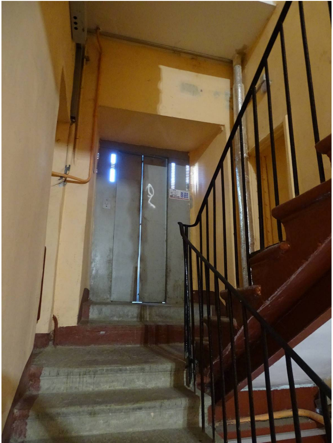
Фото 125. Лестница №6. Площадка между 1 и 2 этажом. Съемка 26.04.2021 г. Трушковский В.Э
