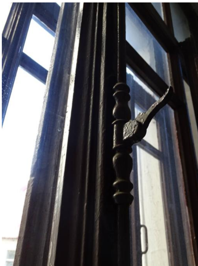
Фото 102. Лестница № 4. Оконная фурнитура. Съемка 26.04.2021 г. Трушковский В. Э.
