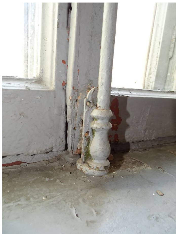
Фото 53. Лестница № 2. Оконная фурнитура. Съемка 26.04.2021 г. Трушковский В. Э.
