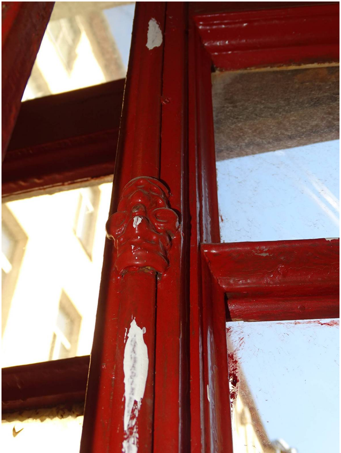
Фото 90. Лестница № 3. Оконная фурнитура. Съемка 26.04.2021 г. Грушковский В. Э.
