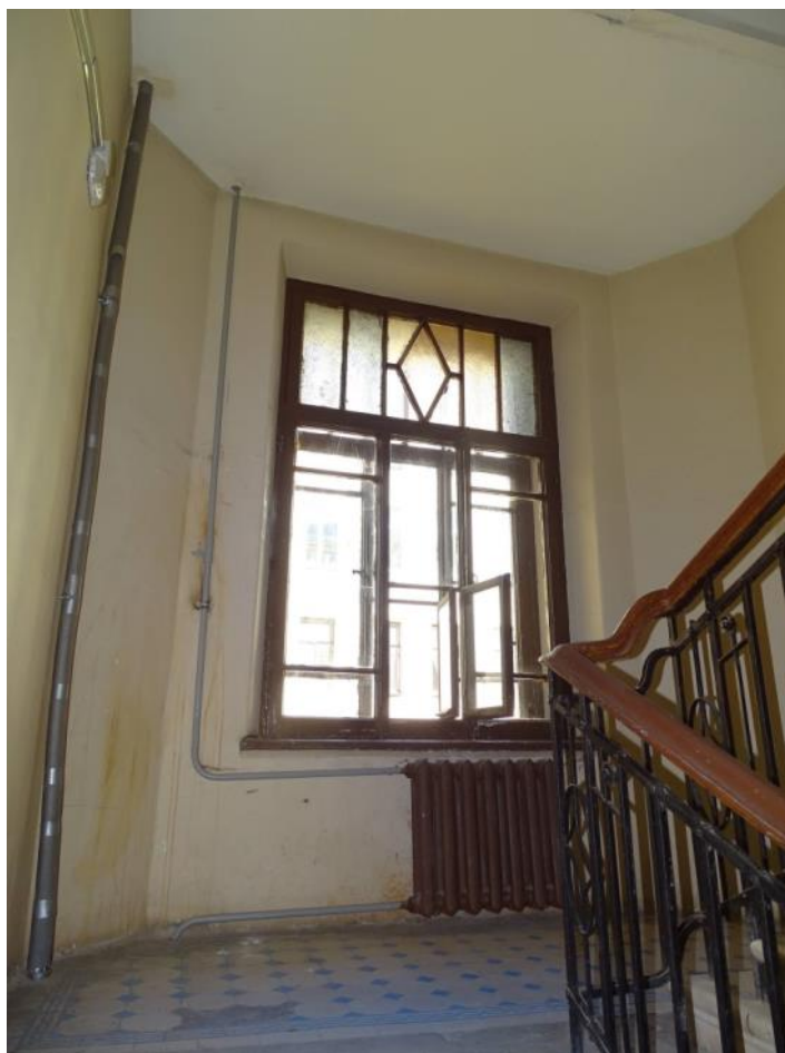
Фото 17. Лестница № 1. Площадка между 3 и 4 этажом. Съемка 26.04.2021 г. Трушковский В. Э.
