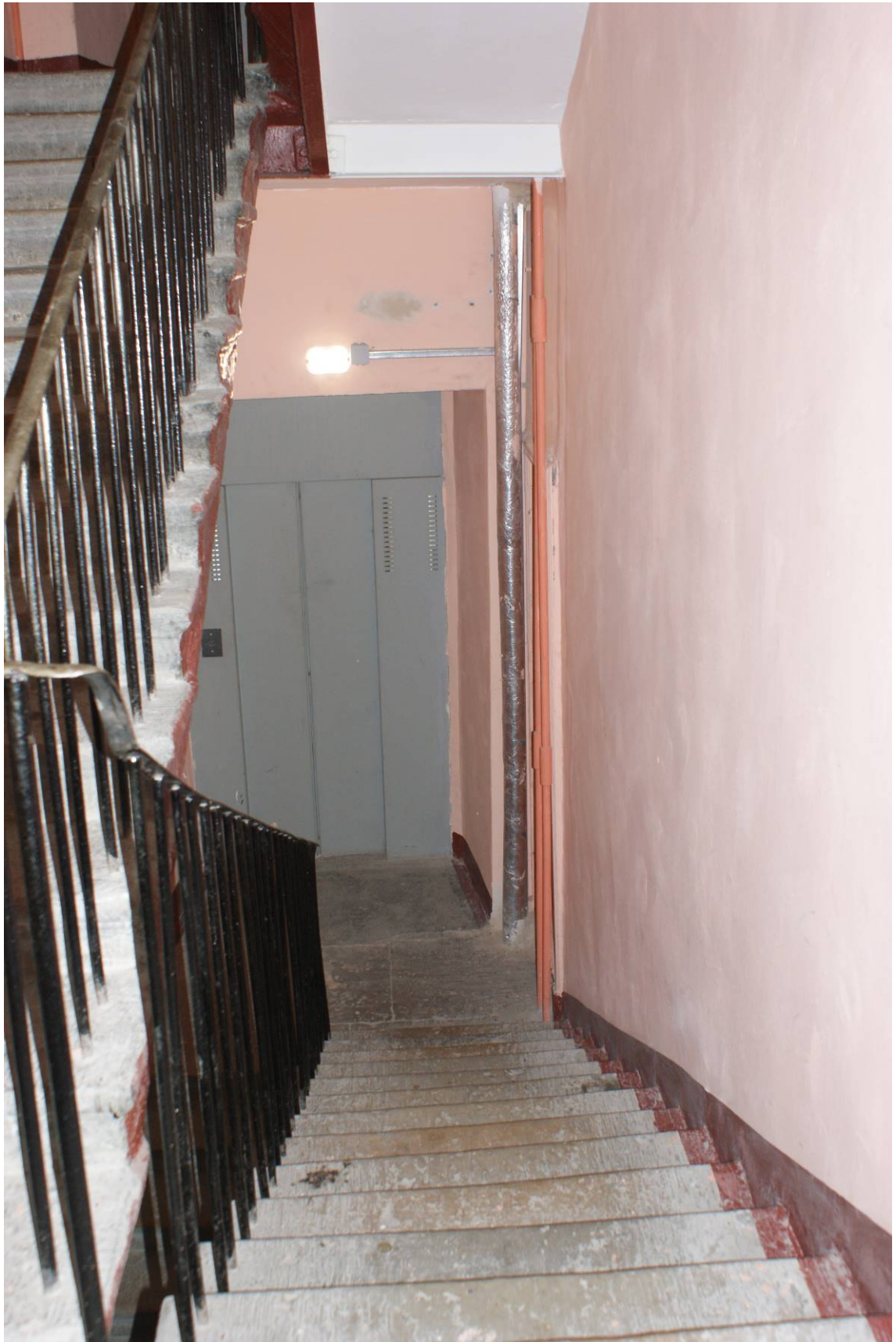
Фото 135. Лестница №6. Площадка между 4 и 5 этажом. Съемка 26.04.2021 г. Трушковский В.Э
