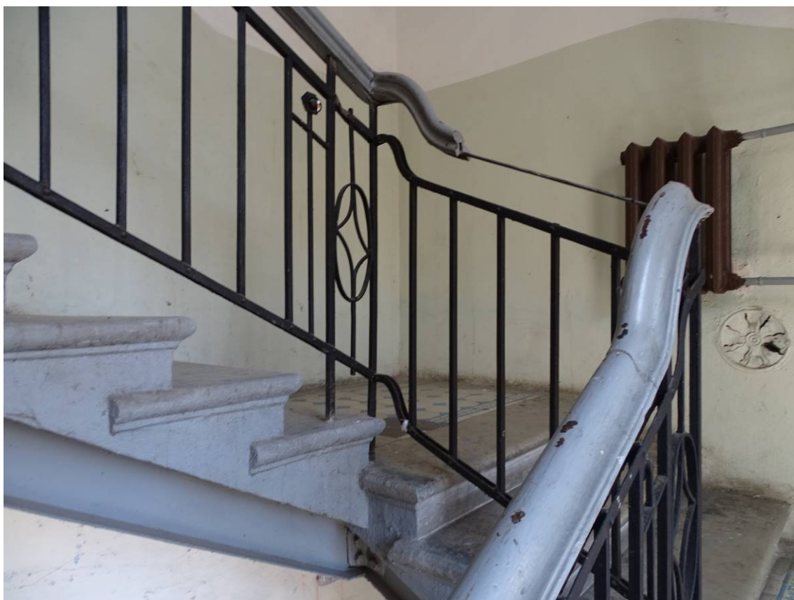
Фото 47 Лестница № 2. Площадка между 3 и 4 этажом. Съемка 26.04.2021 г. Трушковский В. Э.
