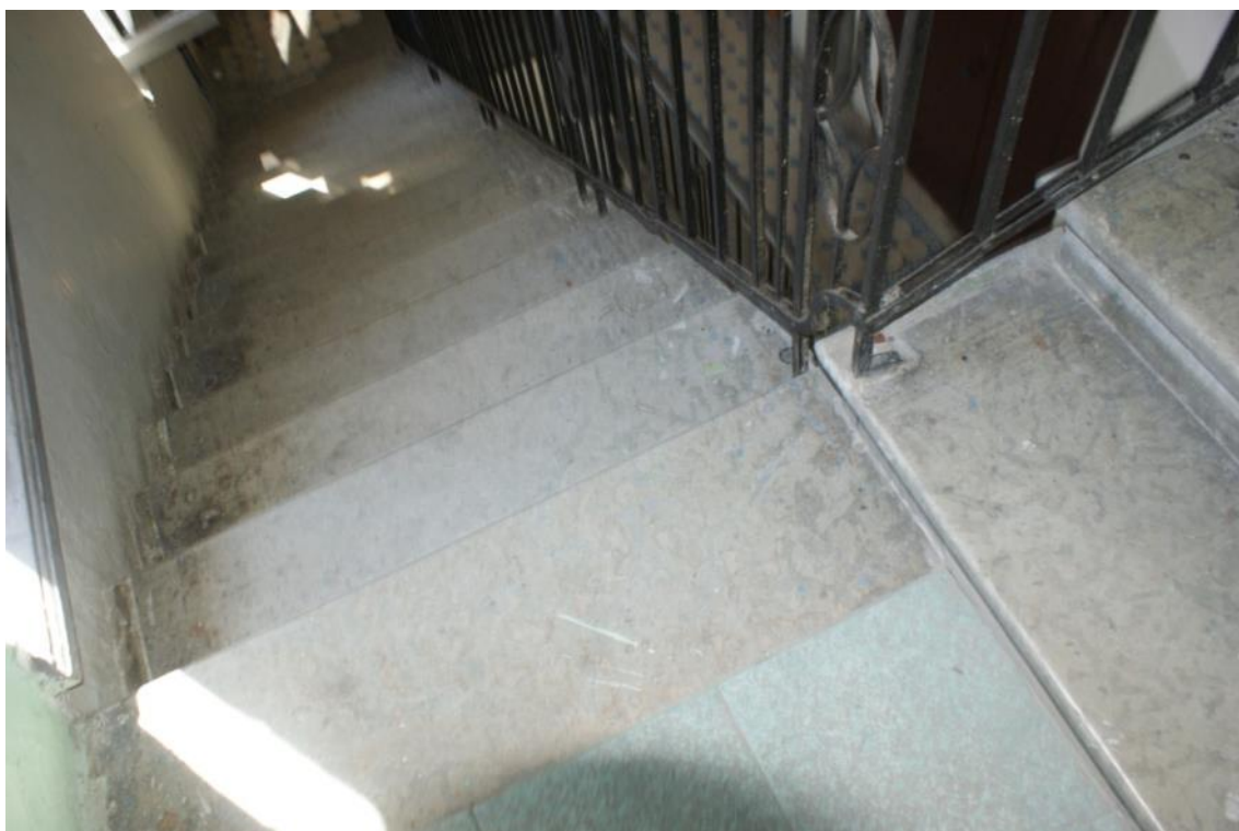
Фото 55. Лестница № 2. Площадка между 4 и5 этажом. Съемка 26.04.2021 г. Трушковский В. Э.
