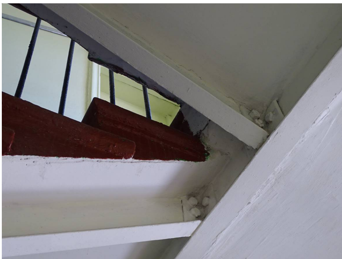
Фото 75. Лестница № 3. Площадка между 1 и 2 этажом. Съемка 26.04.2021 г. Трушковский В. Э.
