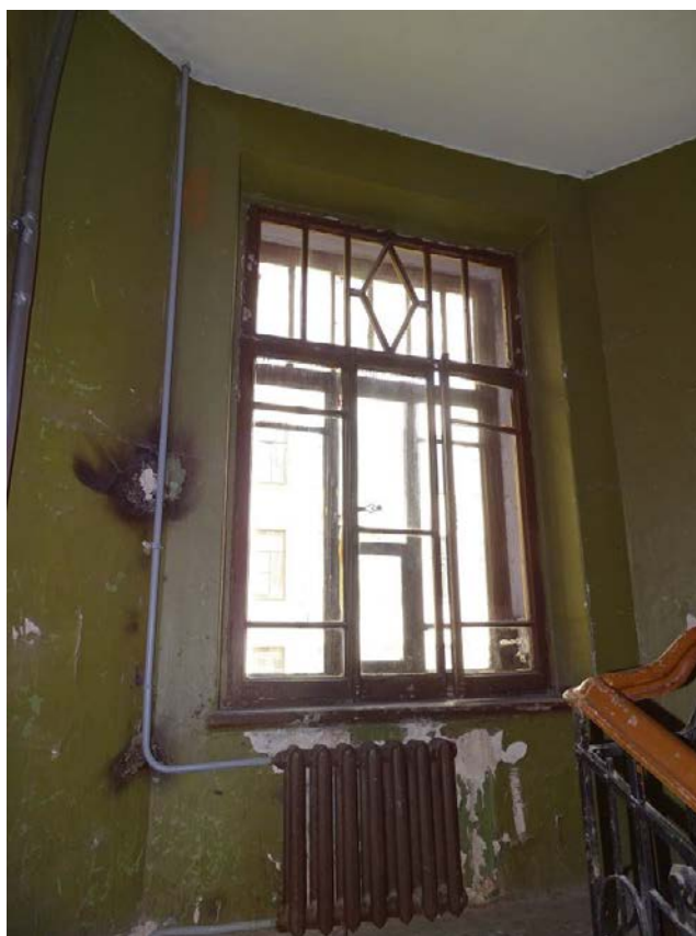
Фото 15. Лестница № 1. Площадка между 2 и 3 этажом. Съемка 26.04.2021 г. Трушковский В. Э.
