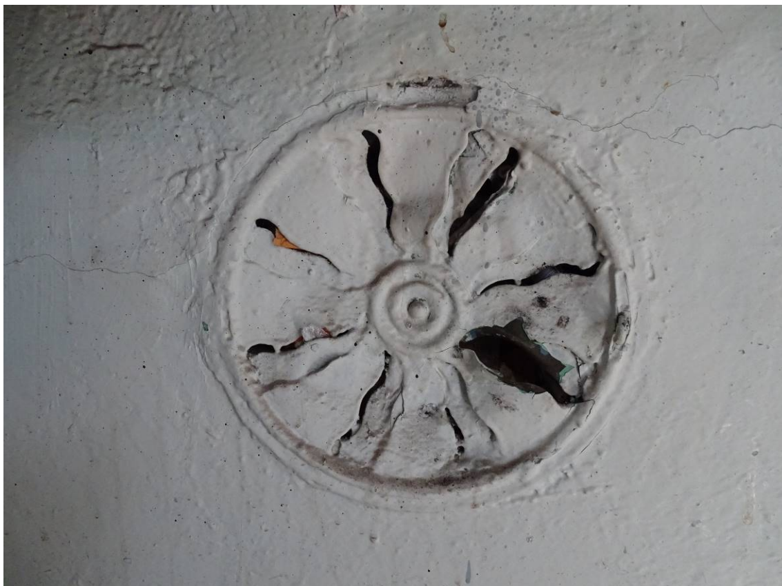
Фото 48. Лестница № 2. Площадка между 3 и 4 этажом. Декоративное оформление отверстия в толще стены. Съемка 26.04.2021 г. Трушковский В. Э.
