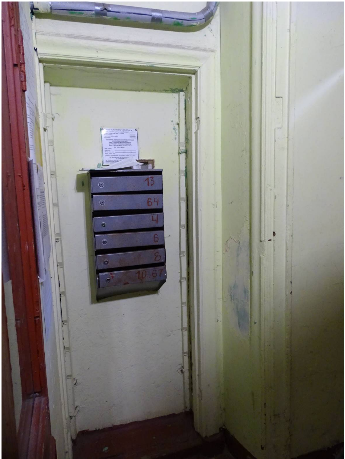
Фото 71. Лестница № 3. 1 этаж. Ниша при входе в парадную. Съемка 26.04.2021 г. Трушковский В. Э.
