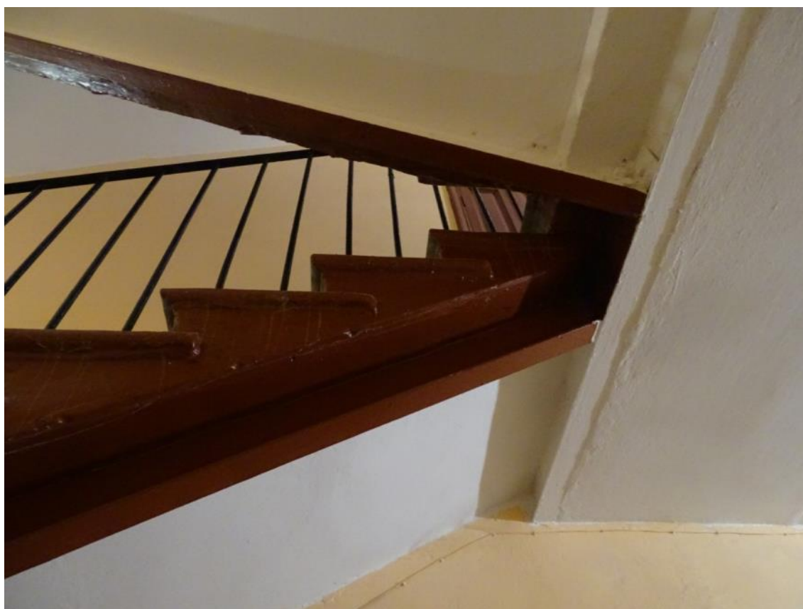
Фото 127. Лестница №6. Примыкание лестничных маршей к площадке между 1 и 2 этажом. Съемка 26.04.2021 г. Трушковский В.Э
