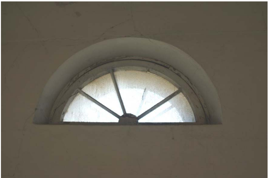
Фото 69. Лестница № 2. 6 этаж. Оконный проем. Съемка 26.04.2021 г. Трушковский В. Э.
