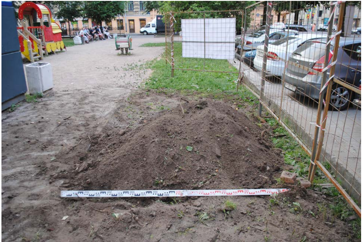
Рис. 51. Санкт-Петербург, сквер б/н на пересечении ул. Некрасова и ул. Маяковского. Шурф 1. Фотофиксация после рекультивации. Вид на север
