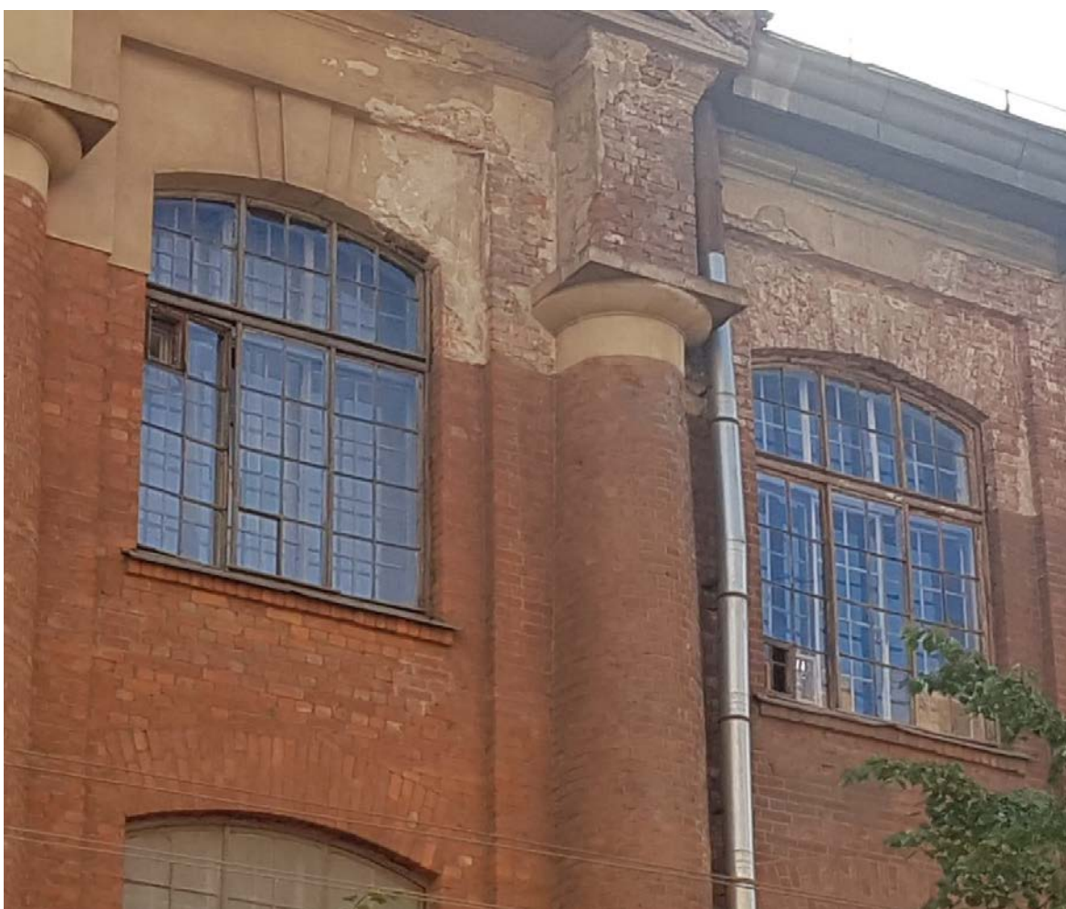
Фото 10. Лицевой фасад по ул. Гатчинская. Расстекловка окон в уровне 3-го этажа.
