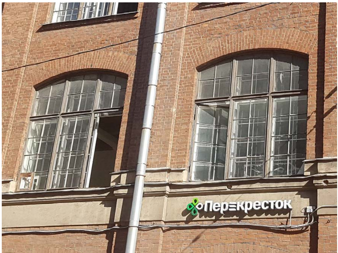
Фото 4. Лицевой фасад по Чкаловскому пр. Расстекловка окон в уровне 2-го этажа.
