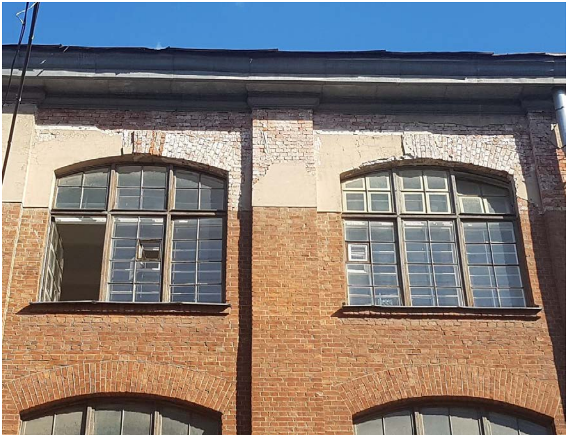
Фото 3. Лицевой фасад по Чкаловскому пр. Расстекловка окон в уровне 3-го этажа.
