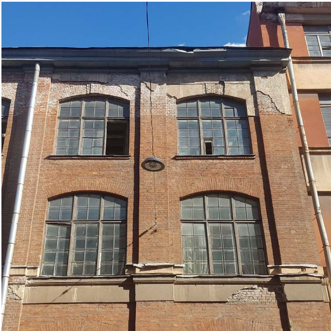
Фото 2. Лицевой фасад по Чкаловскому пр. Дефекты отделки в уровне 2 и 3 этажей.
