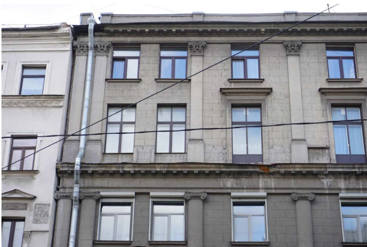
12. Дом Г.А. Бурмистрова. Ул. Куйбышева, д.3, лит.А. Фрагмент лицевого фасада в уровне 5-6 этажей.
