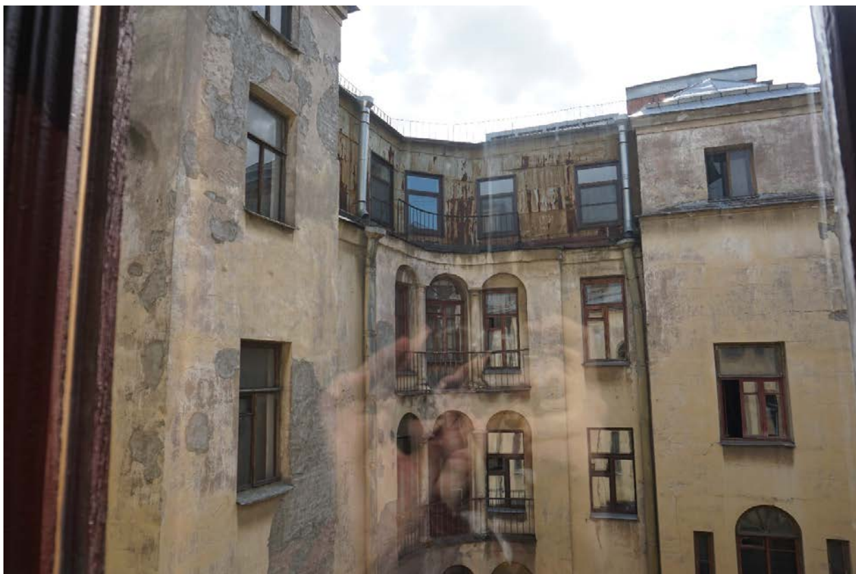
40. Дом Г.А. Бурмистрова. Ул. Куйбышева, д.3, лит.А. Фрагмент крыши и мансарды заднего корпуса, вид из окна парадной лестницы.
