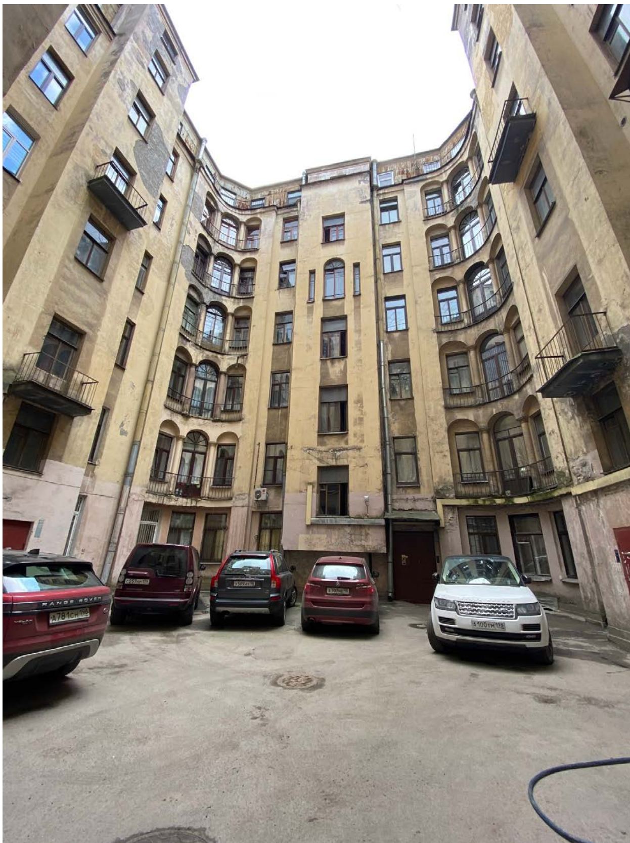
14. Дом Г.А. Бурмистрова. Ул. Куйбышева, д.3, лит.А. Вид на фасад заднего корпуса.
