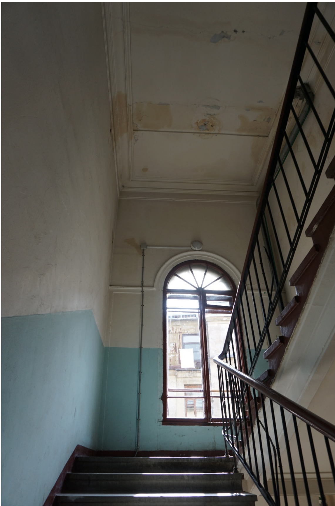
38. Дом Г.А. Бурмирова. Ул. Куйбышева, д.3, лит.А. Вид на площадку между 5 и 6 этажами парадной лестницы.
