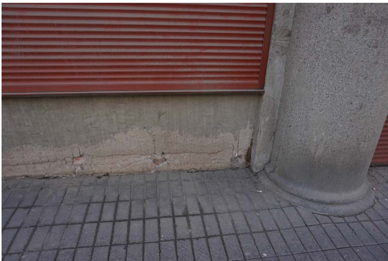
5. Дом Г.А. Бурмистрова. Ул. Куйбышева, д.3, лит.А. Фрагмент цоколя и полуколонны лицевого фасада.
