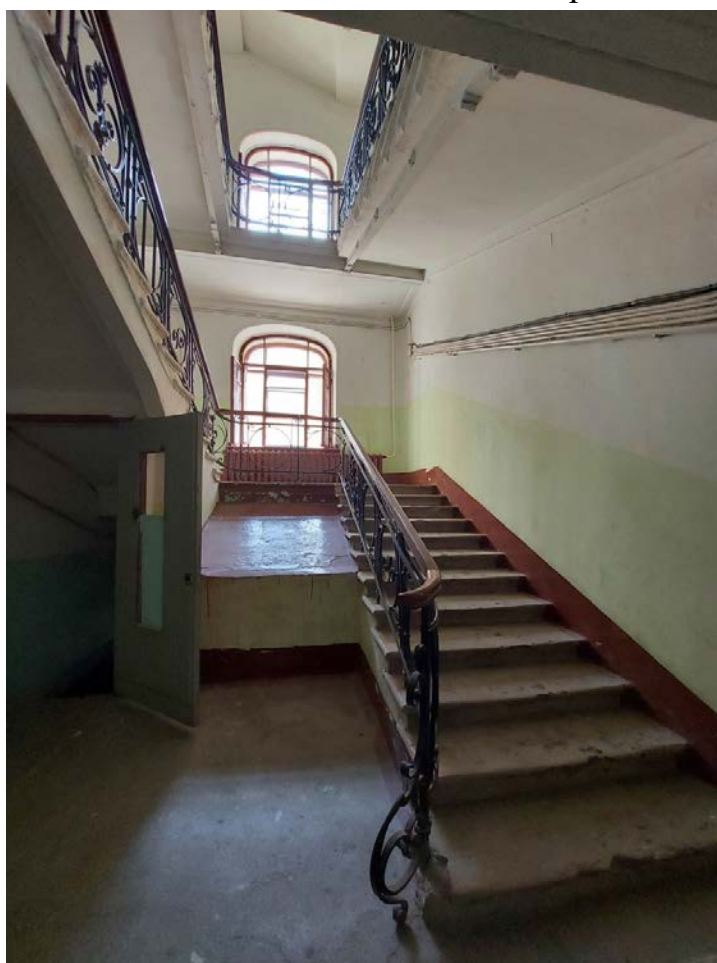
Фото 52. Общий вид ЗЛК.
