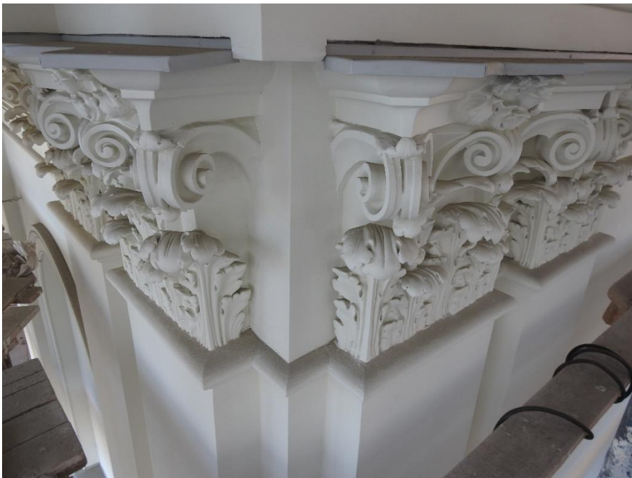
8. «Часовня, 1894 г., гражд. инж. Кондратьев С.П.», входящая в состав объекта культурного наследия федерального значения «Собор Троицкий (Измайловский)», Измайловский пр., д.4-а, лит. А, д.7-а, лит. А. Западный фасад. Фрагмент. Фото 26.04.2022г.
