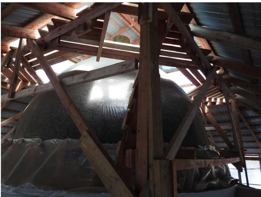
3. «Часовня, 1894 г., гражд. инж. Кондратьев С.П.», входящая в состав объекта культурного наследия федерального значения «Собор Троицкий (Измайловский)», Измайловский пр., д.4-а, лит. А, д.7-а, лит. А. Купол. Общий вид. Фото 26.04.2022г.
