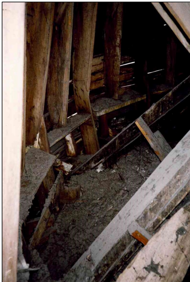
46. Часовня в ходе восстановления. Вид купола изнутри. Кружала в нижней части купола. / Заключение о техническом состоянии часовни собора Святой Животворящей Троицы Лейб-Гвардии Измайловского полка. ПК «СТРОЙДИАГНОЗ». - СПб, 1998.
