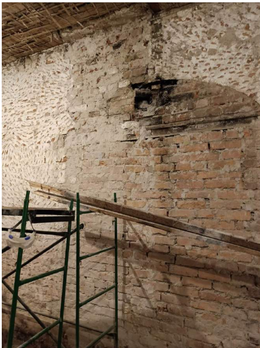
19. Казарма Офицерской стрелковой школы по адресу: г. Ломоносов, Владимирская ул., 15 Фрагмент интерьера 1-го этажа. Состояние кладки стены. Фото: 01.06.2022.
