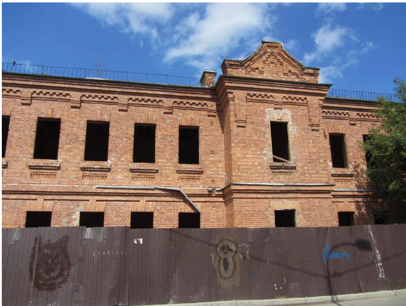
2. Казарма Офицерской стрелковой школы по адресу: г. Ломоносов, Владимирская ул., 16а. Фрагмент южного фасада. Восточная часть, восточный ризалит. Фото: 01.06.2022.
