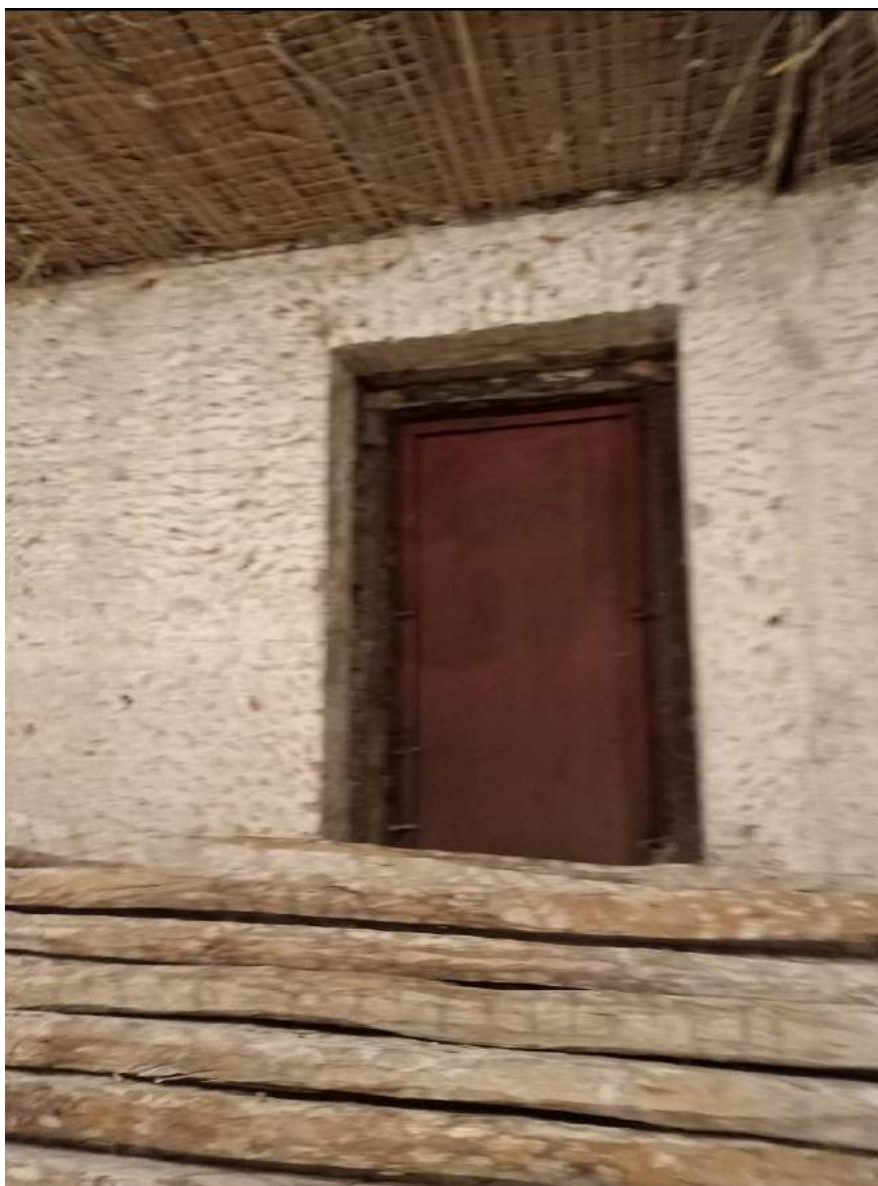
17. Казарма Офицерской стрелковой школы по адресу: г. Ломоносов, Владимирская ул., 15 Фрагмент интерьера 1-го этажа. Клинчатая перемычка оконных проемов. Фото: 01.06.2022.
