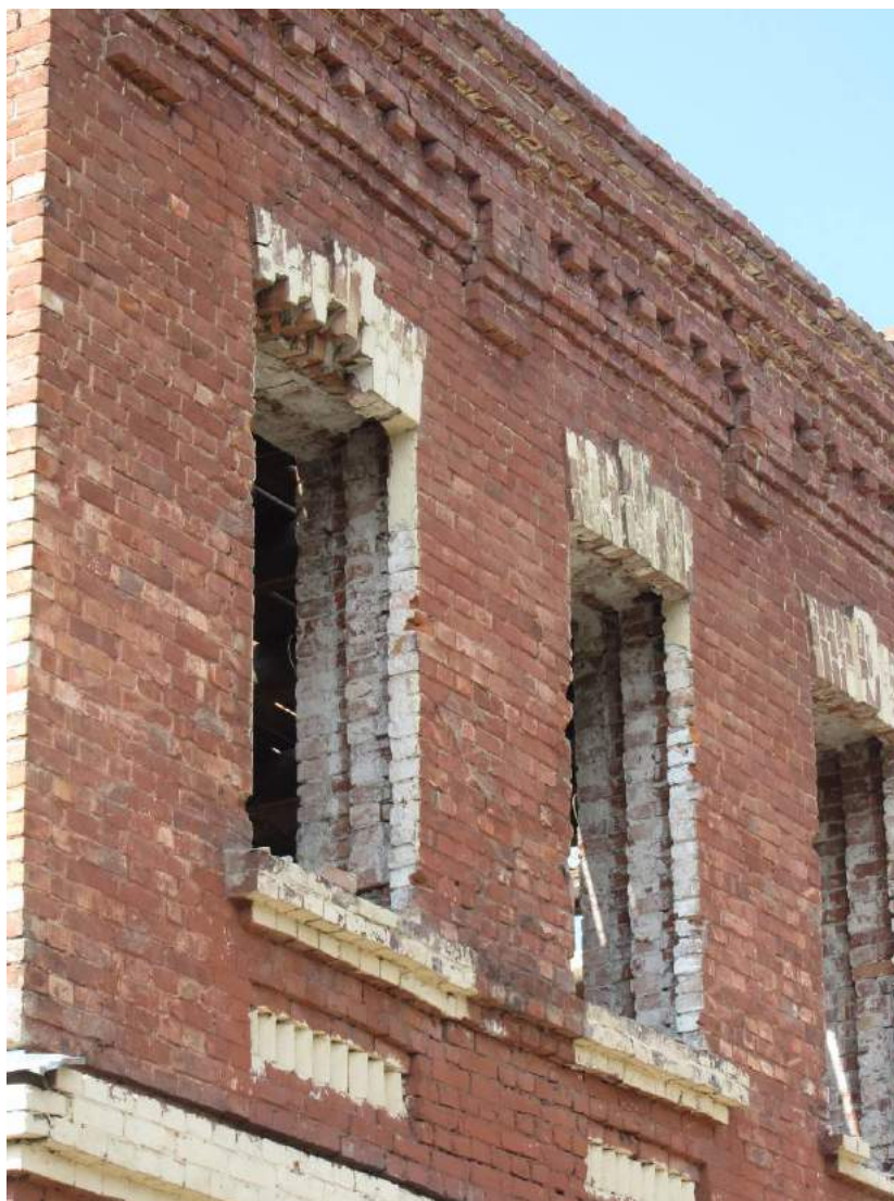
6. Казарма Офицерской стрелковой школы по адресу: г. Ломоносов, Владимирская ул., 16. Фрагмент дворового фасада: оконные проёмы 2-го этажа. Фото: 01.06.2022.
