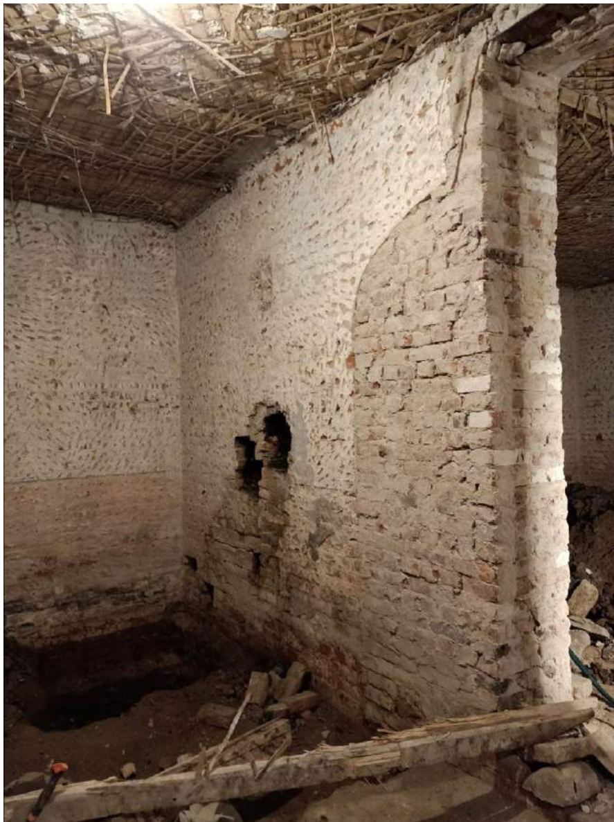
18. Казарма Офицерской стрелковой школы по адресу: г. Ломоносов, Владимирская ул., 15 Фрагменты торцевого фасада здания Фрагмент интерьера 1-го этажа. Состояние кладки стены.
