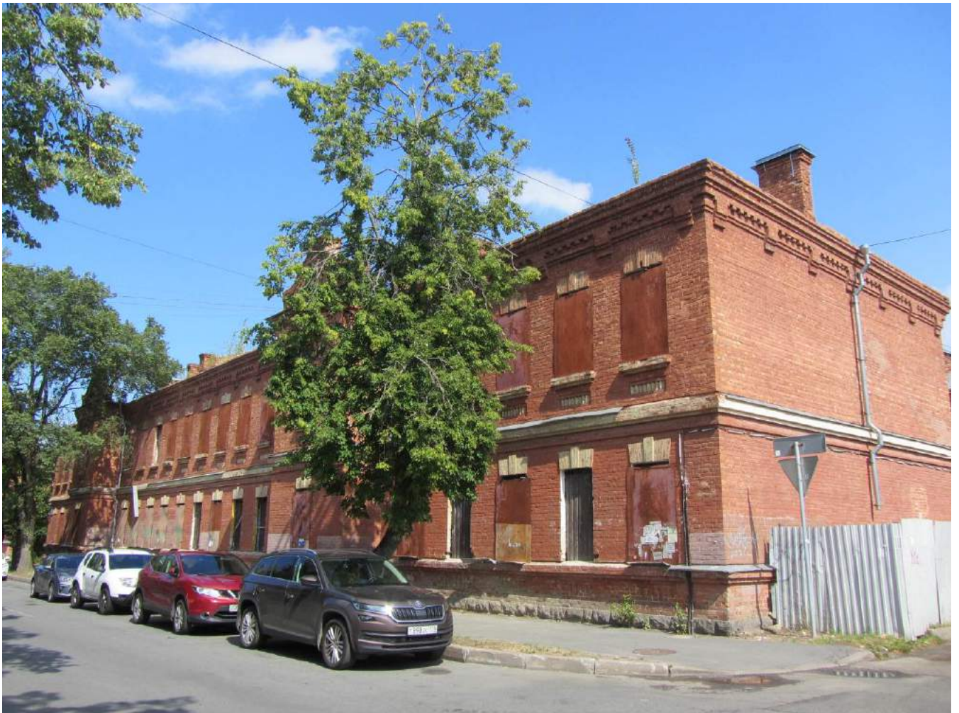
1. Казарма Офицерской стрелковой школы по адресу: г. Ломоносов, Владимирская ул., 16. Общий вид «казармы» с юго-запада. Фото: 01.06.2022.
