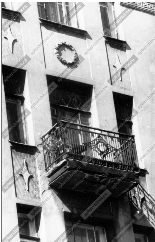
17. Вид балкона на фасаде жилого дома № 58 по 9-й линии Васильевского острова. 12 июня 1987 г. ЦГАКФФД СПб Ар 217322
