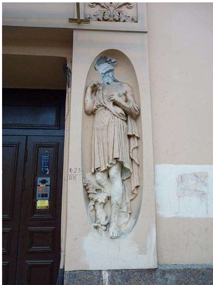
Илл.70. Фрагмент фасада. Последствия вандализма. Фото - BABIRA66, 12.2019. (Источник: https://p2.citywalls.ru/photo_414-424786.jpg?mt=1576936133 )
