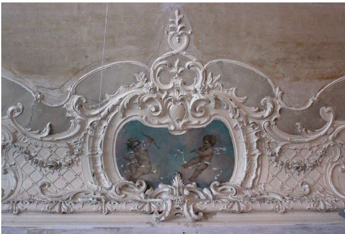
Илл.45. Левая парадная. Квартиры. На 3 этаже. Фото Олега Еверзова, 04.2017. (Источник: https://p0.citywalls.ru/photo_382-391168.jpg?mt=1555106146 )
