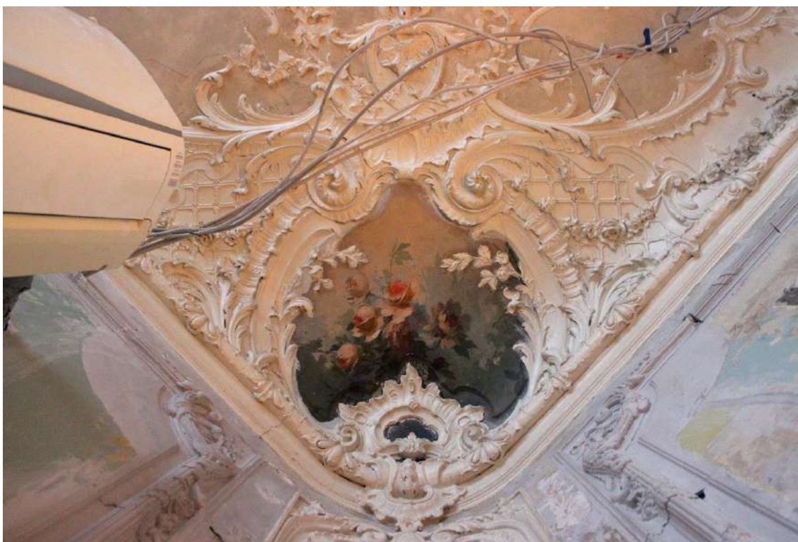
Илл.46. Левая парадная. Квартиры. На 3 этаже. Фото Олега Еверзова, 04.2017. (Источник: https://p3.citywalls.ru/photo_381-391167.jpg?mt=1555106142 )
