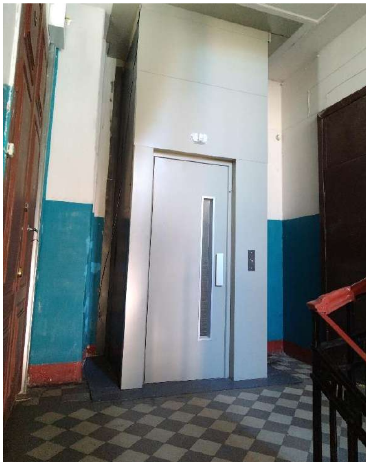
Фото №27. Парадная лестница №2. Лифт на четвертом этаже.
