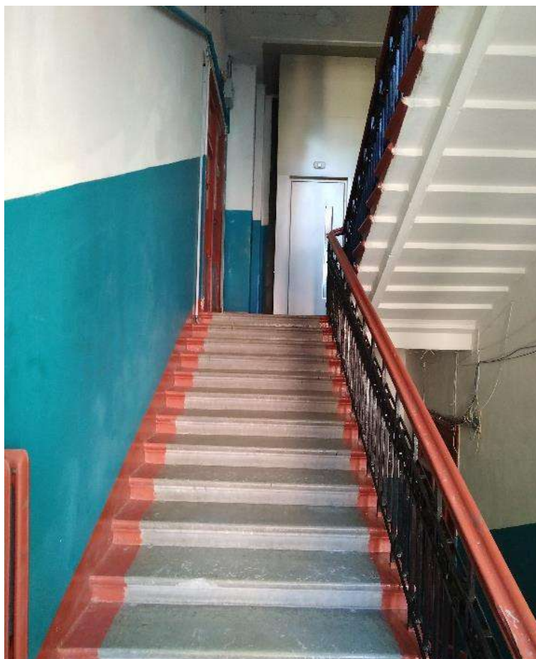
Фото №26. Парадная лестница №2. Лестничный марш, вид с междуэтажной площадки на четвертый этаж.
