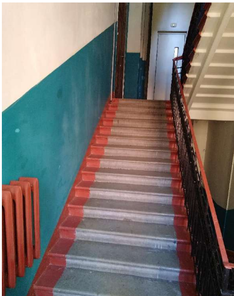
Фото №24. Парадная лестница №2. Лестничный марш, вид с междуэтажной площадки между 2 и 3 этажами.
