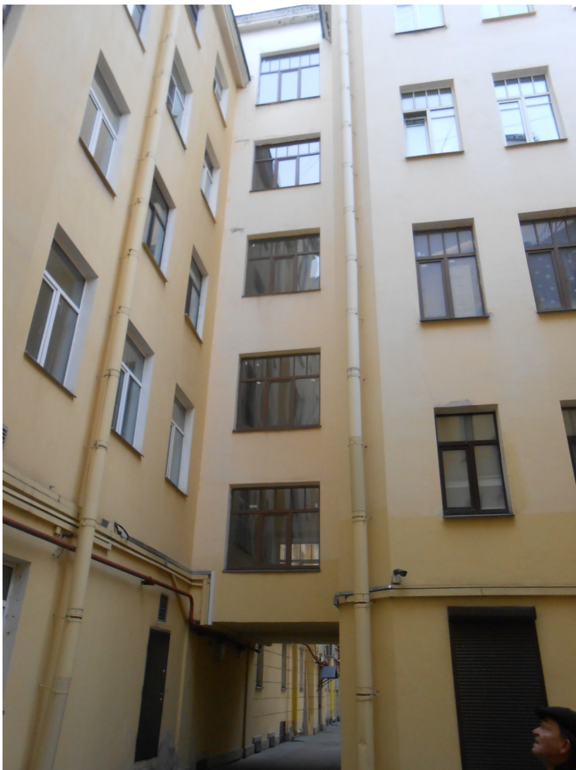
9. “Дом С.Н. Мартенса, А.Н. Тура, С.И. Тимашева”. Восстания ул., 3-5, лит. А. Дворовые фасады. Фрагмент. Фото: 01.11.2022.
