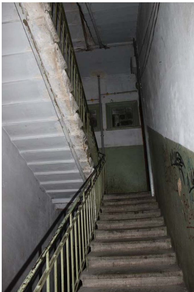
Фото 240. Лестница № 1 (двор): Лестничный марш на площадку 3-го этажа. Съемка 26.04.2021 г. Кириков Б. М.
