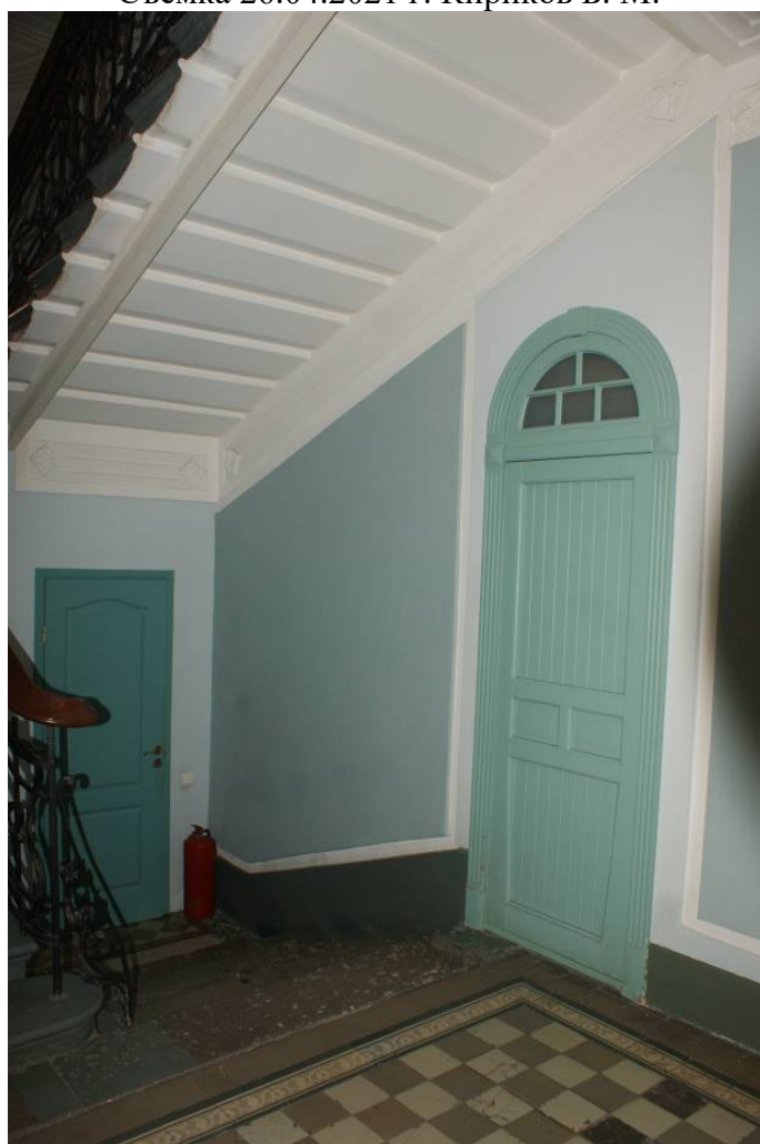
Фото 191. Лестница № 1: Вестибюль. 1-го этажа. Пространство под лестницей. Съемка 26.04.2021 г. Кириков Б. М.
