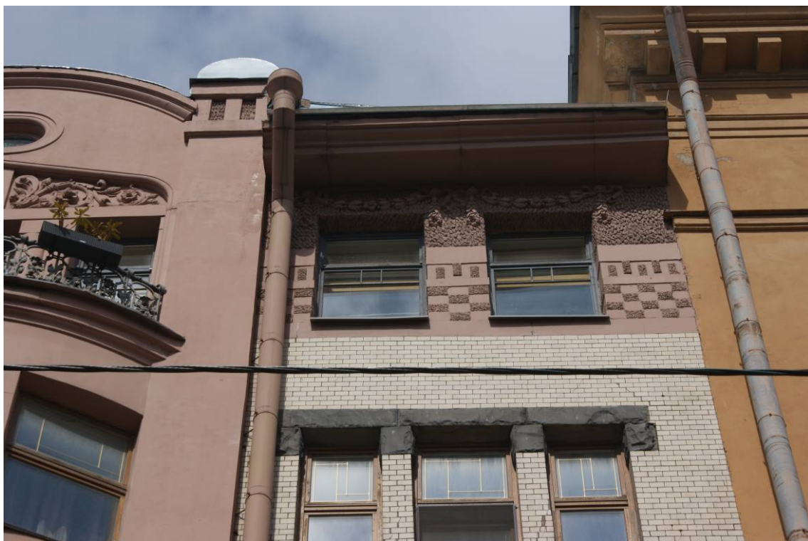
Фото 82. Фрагмент лицевого фасада с ул. Захарьевской. Оформление оконных проемов. 6-й этаж. Съемка 26.04.2021 г. Кириков Б. М.
