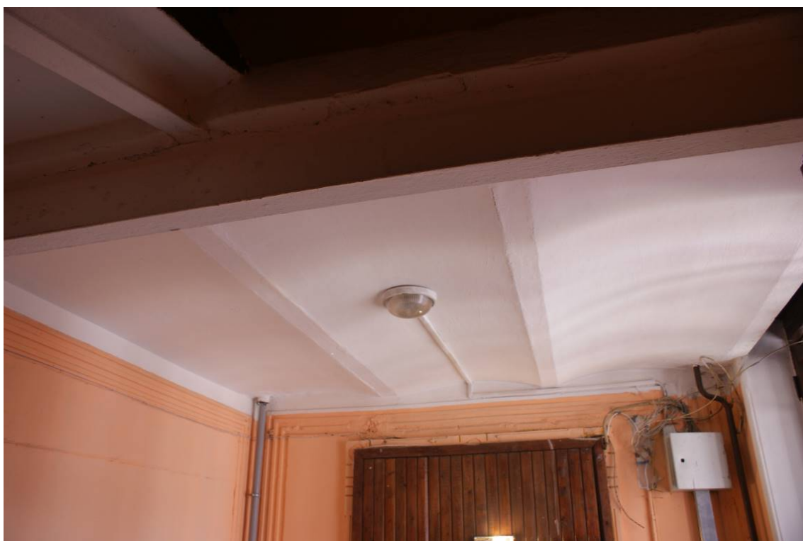
Фото 222. Лестница № 6: Площадка между 5-м и 6-м этажом. Цилиндрические сводики. Съемка 26.04.2021 г. Кириков Б. М.
