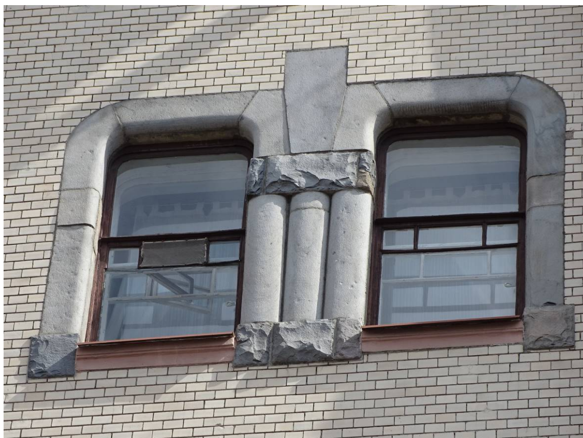
Фото 65. Фрагмент лицевого фасада с пр. Чернышевского. 5-й этаж. Съемка 26.04.2021 г. Кириков Б. М.
