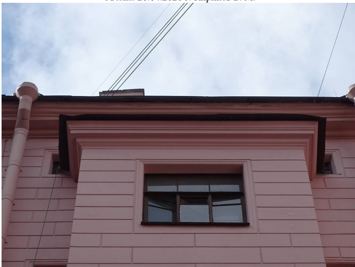
Фото 110. Фрагмент западного фасада внутреннего двора. Эркер. 6-й этаж. Съемка 26.04.2021 г. Кириков Б. М.
