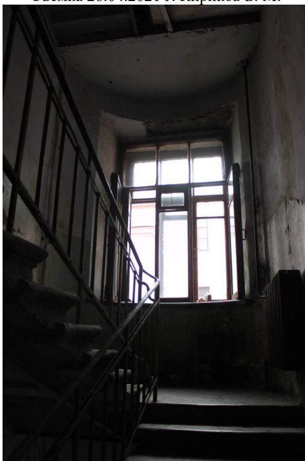
Фото 245. Лестница № 1 (двор): Площадка между 4-м и 5-м этажом. Съемка 26.04.2021 г. Кириков Б. М.
