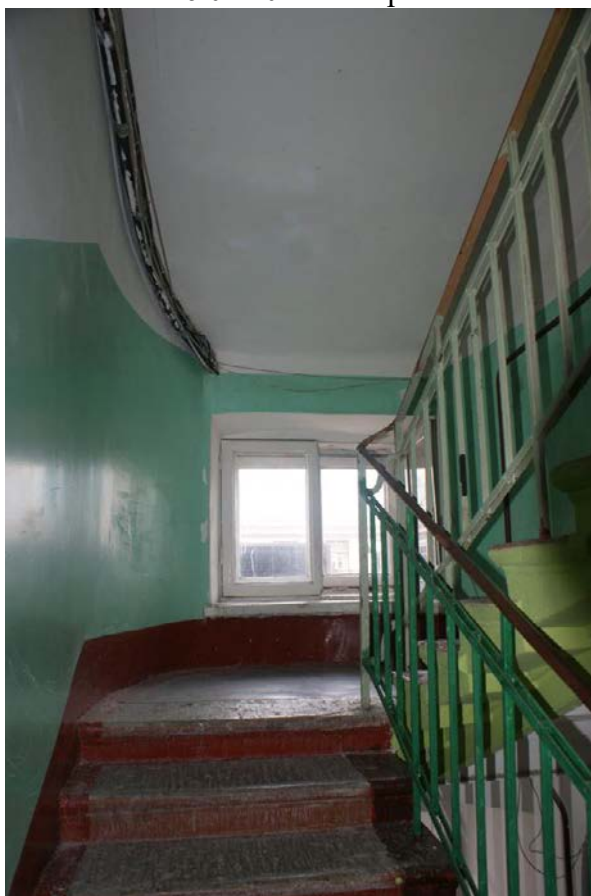
Фото 323. Лестница № 3: Площадка между 6-м и 7-м этажом. Съемка 26.04.2021 г. Кириков Б. М.
