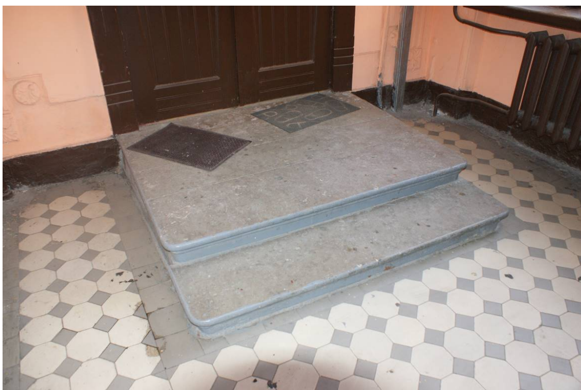
Фото 218. Лестница № 6: Площадка между 4-м и 5-м этажом. Покрытие пола. Ступени к квартире. Съемка 26.04.2021 г. Кириков Б. М.
