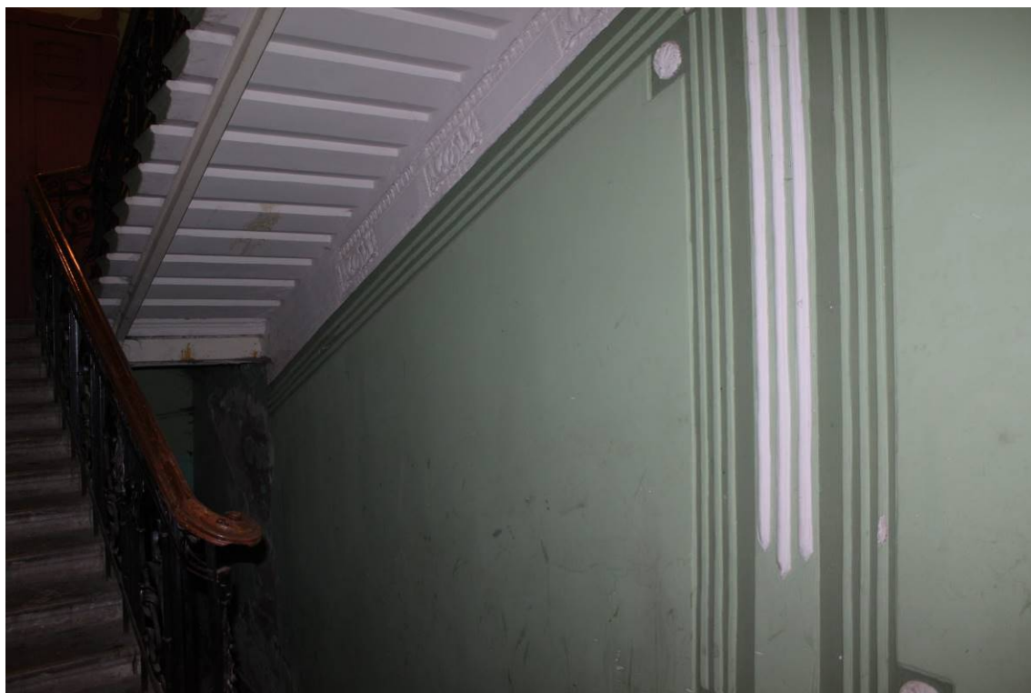
Фото 264. Лестница № 2: Площадка 1-го этажа. Пространство под лестницей. Съемка 26.04.2021 г. Кириков Б. М.
