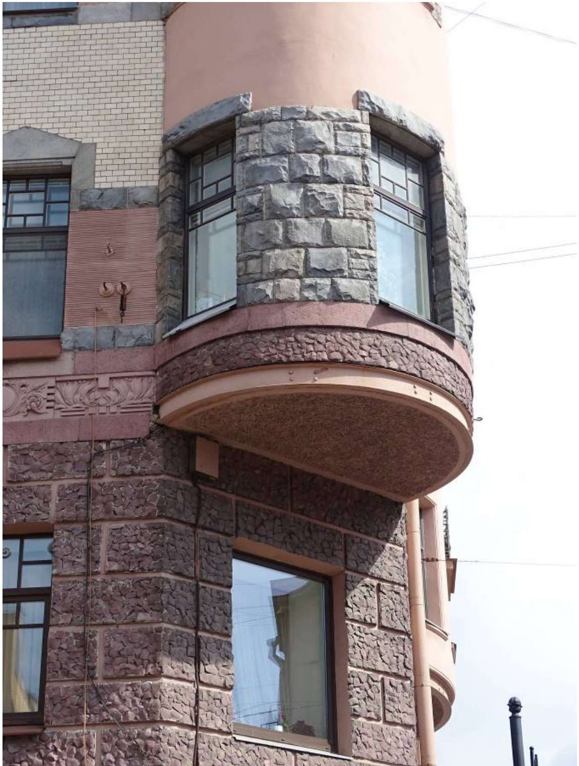
Фото 79. Фрагмент лицевого фасада с пр. Чернышевского. Угловой эркер. 2-й и 3-й этажи. Съемка 26.04.2021 г. Кириков Б. М.
