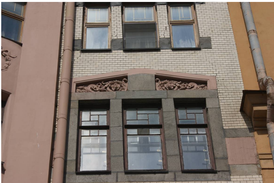
Фото 83. Фрагмент лицевого фасада с ул. Захарьевской. Оформление оконных проемов. 4-й этаж. Съемка 26.04.2021 г. Кириков Б. М.
