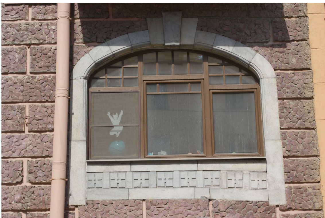
Фото 85. Фрагмент лицевого фасада с ул. Захарьевской. Оформление оконного проема. 2-й этаж. Съемка 26.04.2021 г. Кириков Б. М.
