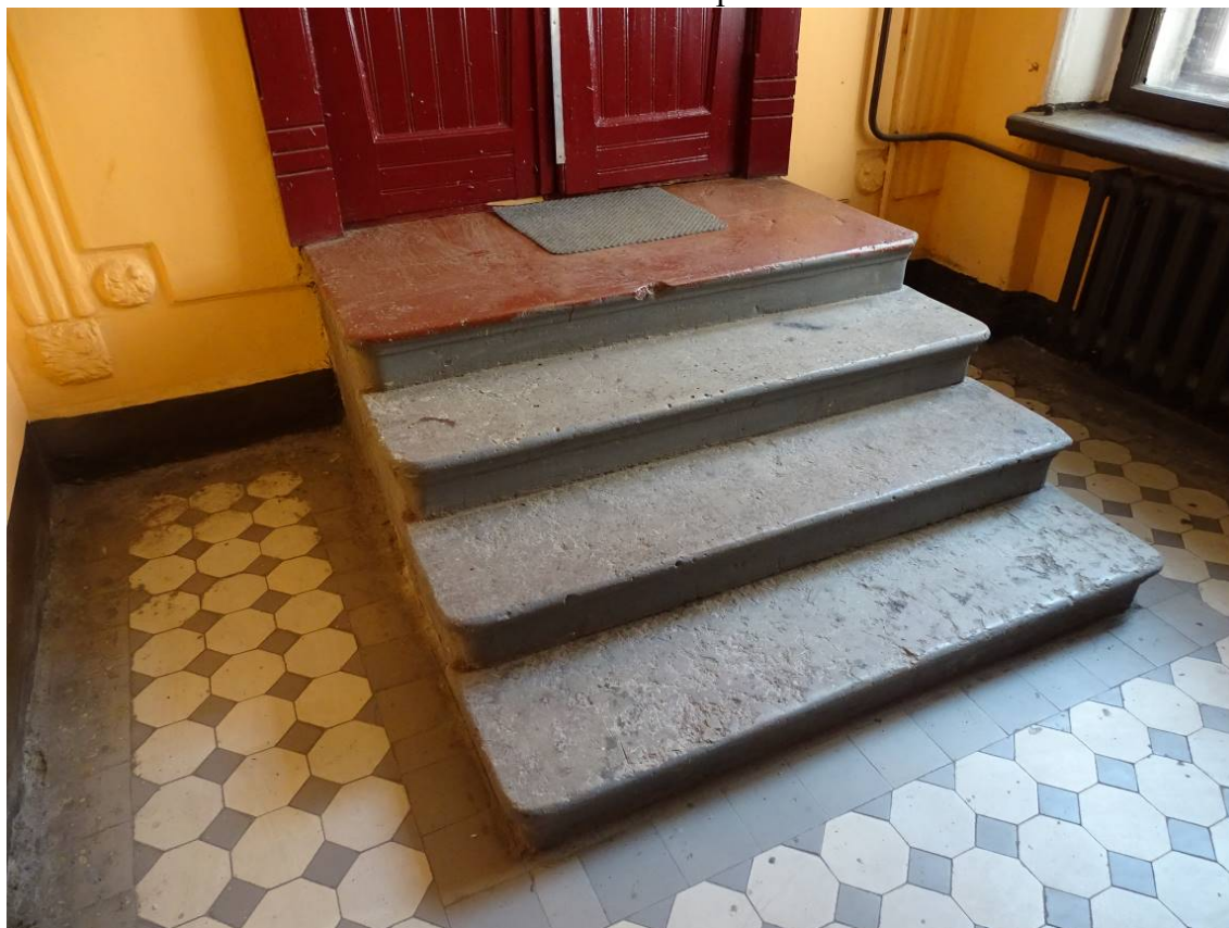
Фото 192. Лестница № 6: Площадка между 1-м и 2-м этажом. Ступени к квартире. Съемка 26.04.2021 г. Кириков Б. М.
