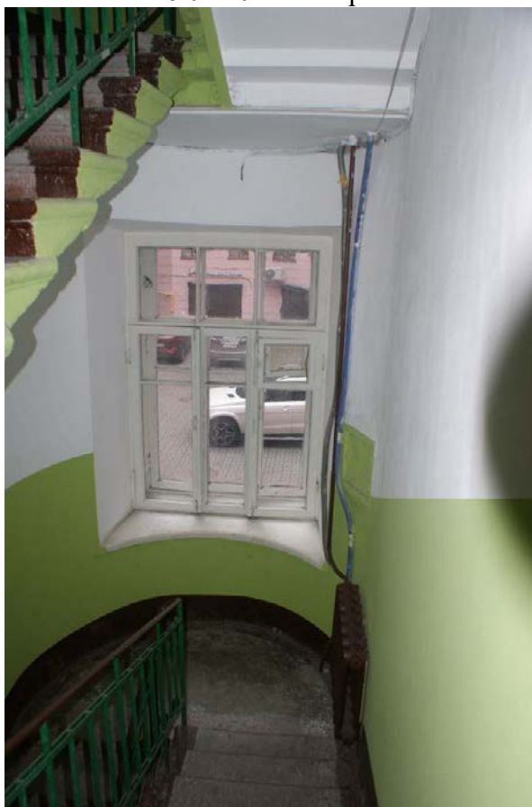
Фото 307. Лестница № 3: Площадка между 1-м и 2-м этажом. Съемка 26.04.2021 г. Кириков Б. М.
