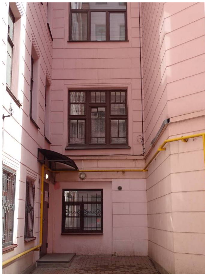
Фото 105. Фрагмент восточного фасада внутреннего двора. 1-й и 2-й этажи. Съемка 26.04.2021 г. Кириков Б. М.
