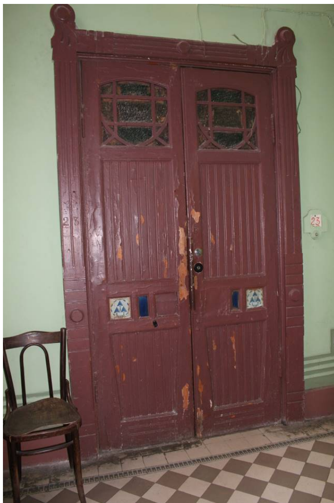
Фото 293. Лестница № 2: Площадка между 5-м и 6-м этажом. Оформление двери. Съемка 26.04.2021 г. Кириков Б. М.
