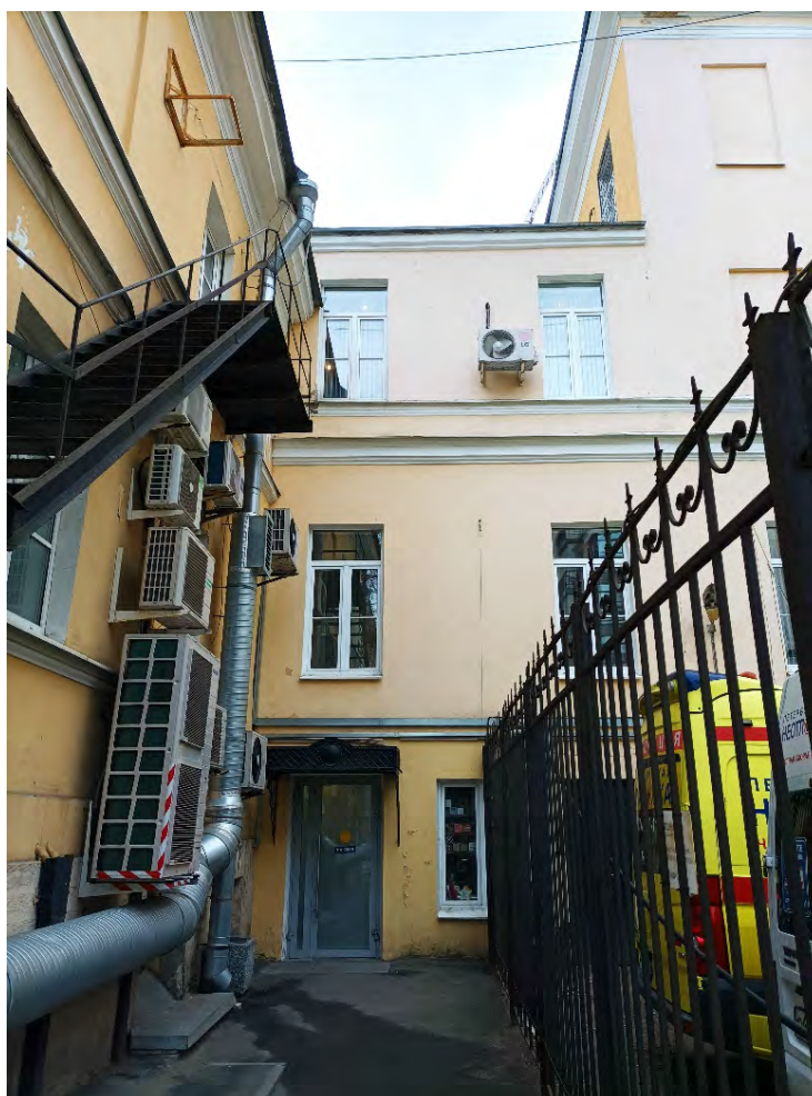
12. Объект культурного наследия регионального значения «9-я солдатская казарма», по адресу: Санкт-Петербург, ул. Радищева, д.39, литера А. Фрагмент дворового фасада. Дата съемки: 29.03.2022г.
