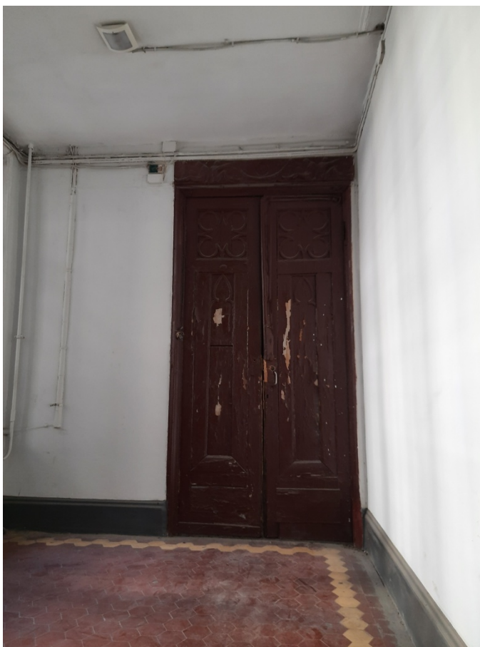
Фото 14 Интерьер выявленного объекта культурного наследия «Доходный дом сельскохозяйственного товарищества "Помещик» расположенного по адресу: г. Санкт-Петербург, Измайловский проспект, дом 16/30, лит. А (Измайловский пр-кт., 16; ул.7-я Красноармейская, 30), входная дверь со стороны парадной
