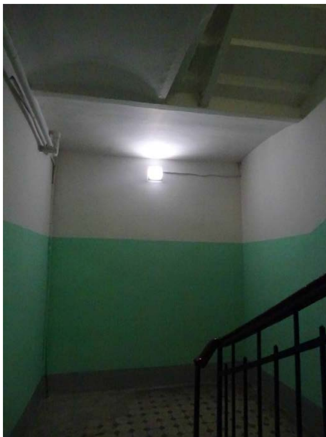
Фото 3. Вид на площадку между 1-м и 2-м этажом. Съемка 19.04.2021 г. Штиглиц М. С.
