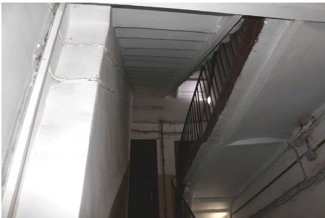
Фото 5. Вид на площадку между 1-м и 2-м этажом. Съёмка 19.04.2021 г. Штиглиц М. С.
