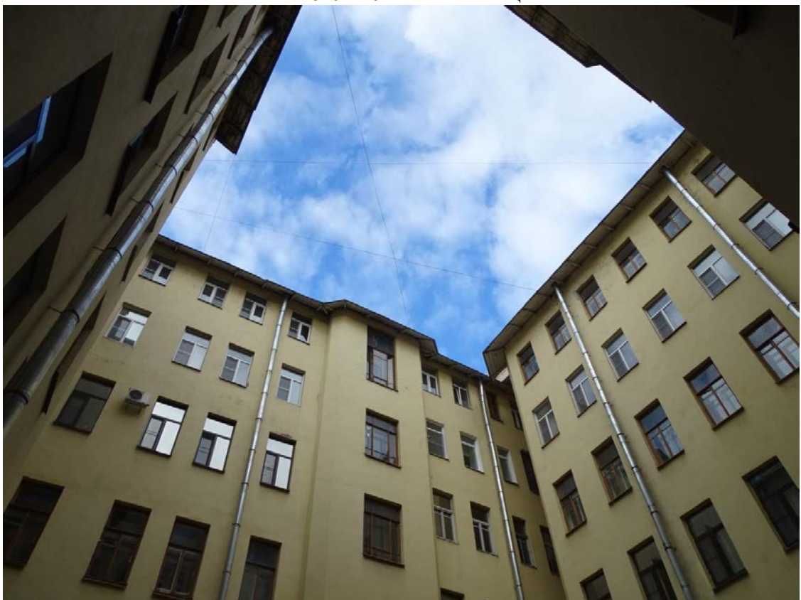
Фото 37. Здание по адресу: Большой проспект П.С., дом 69. Южный внутренний двор. Фрагмент фасада. Съемка 19.04.2021 г. Штиглиц М. С.
