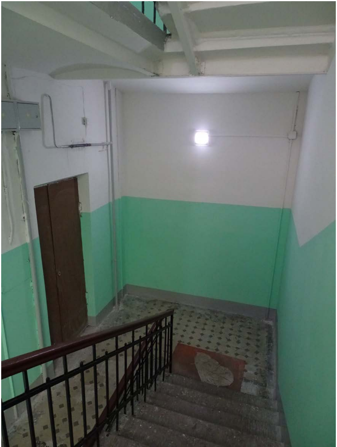
Фото 12. Вид на площадку между 3-м и 4-м этажом. Съемка 19.04.2021 г. Штиглиц М. С.
