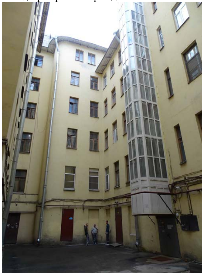
Фото 47. Здание по адресу: Большой проспект П.С., дом 69. Западный внутренний двор. Фрагмент фасада. Съемка 19.04.2021 г. Штиглиц М. С.
