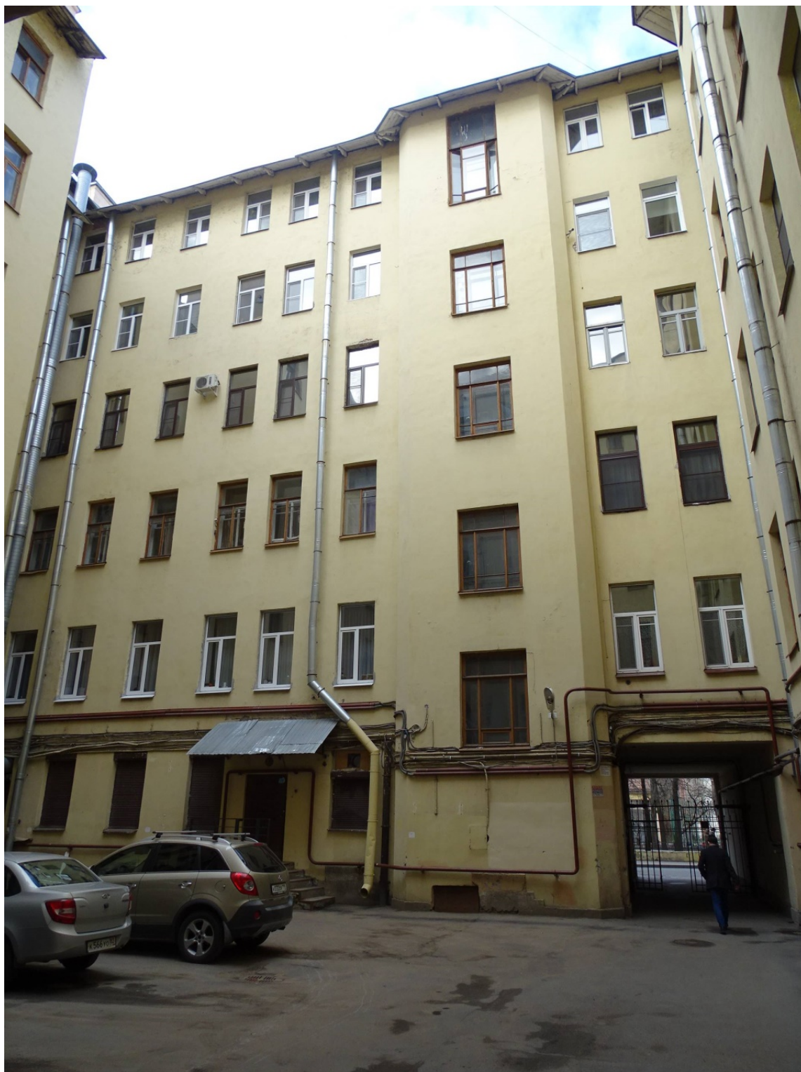
Фото 35. Здание по адресу: Большой проспект П.С., дом 69. Южный внутренний двор. Фрагмент фасада. Съемка 19.04.2021 г. Штиглиц М. С.
