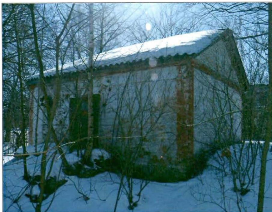
18. Санкт-Петербург, г. Кронштадт, Кронштадтское шоссе, д. 30, лит. К. Общий вид с севера.
