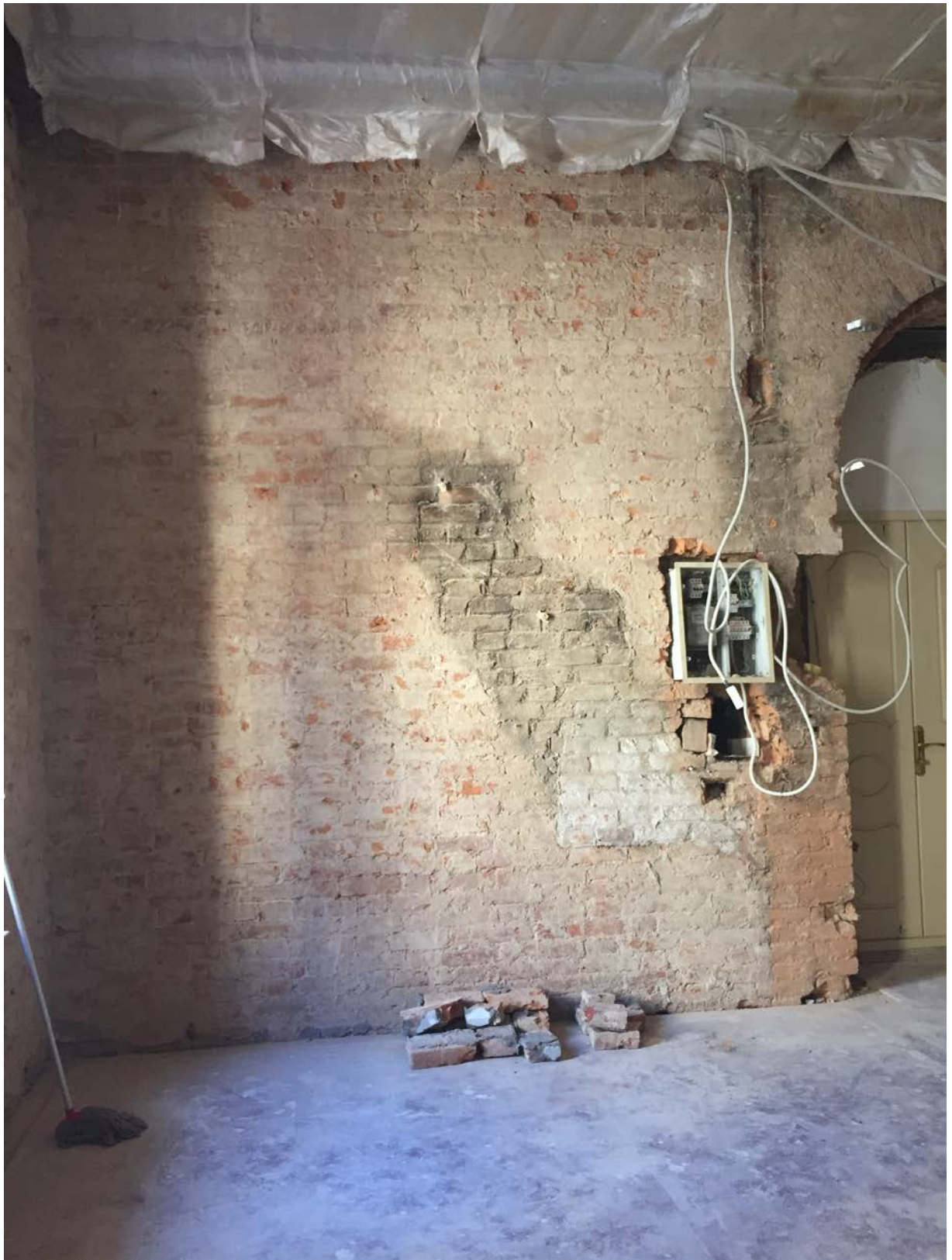
Фото 20. Объект культурного наследия регионального значения «Дом А.Б. Фитингофа». Интерьер пом. №1. Вид на юг. Дата съемки 29.06.2022
