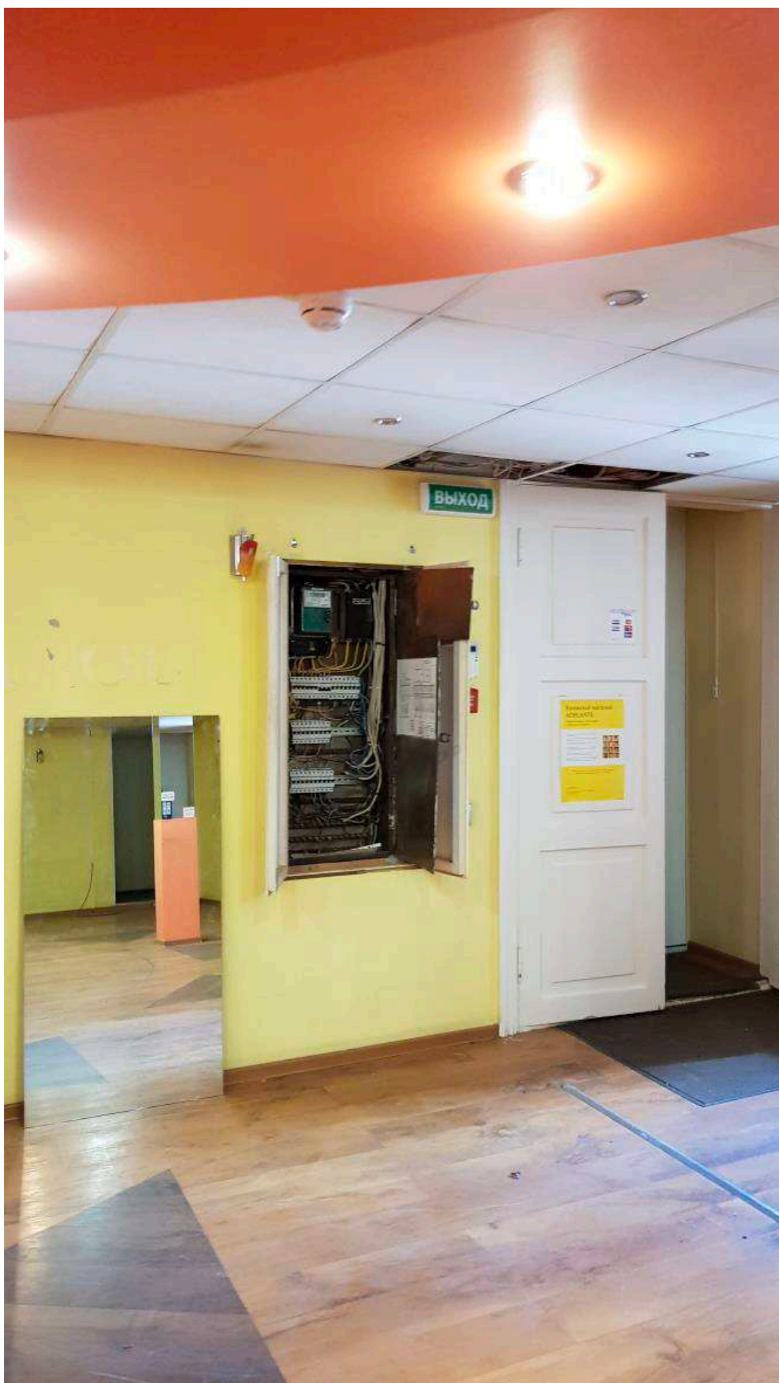
Фото 1. Общий вид части пом. 26-Н (№ 1 по ПИБ). Помещение холла, входной тамбур, ГРЩ.
