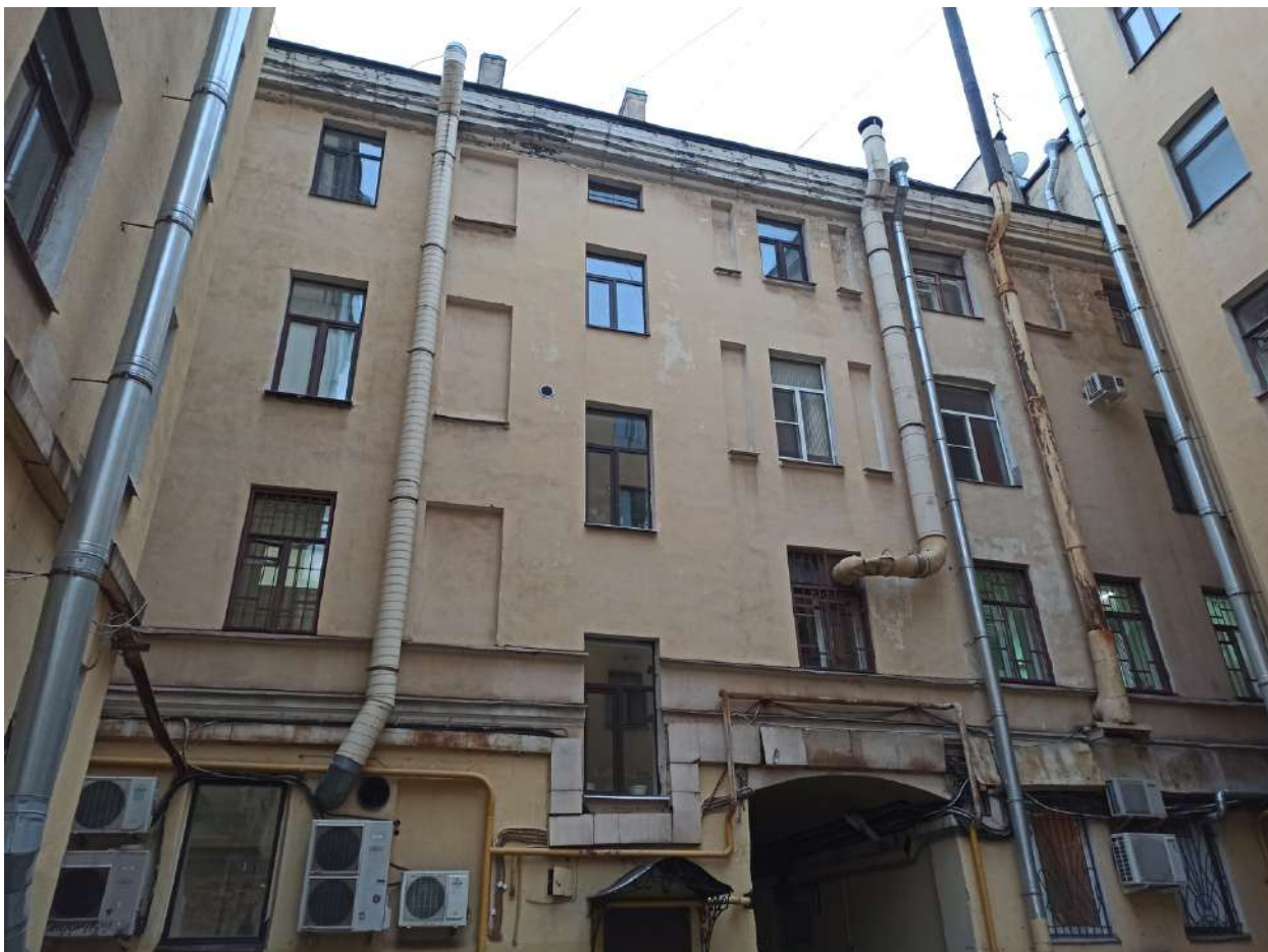
Фото 7. Вид на часть дворового фасада, наблюдается установка дополнительного оборудования, замена оконных заполнений.
