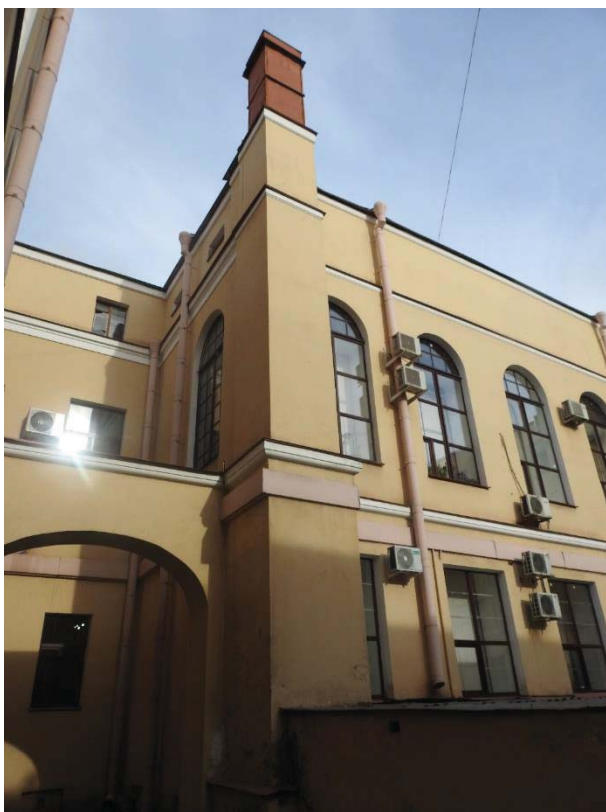
18. «Особняк Дурново П.П., ХУІІІ в.;1872, арх. Фонтана Л.Ф.», Английская наб., д.16, Галерная ул., д.15. Фрагмент левой части Северного фасада с поздней трубой, подлежащей демонтажу. Фото 06.09.2021г.
