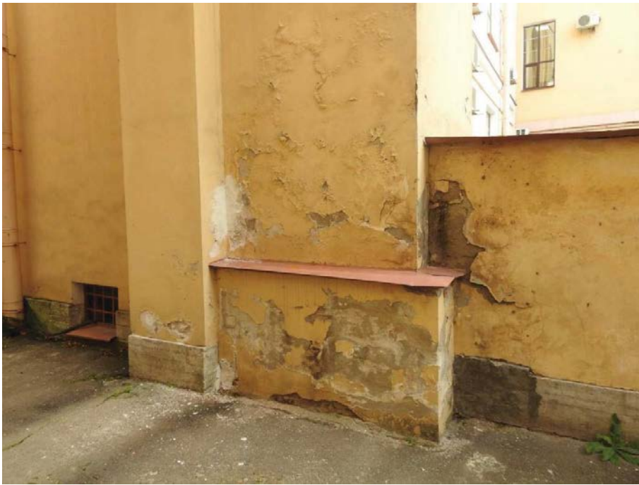
21. «Особняк Дурново П.П., ХУІІІ в.;1872, арх. Фонтана Л.Ф.», Английская наб., д.16, Галерная ул., д.15. Фрагмент цокольной части поздней трубы, подлежащей демонтажу. Фото 06.09.2021г.
