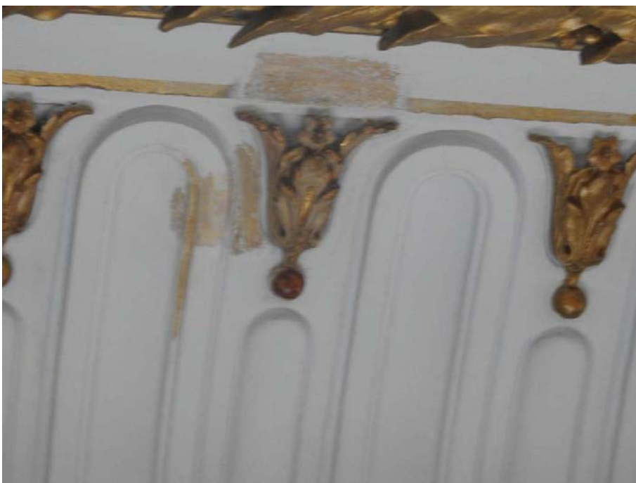
40. «Особняк Дурново П.П., ХУІІІ в.;1872, арх. Фонтана Л.Ф.», Английская наб., д.16, Галерная ул., д.15. Фрагмент падуи южной части потолка с расчистками на предмет выявления позолоты. Фото 06.09.2021г.
