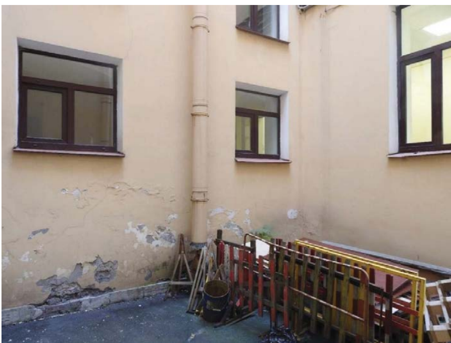
8. «Особняк Дурново П.П., ХУІІІ в.;1872, арх. Фонтана Л.Ф.», Английская наб., д.16, Галерная ул., д.15. Фрагмент дворового фасада левая сторона Восточного флигеля. Заложенные оконные заполнения в уровне цоколя. Фото 06.09.2021г.
