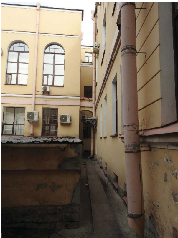
3. «Особняк Дурново П.П., ХУІІІ в.;1872, арх. Фонтана Л.Ф.», Английская наб., д.16, Галерная ул., д.15. Фрагмент дворового фасада правая сторона. Северный флигель. Фото 06.09.2021г.
