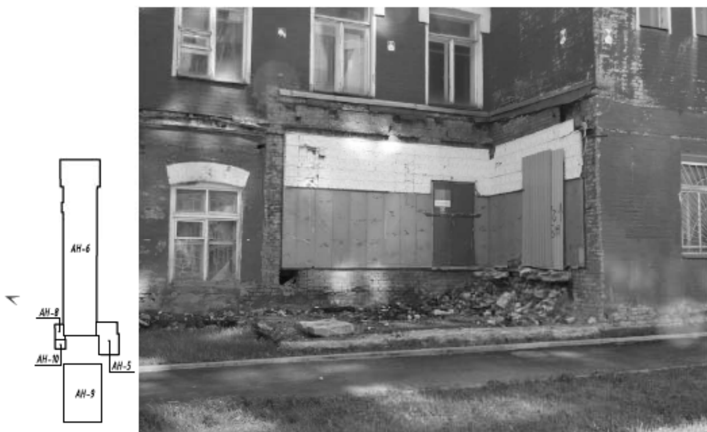
30 Выявленный ОКН «Производственное здание с дымовой трубой Кизлянского Ультрамаринового завода ГИ. Веген», по адресу: г. Санкт-Петербург, Октябрьская набережная, дом 38, литера АН. Литеры АН6 и АН9. Фрагменты интерьера демонтированного объема. Дата съемки: 12.09.2022
