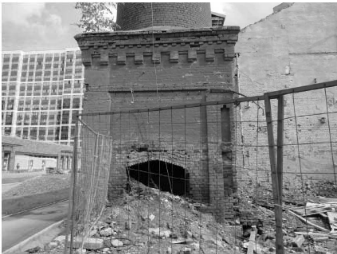
39 Выявленный ОКН «Производственное здание с дымовой трубой Кизовского Ультрамаринового завода ГИ. Веген», по адресу: г. Санкт-Петербург, Октябрьская набережная, дом 38, литера АН. Литера АН10. Технологическое отверстие в цокольной части дымовой трубы от дымового канала. Вид с юго-запада. Дата съемки: 12.09.2022
