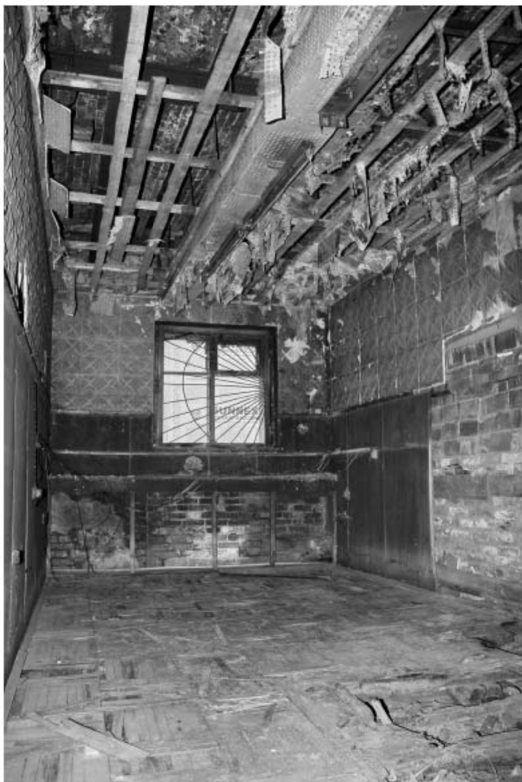
88 Выявленный ОКН «Производственное здание с дымовой трубой Киновиевского Ультрамаринового завода ГИ. Веге», по адресу: г. Санкт-Петербург, Октябрьская набережная, дом 38, литера АН. Лит. АН7. 1 этаж. Помещение 30 (согласно планам ПИБ) Дата съемки: 12.09.2022
