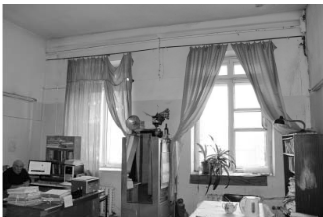
67 Выявленный ОКН «Промышленное здание с дымовой трубой Кинновского Ультрамаринового завода Г.И. Ветов», по адресу: г. Санкт-Петербург, Огтябрьская набережная, дом 38, литера АН. Лит. АН6. 3 этаж. Помещение 18 (согласно плану ПИИ) Дата съёмки: 12.09.2022
