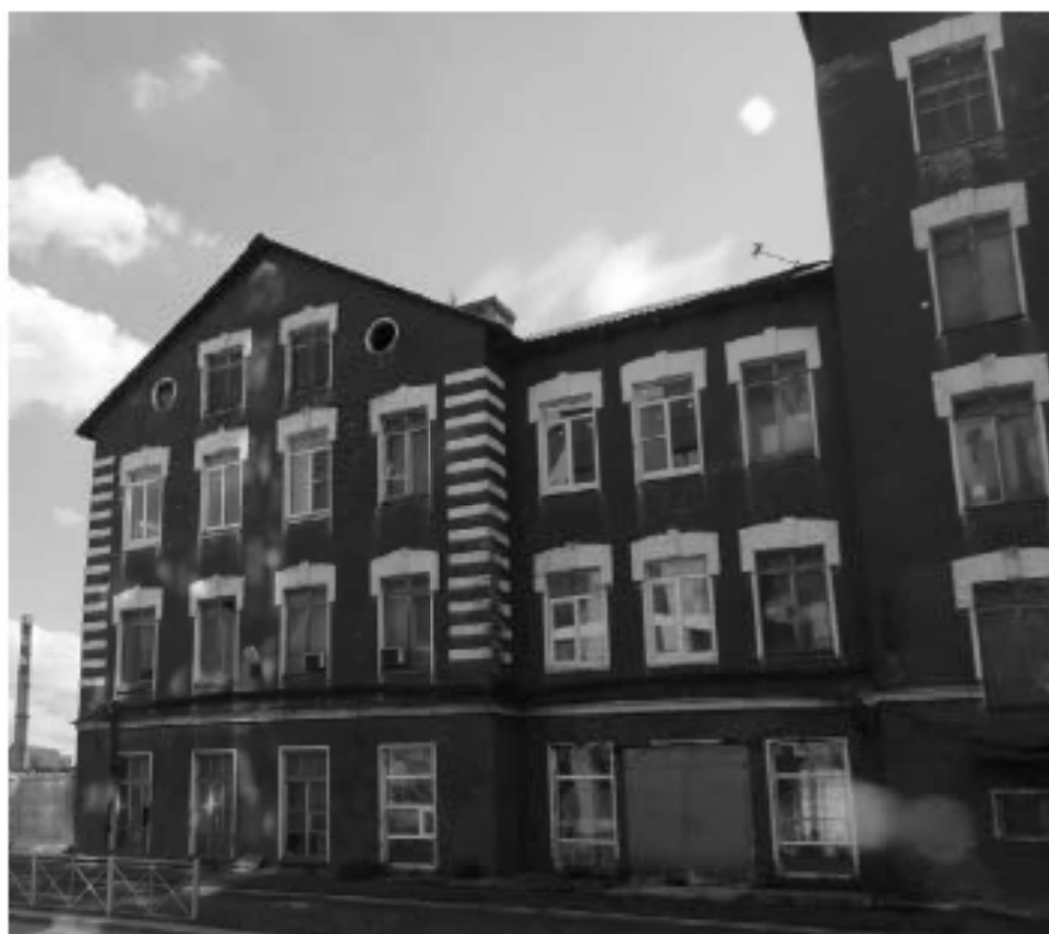
33 Выявленный ОКН «Производственное здание с дымоходной трубой Кисловожского Ультрамаринного завода Г.И. Веген», по адресу: г. Санкт-Петербург, Октябрьская набережная, дом 38, литера АН. Литера АН6. 3-я этажная часть. Вид с запада. Дата съемки: 12.09.2022
