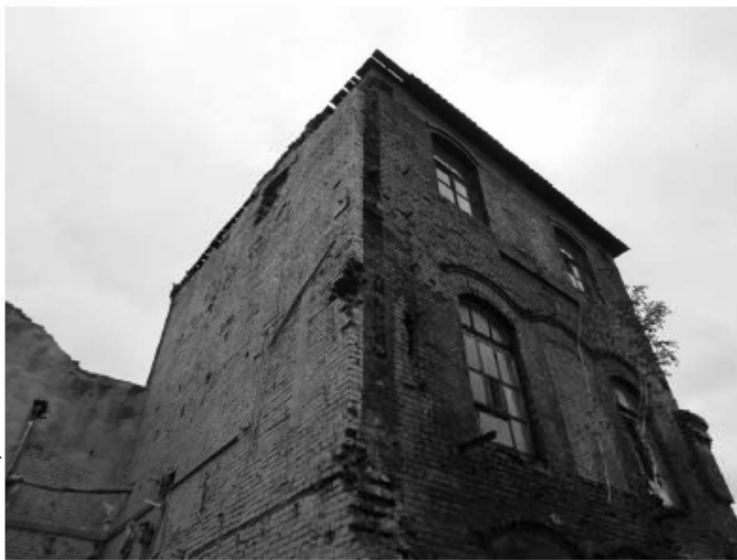
6 Выявленный ОКН «Производственное здание с дымовой трубой Киншасинского Уд.трамфаринного завода Г.И. Вегера», по адресу: г. Санкт-Петербург, Октябрьская набережная, дом 38, литера АН. Литера АН5. Вид с запада. Дата съемки: 12.09.2022
