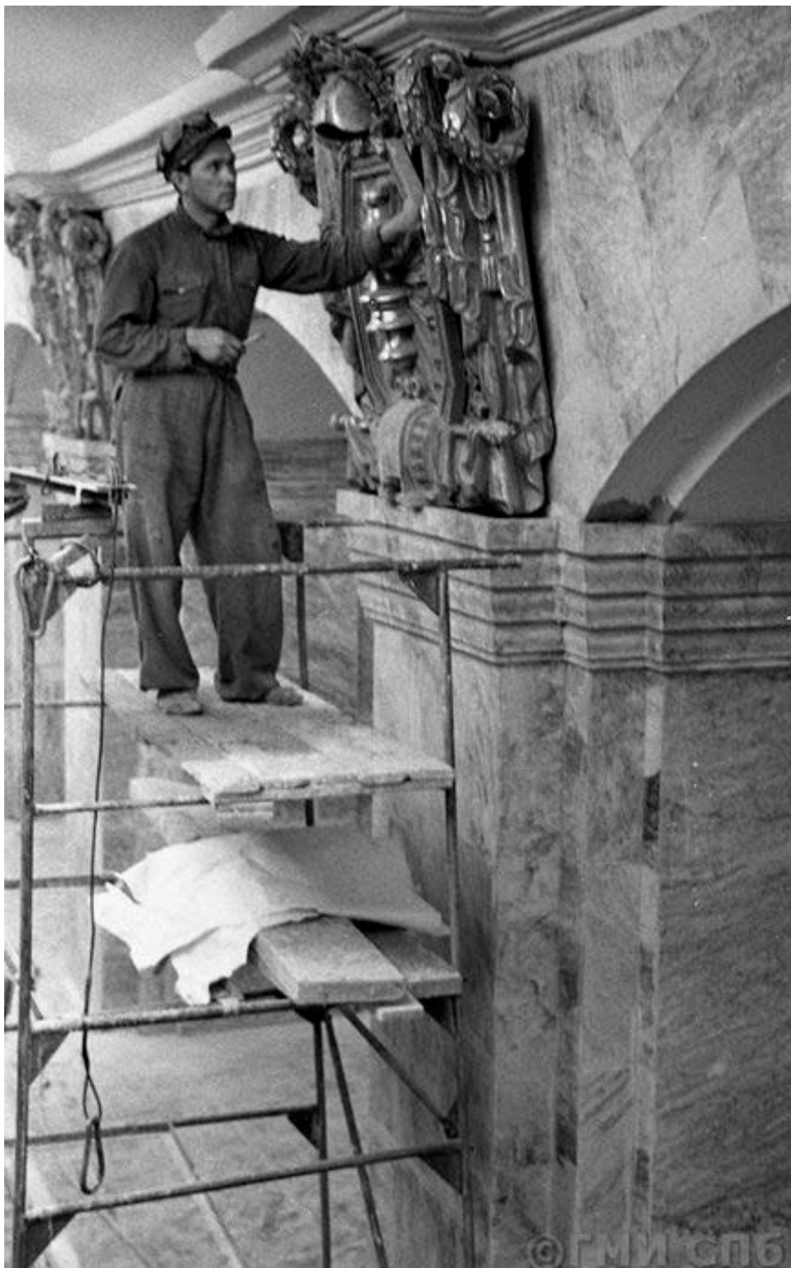
15. Строительство станции метро «Кировский завод». 1955 г. — «PastVu» – ретро-фотографии стран и городов [Электронный ресурс]. URL: https://pastvu.com/p/1205614 .
