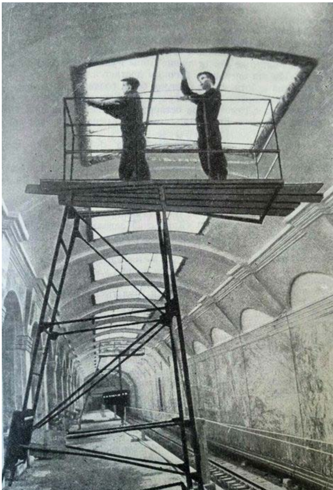
16. Монтаж светильников на станции метро Кировский завод. 1955 г. — «PastVu» – ретро-фотографии стран и городов [Электронный ресурс]. URL: https://pastvu.com/p/842924 .
