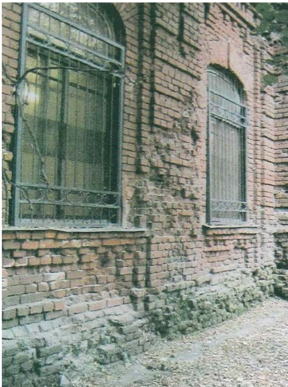
27. Колпино. Бывшая школа Адмиралтейских Ижорских заводов. Участок фасада здания. Фото 2011 года из «Отчёта об обследовании технического состояния материалов отделки фасадов». Центр технического сопровождения «Рубикон». СПб., 2011.
