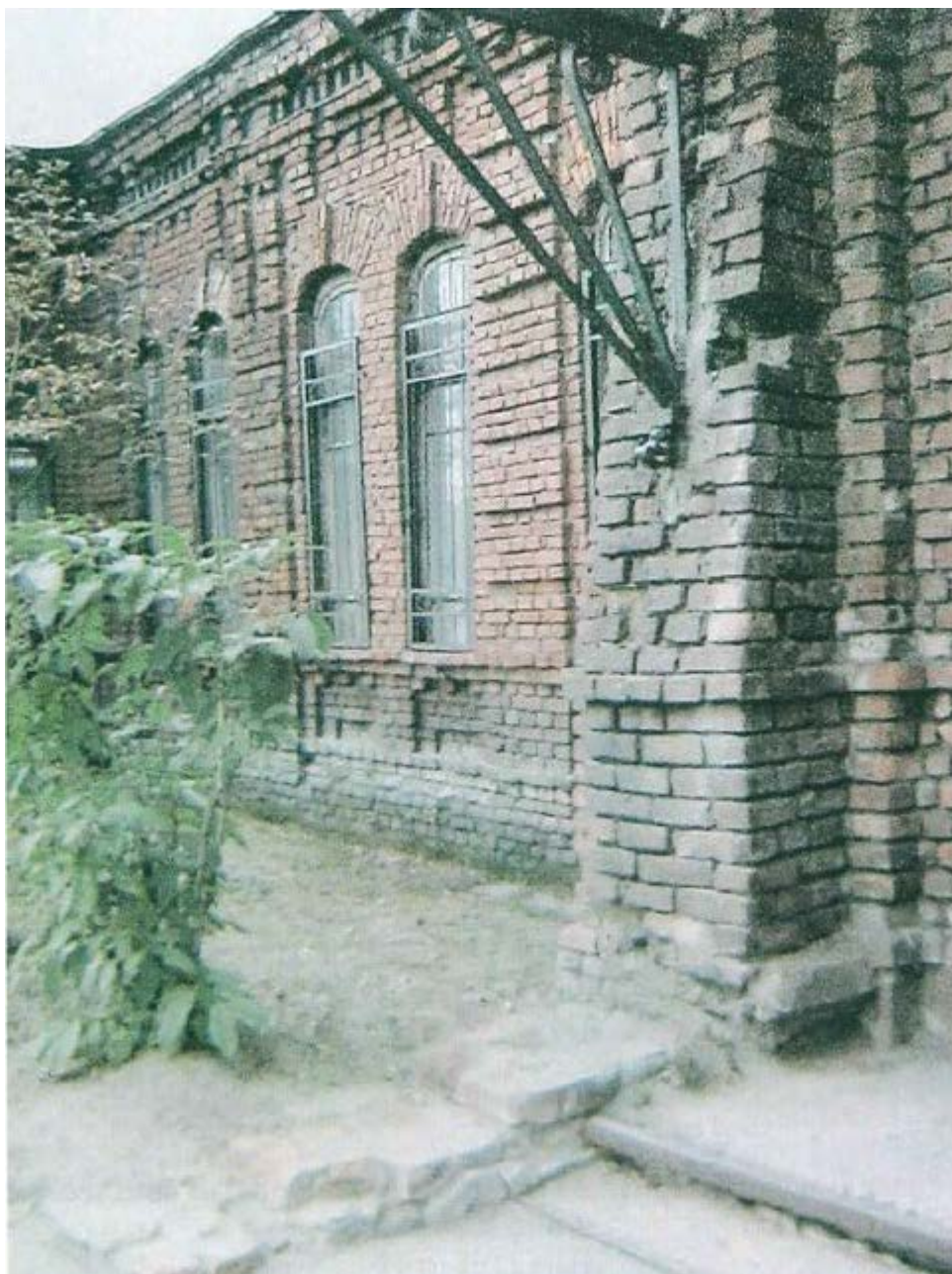
25. Колпино. Бывшая школа Адмиралтейских Ижорских заводов. Фрагмент западного фасада. Фото 2011 года из «Отчёта об обследовании технического состояния материалов отделки фасадов». Центр технического сопровождения «Рубикон». СПб., 2011.
