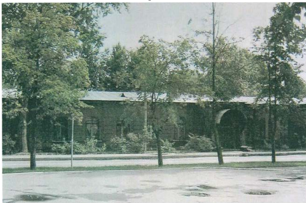
24. Колпино. Бывшая школа Адмиралтейских Ижорских заводов. Западный фасад. Фото 2011 года из «Отчёта об обследовании технического состояния материалов отделки фасадов». Центр технического сопровождения «Рубикон». СПб., 2011.
