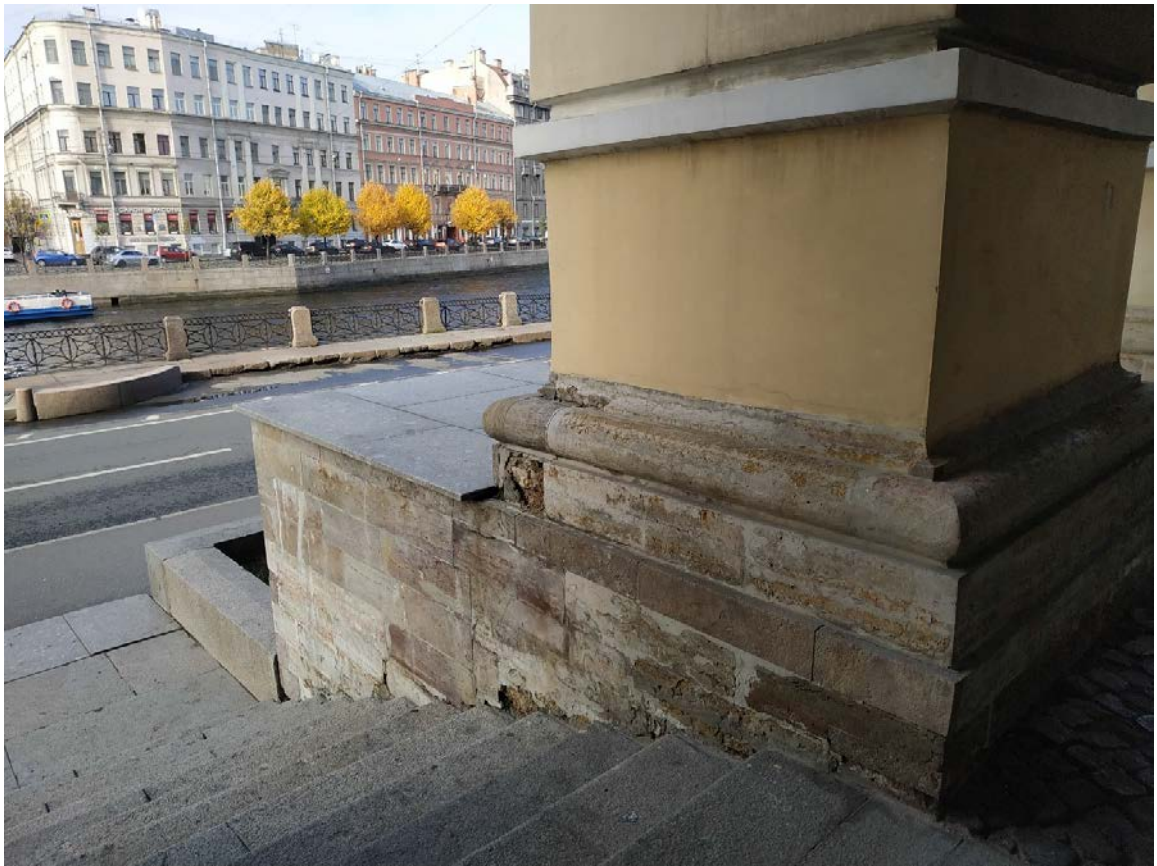
6. Цоколь колоннады портала. Неудовлетворительное состояние известняковой облицовки: локальные утраты, биопоражения поверхности, вызванные намоканием, утрата шовного раствора и деструкция поверхности известняка.
