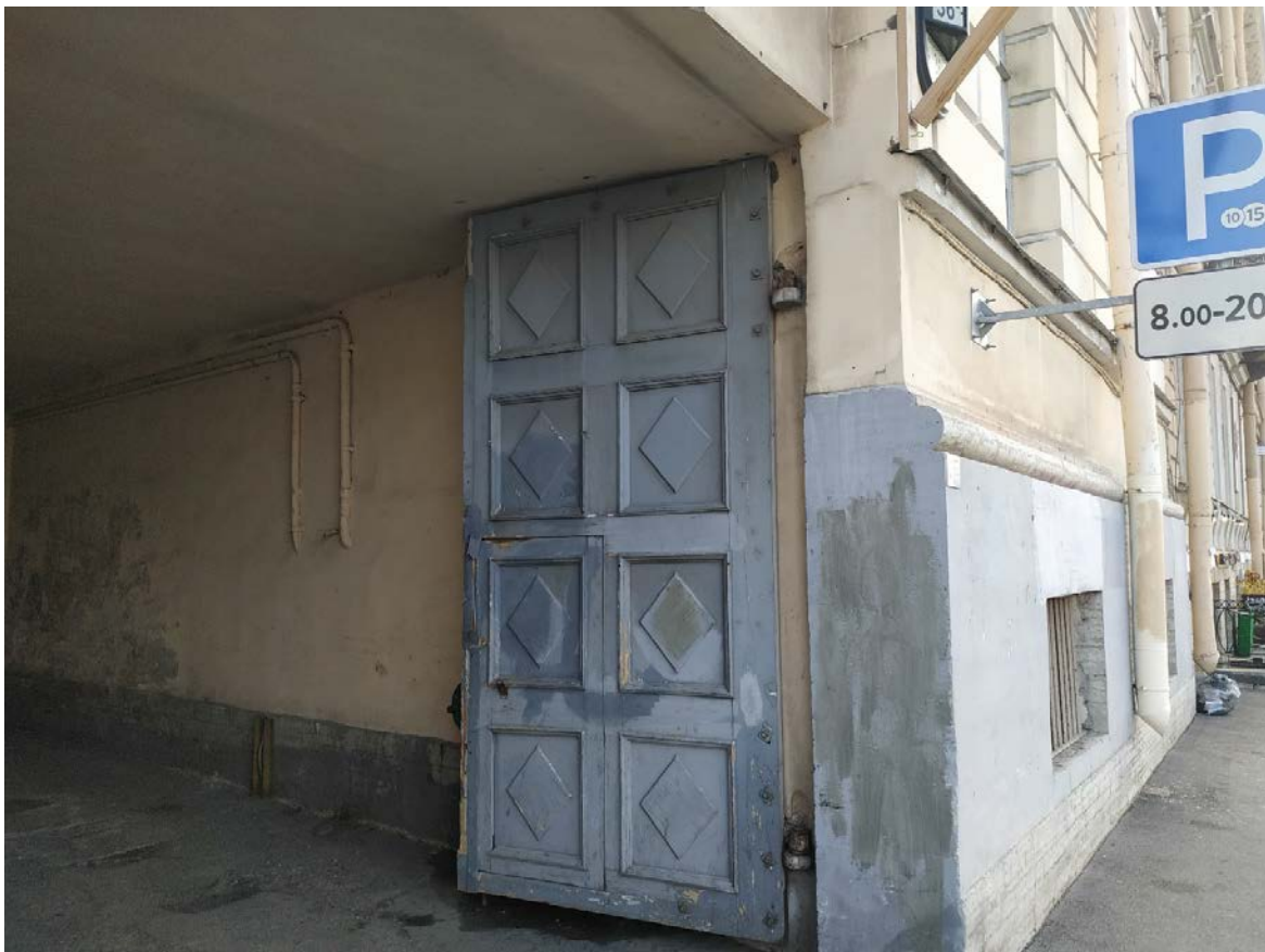
20. Неудовлетворительное состояние деревянного полотна воротного заполнения южного ризалита. Поздние окрасочные слои известняковой облицовки цоколя.
