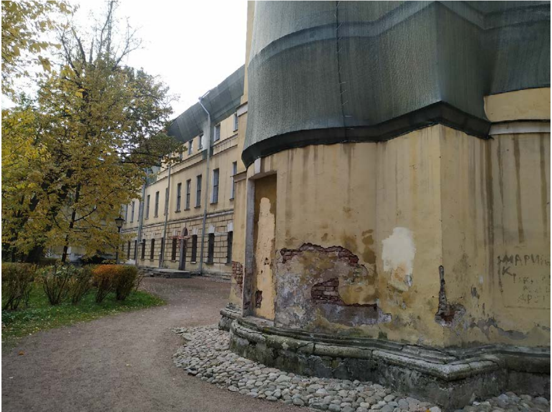
33. Утраты штукатурного слоя, деструкция кирпичной кладки, поздние обмазочные слои известнякового цоколя северного ретирадника.
