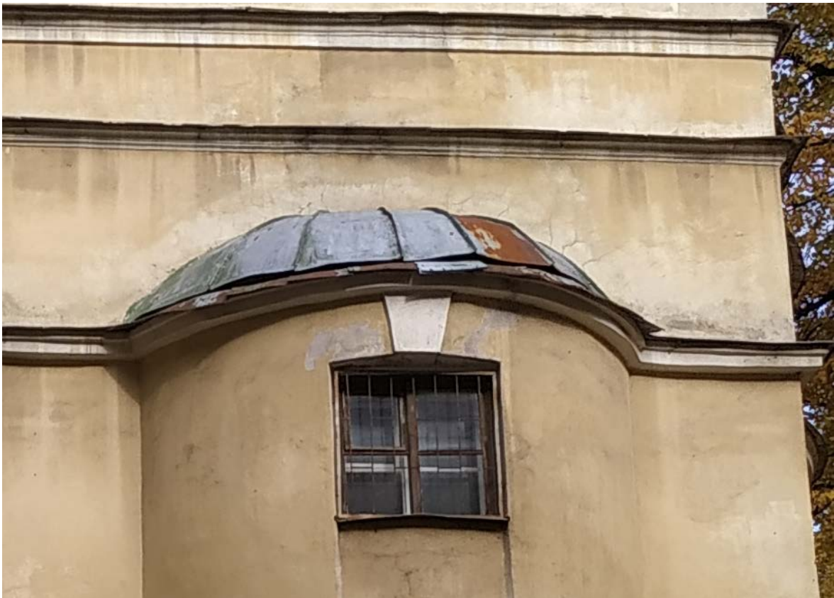
44. Крыша над конхой южного ретирандника: коррозия кровельного покрытия, нарушение геометрии, герметичности примыканий.
