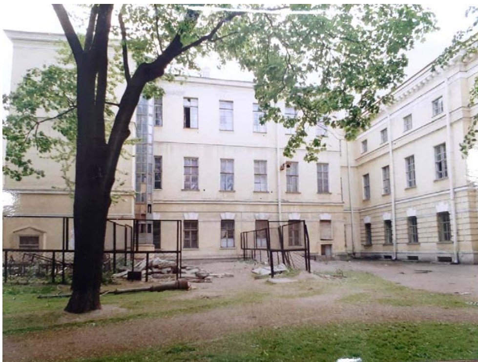
27. Институт Екатерининский. Южный флигель. Северный фасад. Вид из Итальянского сада. // Архив КГИОП. Паспорт. Екатерининский институт. Сост. А.В. Бертани, И.В. Савельева. 2000. П 983-1. №136п. Фото №8. 1999 г. А.К. Дергауз.
