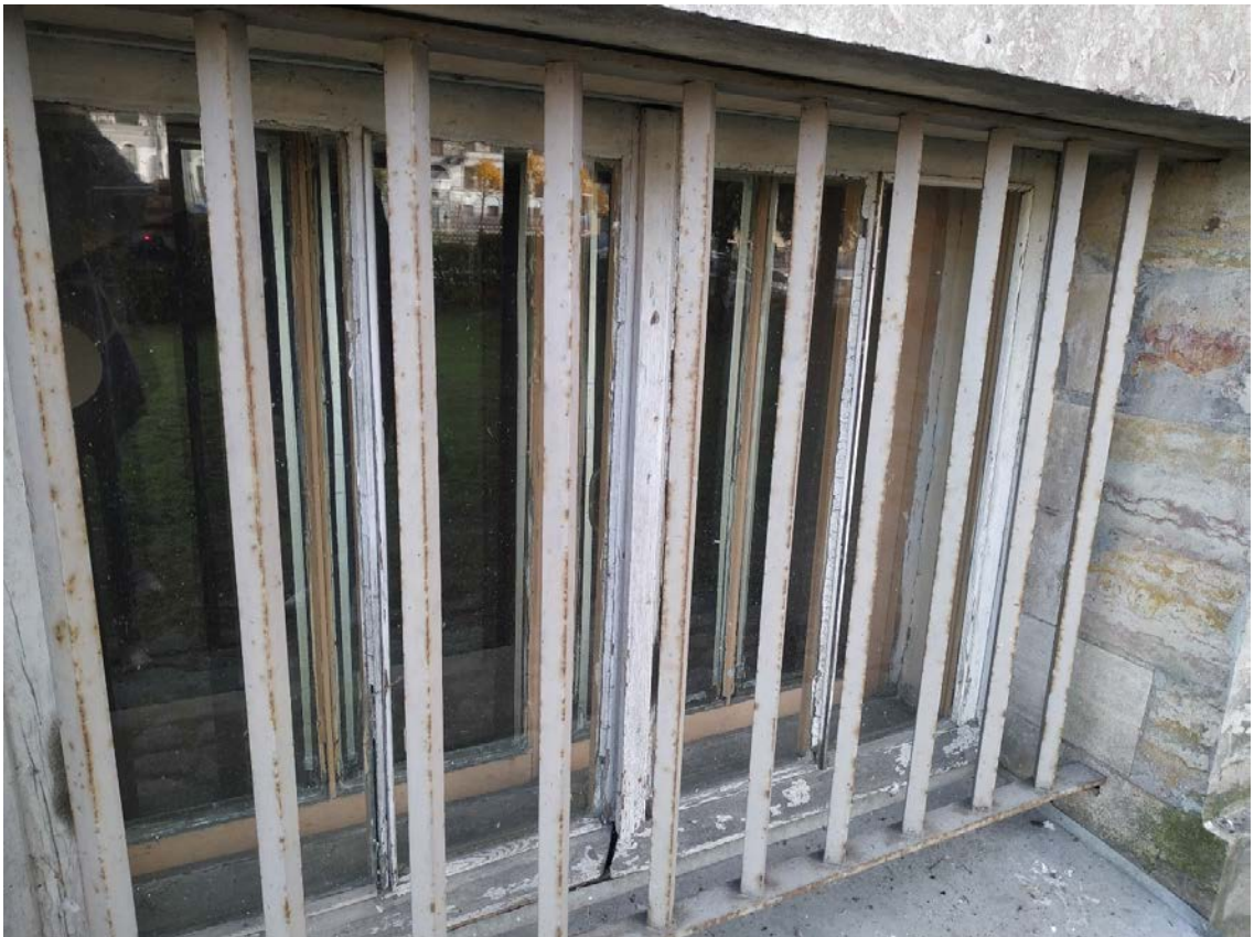
12. Коррозия и локальные утраты окрасочного слоя металлической решетки цокольного этажа.
