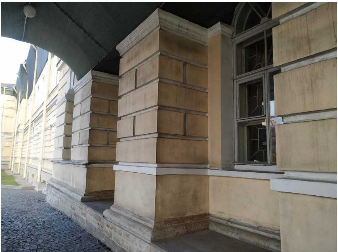
7. Множественные загрязнения, трещины штукатурной поверхности стен.
