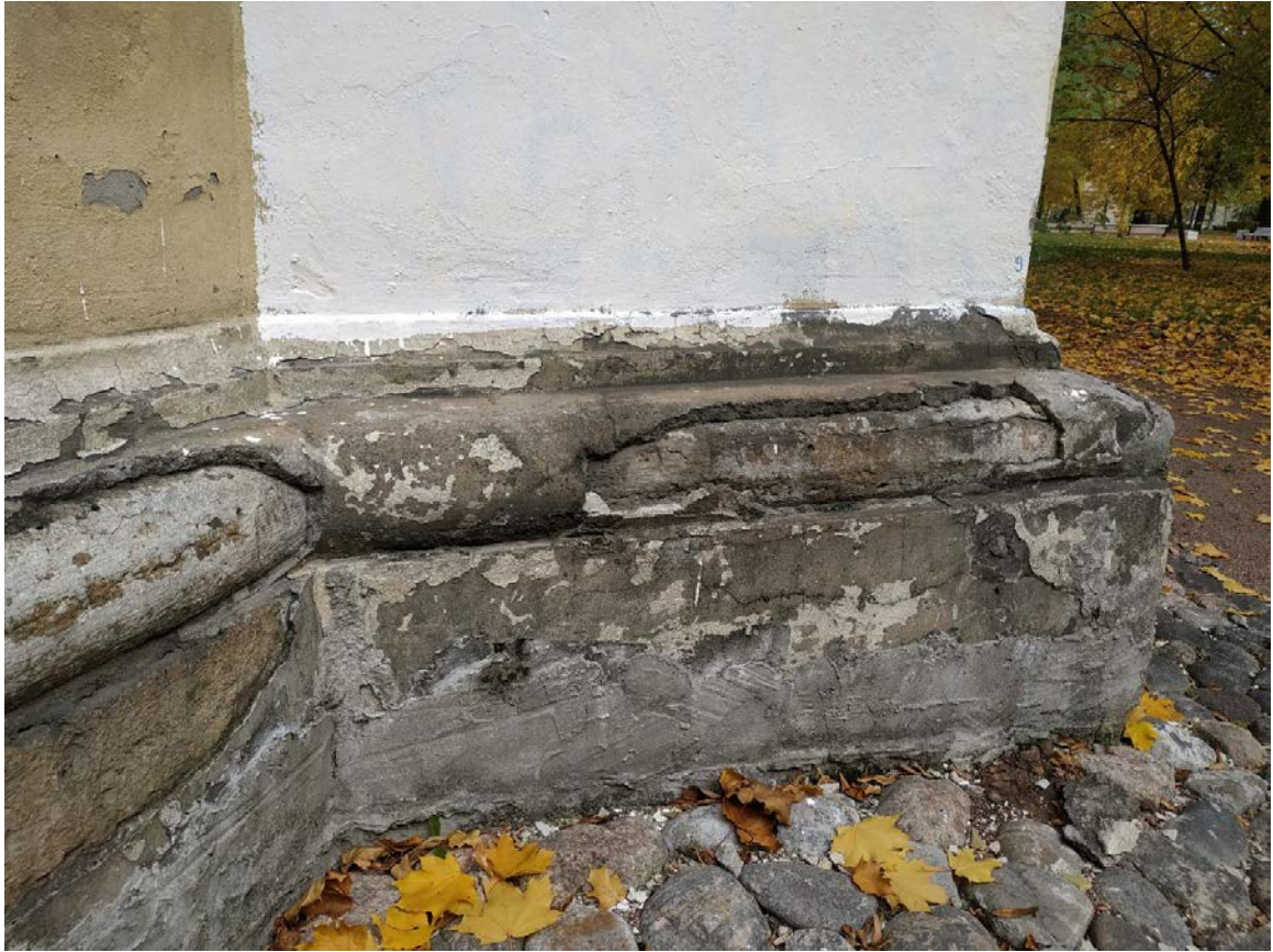
37. Неудовлетворительное состояние цоколя южного ретирадника.
