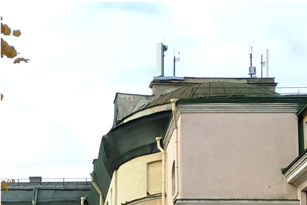
43. Крыша над апсидой церкви: неудовлетворительное состояние кровельного покрытия, утраты красочного и штукатурного слоя аттиковой стенки.
