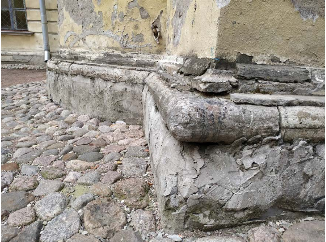
34. Следы поздних ремонтов на цоколе северного ретирадника. Фрагментарные утраты облицовки.
