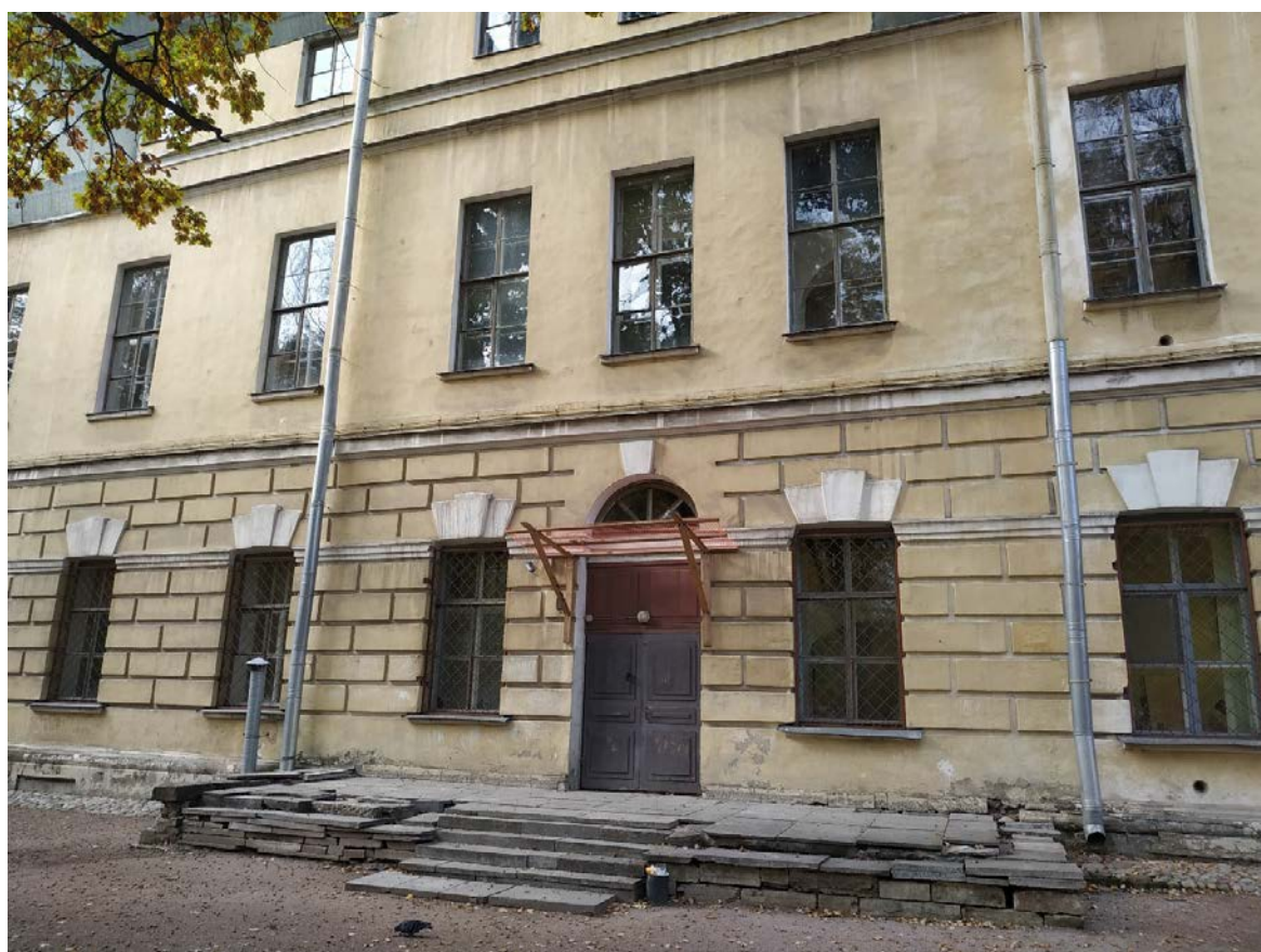
32. Неудовлетворительное состояние крыльца восточного фасада.
