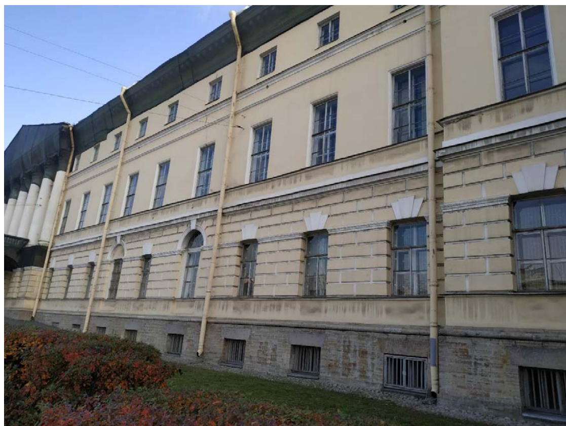
2. Фрагмент лицевого фасада. Множественные загрязнения поверхности фасада атмосферными осадками.
