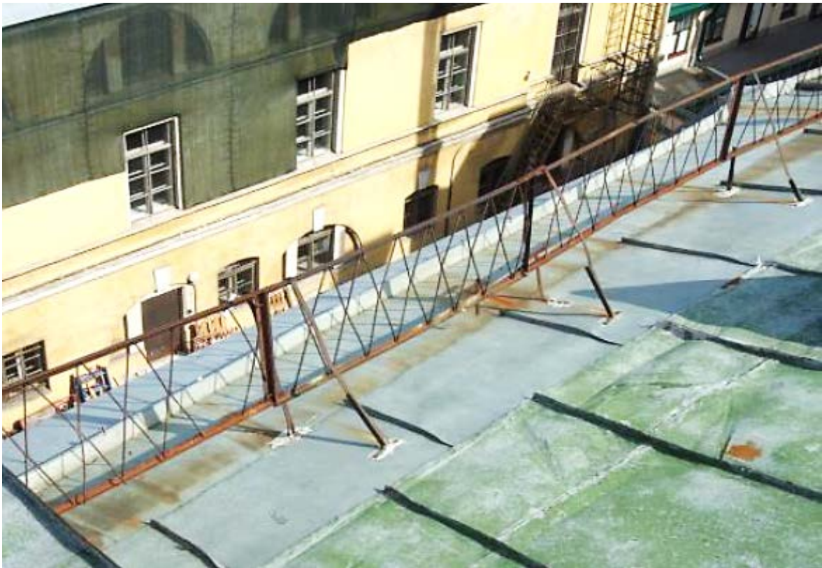
46. Неудовлетворительное состояние ограждения кровли над дворовым (церковным) флигелем.
