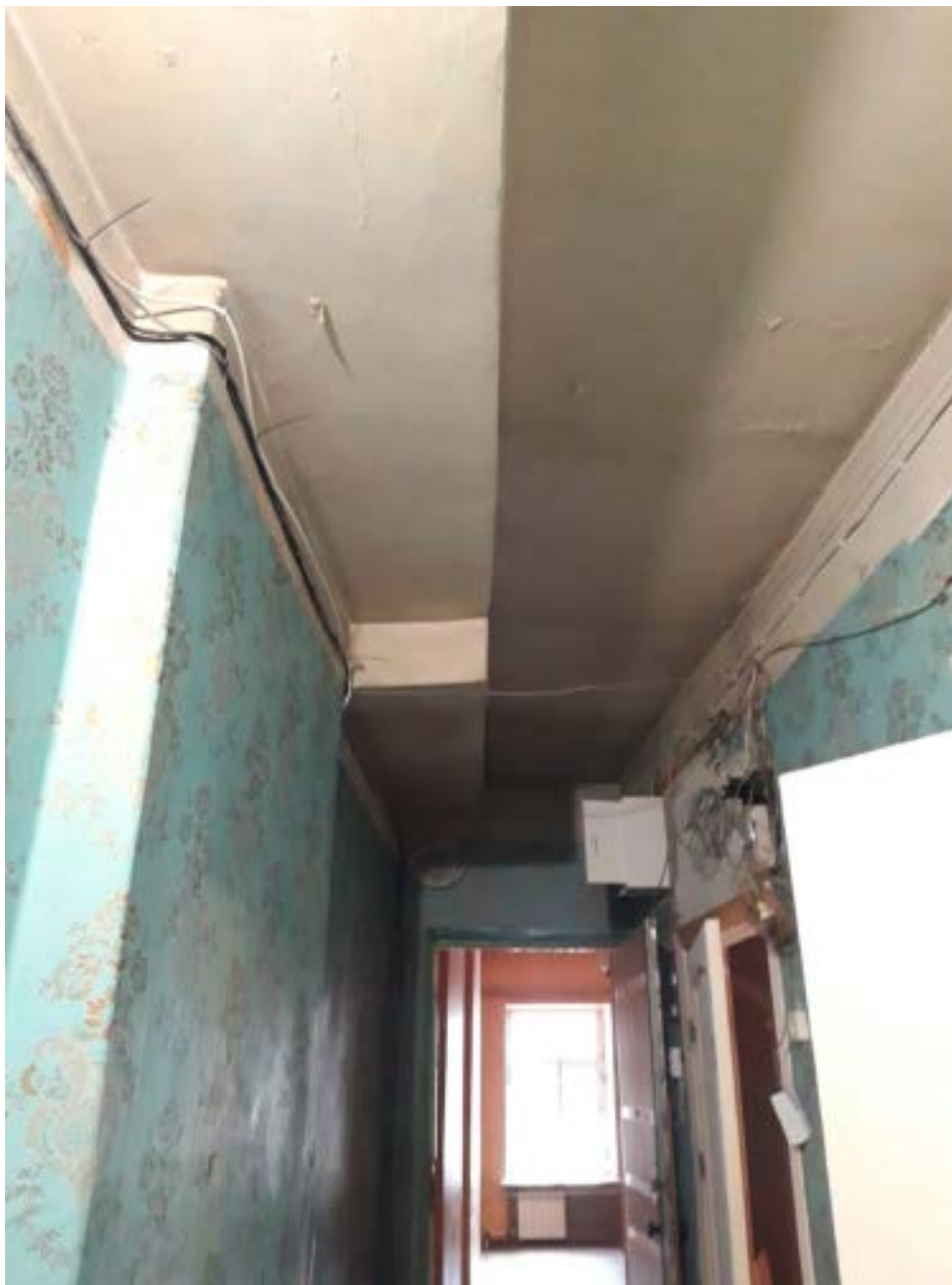
4. Помещение №1 (коридор) кв. №10 в уровне 5-го этажа объекта культурного наследия регионального значения «Дом П.Д. Мальцова», расположенного по адресу: г. Санкт-Петербург, Пушкинская ул., д. 2/79, литера А. 01.06.2021.
