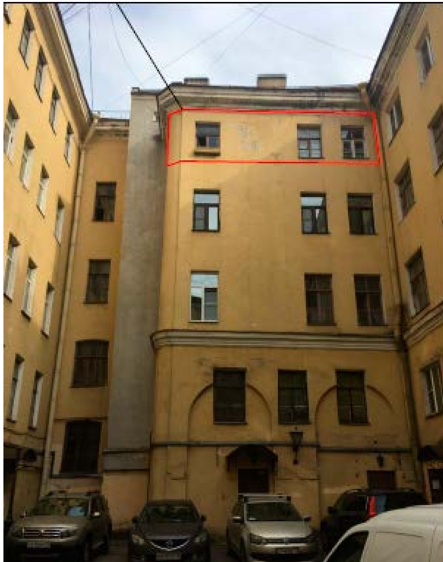
1. Оконные заполнения кв. №10 в уровне 5-го этажа дворового фасада объекта культурного наследия регионального значения «Дом П.Д. Мальцова», расположенного по адресу: г. Санкт-Петербург, Пушкинская ул., д. 2/79, литера А. 01.06.2021
