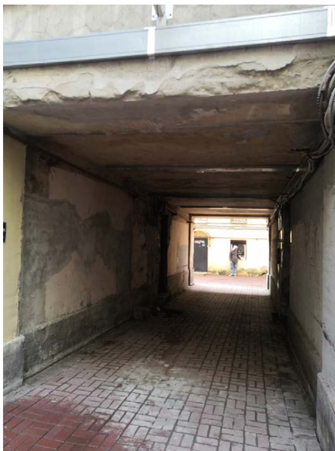
32. Воротный проезд, со стороны дворового фасада, с плоским перекрытием, ведущий к трехэтажному флигелю
