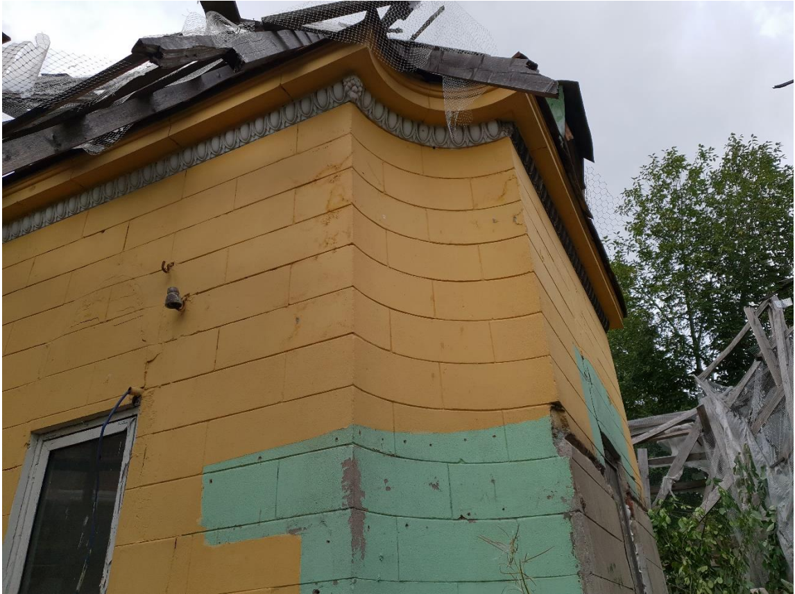
Фото 8. Фрагмент фасада с «обратным» скругленным углом в пересечении бетонных стен 20.09.2022 г.
