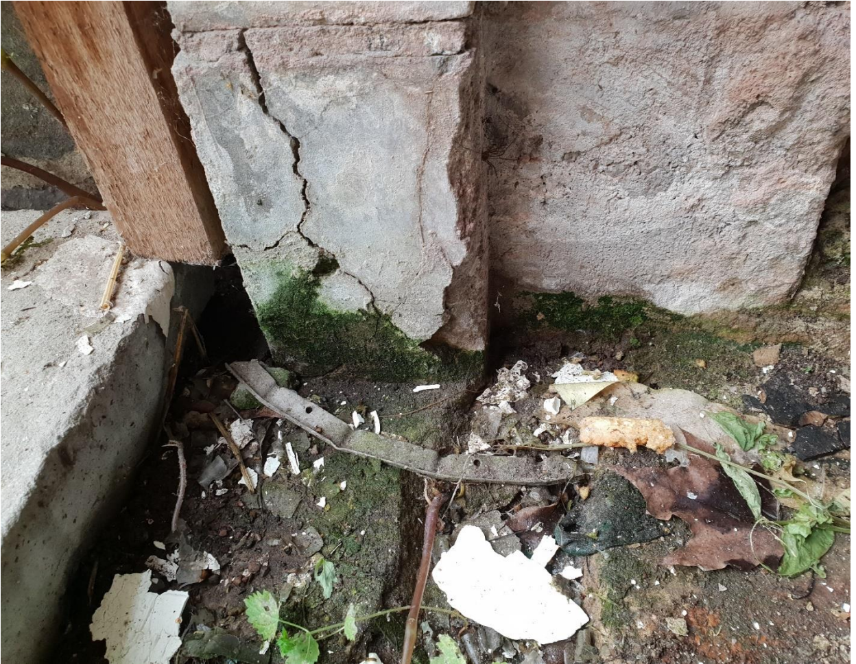
Фото 16. Фрагмент откоса дверного проема северо-западного фасада. 20.09.2022 г.
