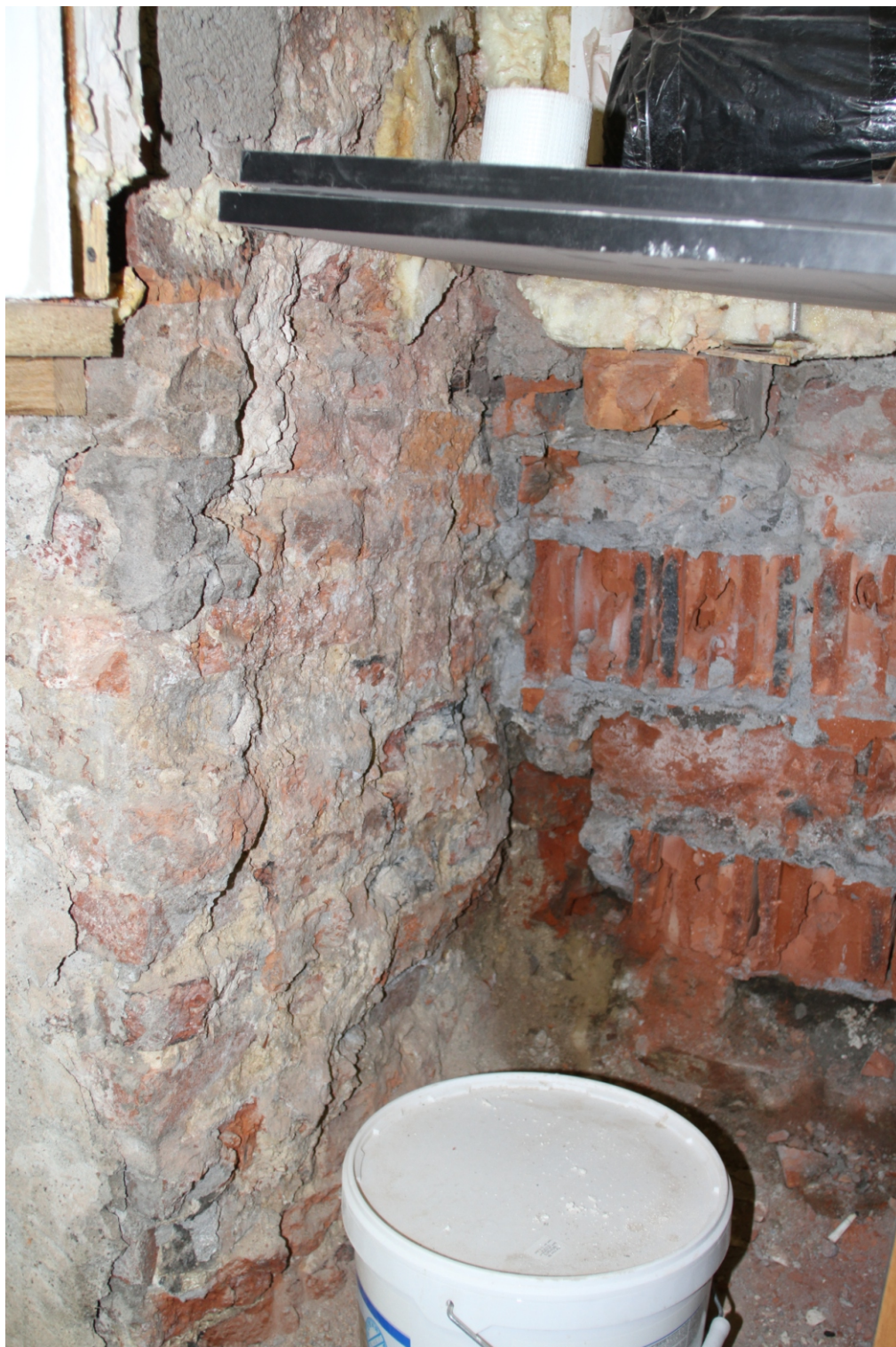
14. “Дом с флигелями семьи Брюлловых”. Средний пр. В.О., д.17, литера А (Средний пр., д.17) Фрагмент интерьера. Оконный проем на месте исторического дверного. Следы поздней закладки и перебивки. Фото: 01.11.2022.
