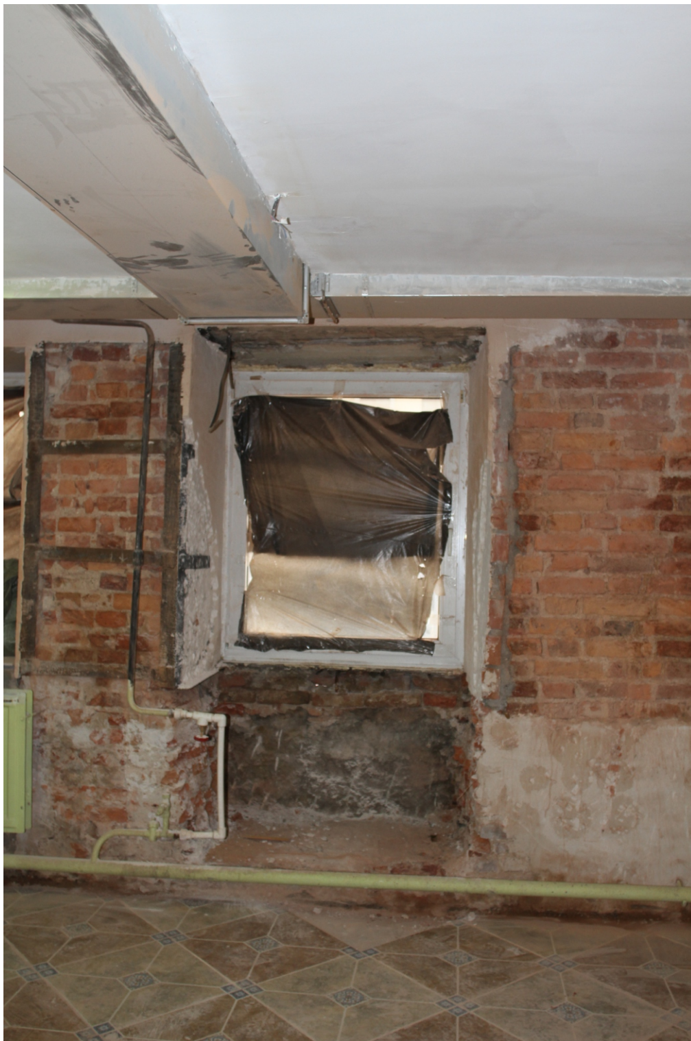
19. “Дом с флигелями семьи Брюлловых”. Средний пр. В.О., д.17, литера А (Средний пр., д.17) Фрагмент интерьера. Оконный проем на месте исторического дверного проема. Фото: 01.11.2022.
